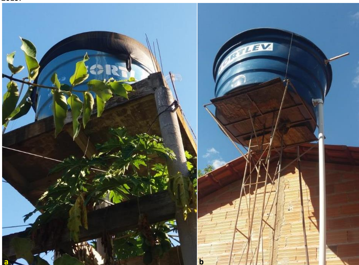
Foto 6.3 – Reservatório coberto com material improvisado, uma espécie de sombrite (a), e reservatório tampado e amarrado com arame (b), Comunidade Rafael Machado, Niquelândia-GO, 2019.
