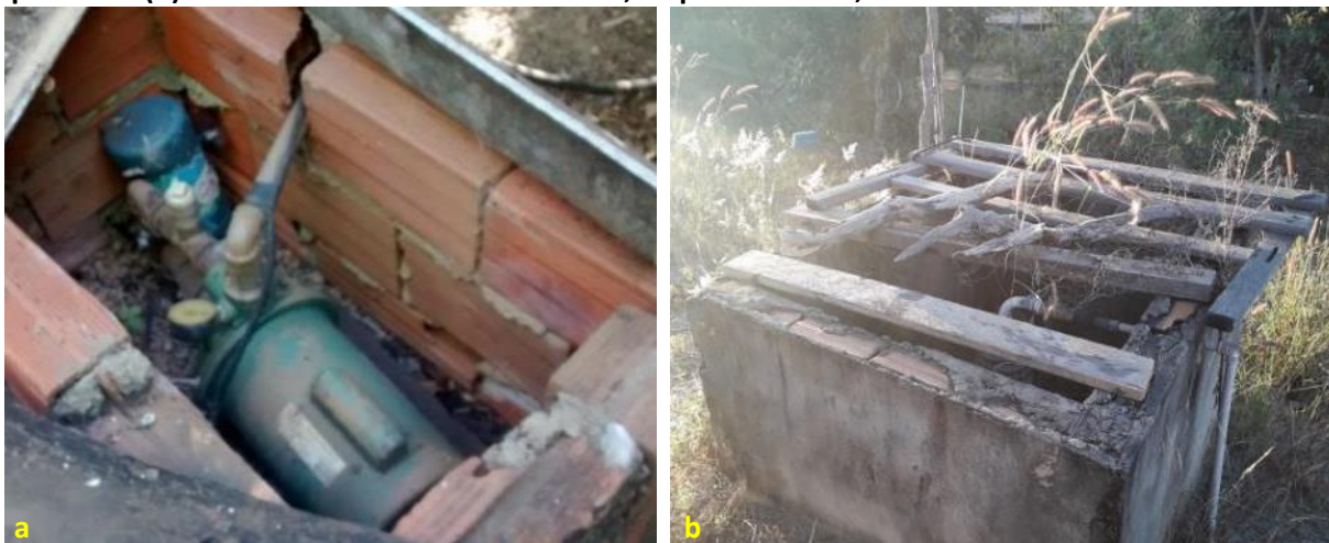
Foto 6.1 – Diferentes fontes de abastecimento de água: poço tubular raso (a) e poço tubular profundo (b) na Comunidade Rafael Machado, Niquelândia-GO, 2019.
