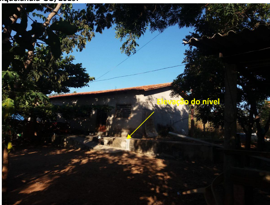
Foto 6.22 – Dispositivos de prevenção dos danos provocados pelas águas, na Comunidade Rafael Machado, Niquelândia-GO, 2019.
