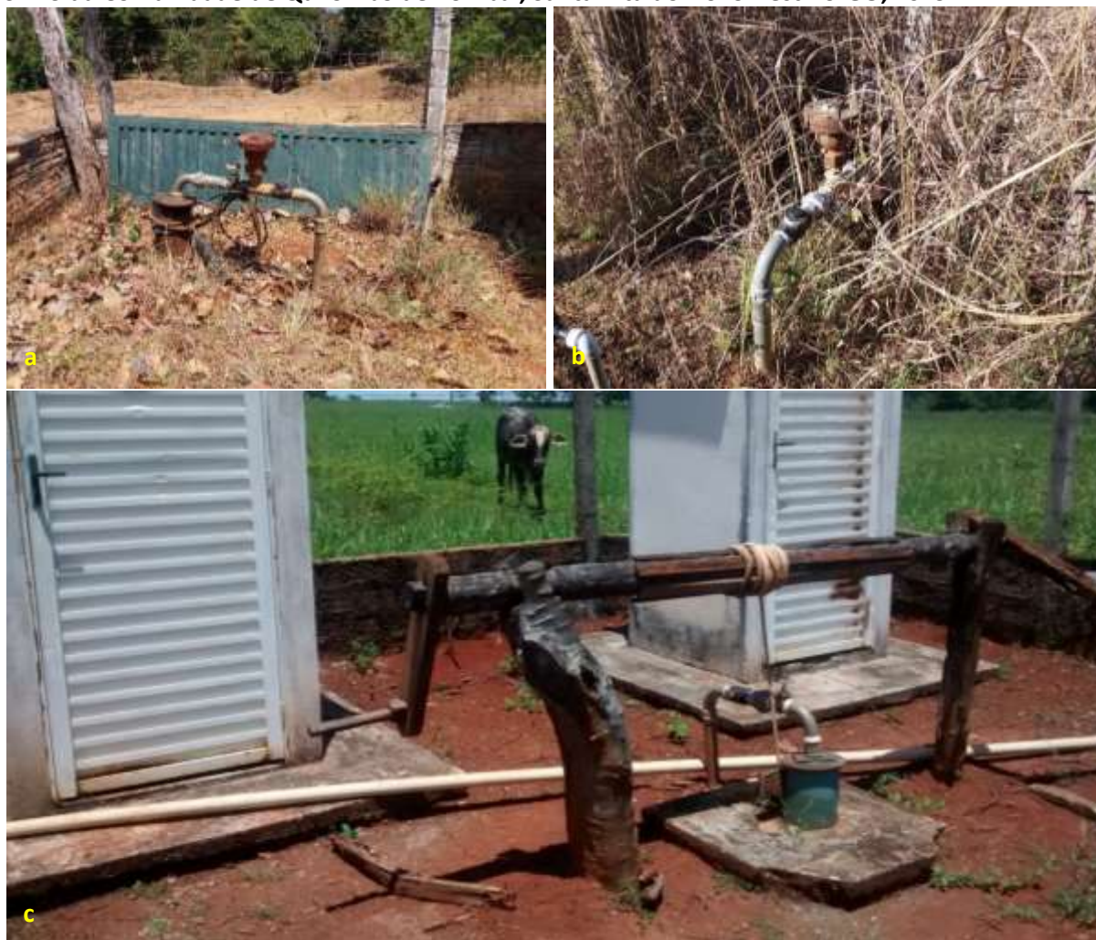
Foto 6.3 – Poços tubulares profundos, F1 (a), F2 (b) e F3 (c), respectivamente, fontes SSA1, SAA2 e SAA3 da Comunidade de Quilombo de Pombal, Santa Rita do Novo Destino-GO, 2019.
