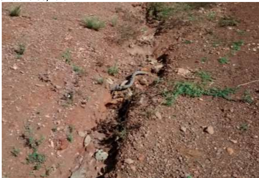
Foto 6.23 – Processo erosivo próximo à via de acesso na Comunidade de Quilombo de Pombal, Santa Rita do Novo Destino-GO, 2019.
