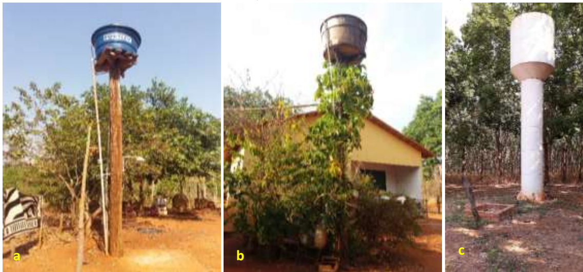
Foto 6.11 – Reservatório de polietileno (a) e reservatório de fibrocimento (b) sobre estruturas de madeira e de alvenarias, respectivamente, e reservatório tipo taça construído em material metálico (c) na Comunidade de Quilombo de Pombal, Santa Rita do Novo Destino-GO, 2019.
