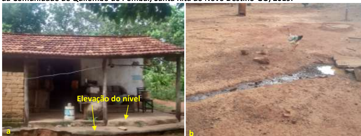
Foto 6.27 – Dispositivos de prevenção dos danos provocados pelas águas em residência (a) e lote (b) da Comunidade de Quilombo de Pombal, Santa Rita do Novo Destino-GO, 2019.
