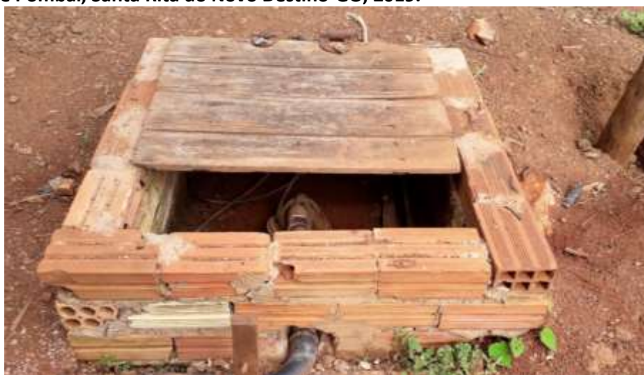
Foto 6.8 – Poço tubular profundo protegido por alvenaria e tampa de madeira na Comunidade de Quilombo de Pombal, Santa Rita do Novo Destino-GO, 2019.
