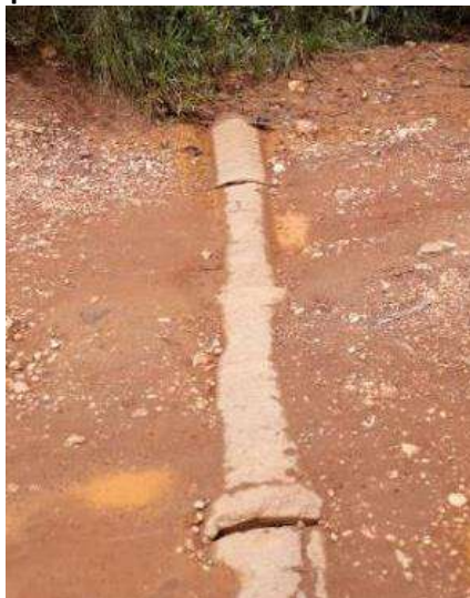
Foto 6.21 – Situação da drenagem pluvial: bueiro na Comunidade Povoadado Moinho, Alto Paraíso-GO, 2019.
