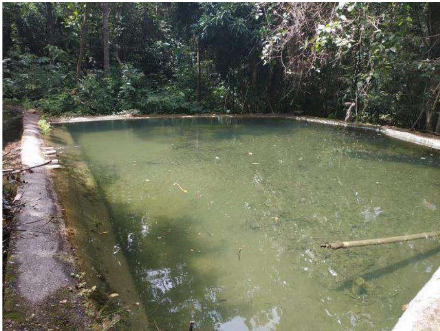
Foto 6.2 – Tanque de acumulação (caixa de areia) e tratamento físico da água distribuída para a Comunidade Povoadado Moinho, Alto Paraíso de Goiás-GO, 2019.
