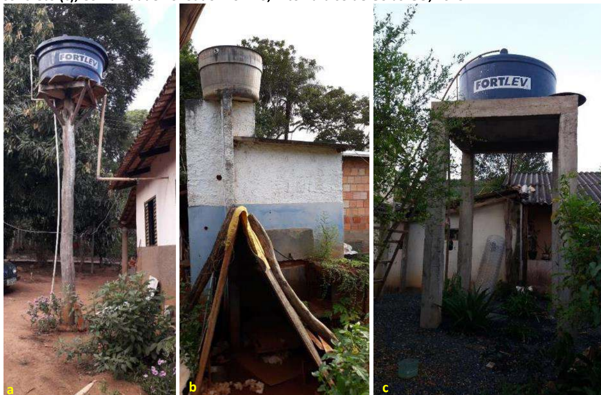
Foto 6.9 – Reservatório domiciliar instalado sobre estrutura de madeira (a), de alvenaria (b) e concreto (c), Comunidade Povoados Moinho, Alto Paraíso de Goiás-GO, 2019.
