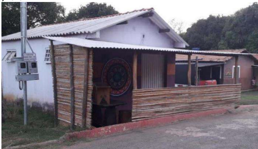
Foto 4.20 – Cobertura de fibrocimento, identificada na Comunidade Povoador Moinho, Alto Paraíso de Goiás-GO, 2019.
