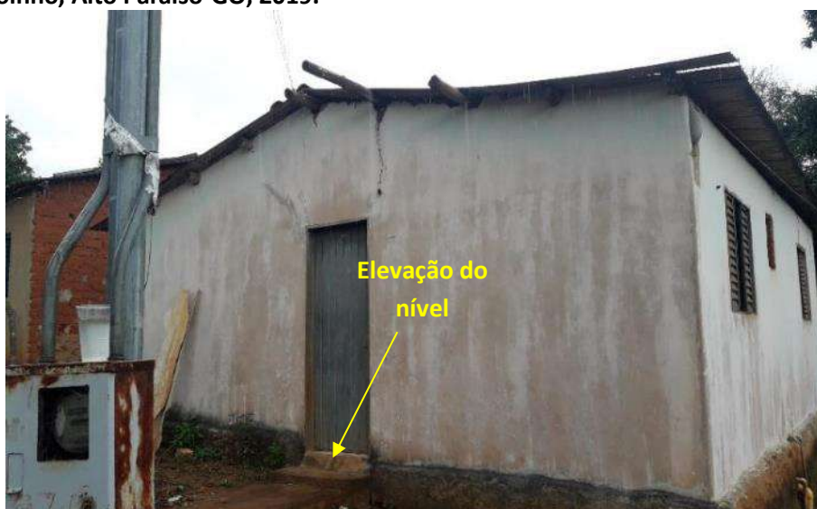
Foto 6.25 – Dispositivo de prevenção dos danos provocados pelas águas em lote da Comunidade Povoado Moinho, Alto Paraíso-GO, 2019.
