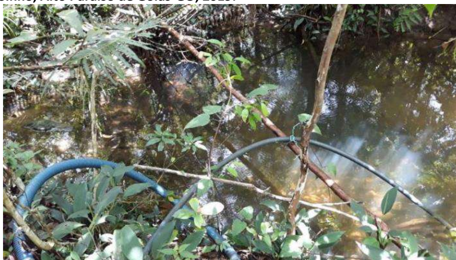
Foto 6.1 – Captação de água realizada em um manancial superficial de um domicílio na Comunidade Povoadado Moinho, Alto Paraíso de Goiás-GO, 2019.
