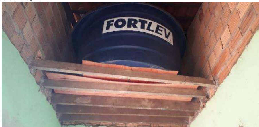
Foto 6.8 – Reservatório tampado instalado dentro da residência, Comunidade Povoadado Moinho, Alto Paraíso de Goiás-GO, 2019.
