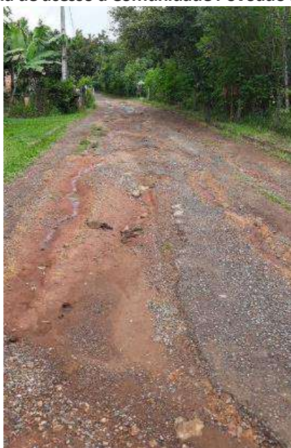
Foto 6.22 – Processo erosivo na via de acesso à Comunidade Povoadado Moinho, Alto Paraíso-GO, 2019.
