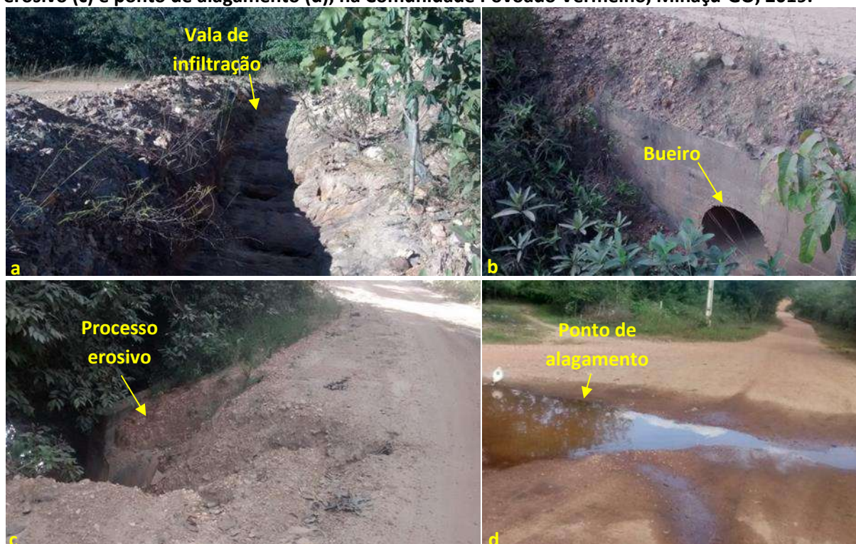
Foto 6.17 – Situação da drenagem pluvial na via de acesso: vala de infiltração (a); bueiro (b); processo erosivo (c) e ponto de alagamento (d), na Comunidade Povoadado Vermelho, Minaçu-GO, 2019.
