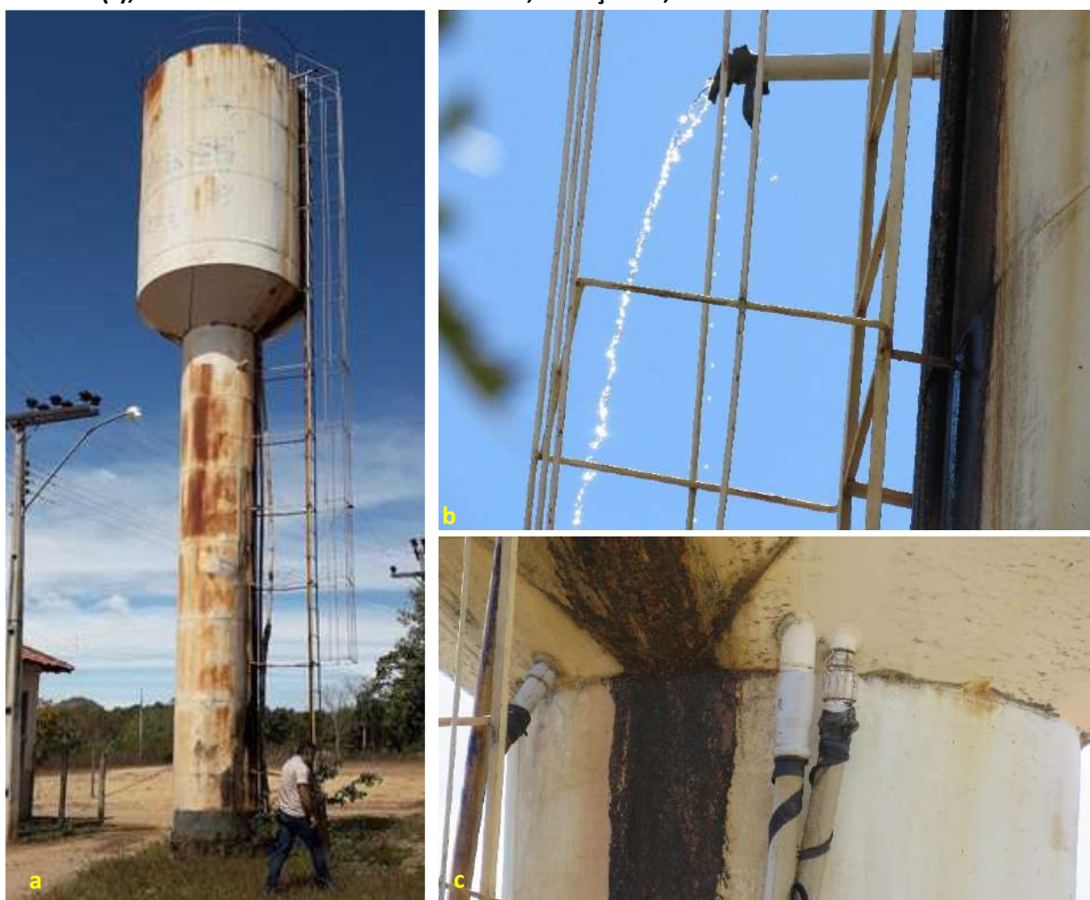
Foto 6.3 – Reservatório tipo taça em material metálico, com presença de lodo em sua lateral externa (a), em situação de extravasamento (b) e com reparos em borracha nas suas tubulações de entrada e saída (c), na Comunidade Povoado Vermelho, Minaçu-GO, 2019.
