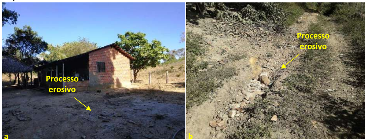
Foto 6.21 – Exemplos de processos erosivos em lotes da Comunidade Povoado Vermelho, Minaçu-GO, 2019.
