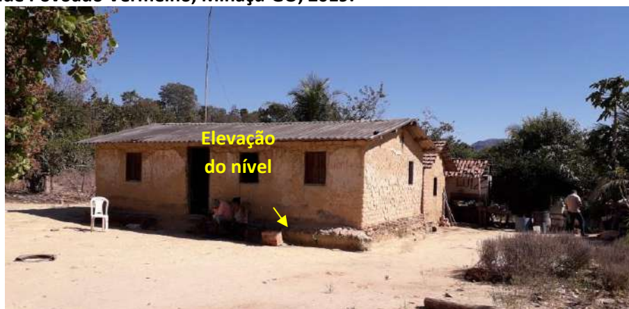
Foto 6.20 – Dispositivo de prevenção dos danos provocados pelas águas em residência da Comunidade Povoador Vermelho, Minaçu-GO, 2019.
