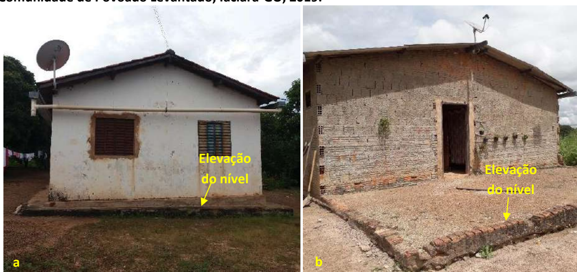
Foto 6.17 – Dispositivos de prevenção dos danos provocados pelas águas em residências da Comunidade de Povoado Levantado, Iaciara-GO, 2019.
