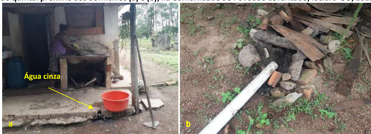
Foto 6.7 – Lançamento e acúmulo de água cinza proveniente da pia da cozinha diretamente no solo do quintal próximo aos domicílios (a) e (b), na Comunidade de Povoado Levantado, Iaciara-GO, 2019.
