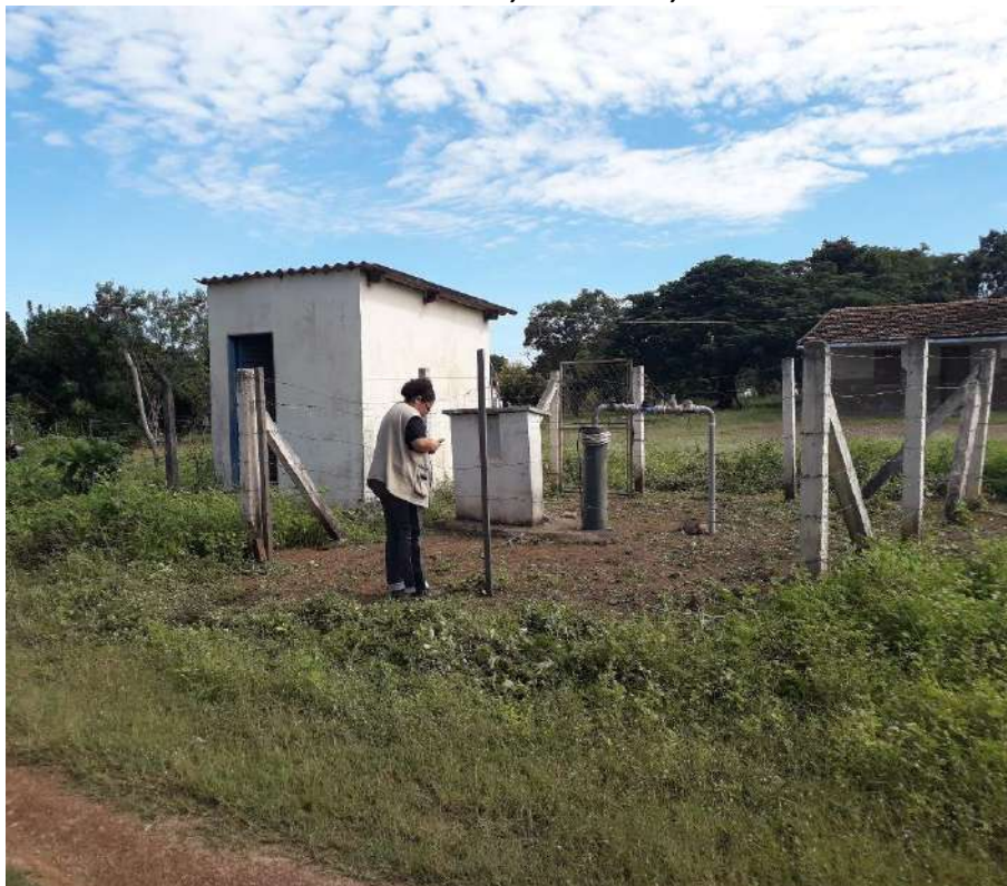
Foto 6.1 – Área de captação com cercas de isolamento, poço tubular profundo e estrutura em alvenaria, na Comunidade de Povoado Levantado, Iaciara-GO, 2019.
