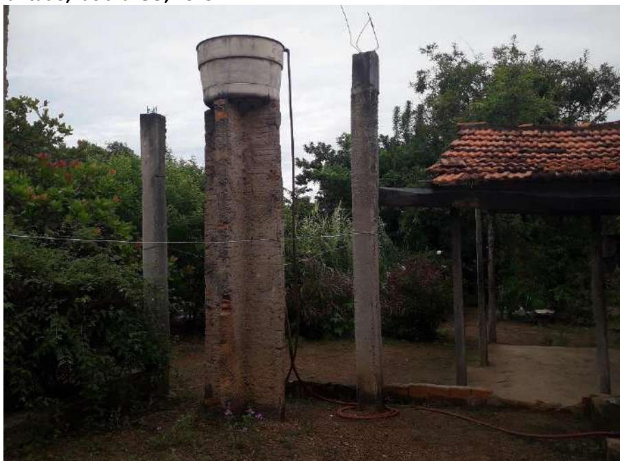
Foto 6.5 – Reservatório domiciliar instalado em uma estrutura de alvenaria, na Comunidade de Povoador Levantado, Iaciara-GO, 2019.
