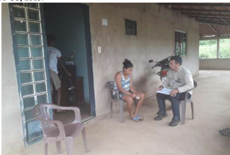
Foto 4.9 – Piso de residência constituído de concreto bruto, identificado na Comunidade de Povoado Levantado, Iaciara-GO, 2019.
