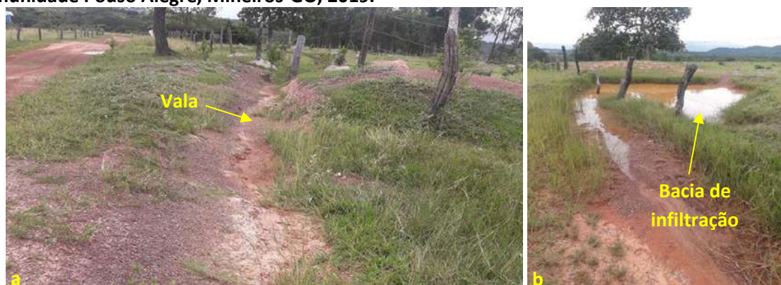
Foto 6.14 – Situação da drenagem pluvial na via de acesso: vala (a) e bacia de infiltração (b) na Comunidade Pouso Alegre, Mineiros-GO, 2019.
