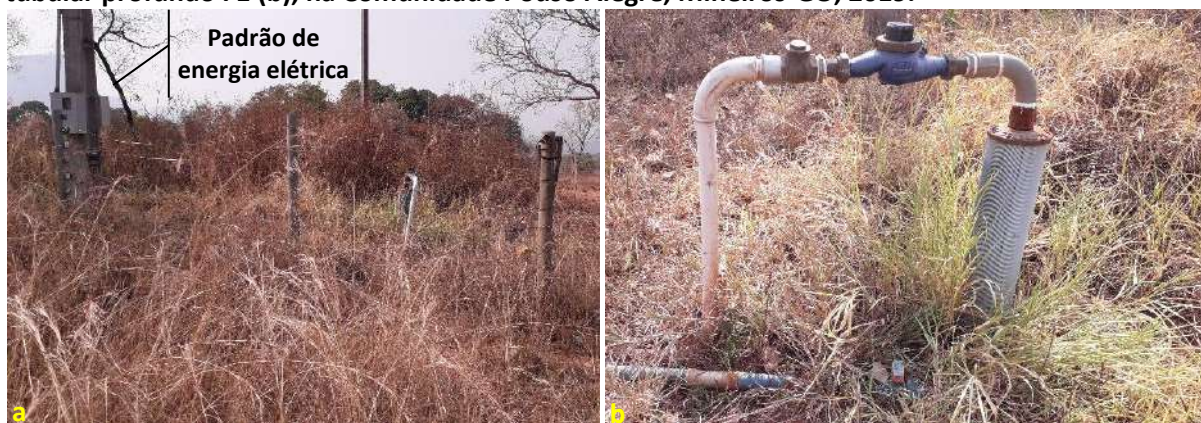
Foto 6.1 – Área de captação do SAA isolada por cerca, contendo um padrão de energia (a), e poço tubular profundo F1 (b), na Comunidade Pouso Alegre, Mineiros-GO, 2019.
