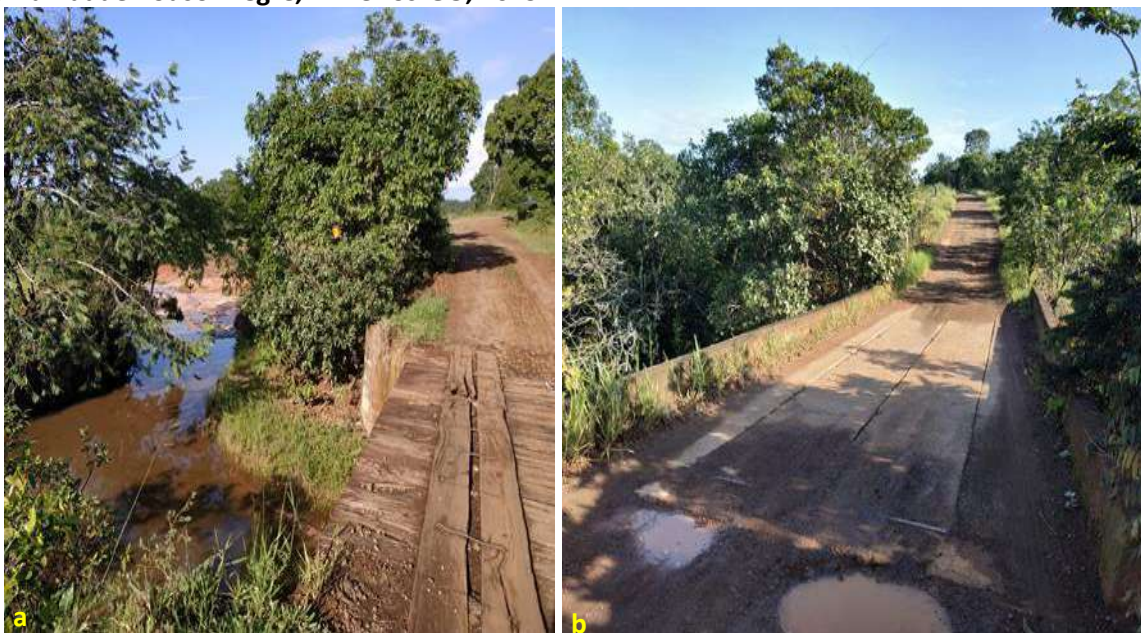
Foto 6.13 – Pontes sobre córrego Vertente (a) e córrego Barreirinho (b), na via de acesso à Comunidade Pouso Alegre, Mineiros-GO, 2019.
