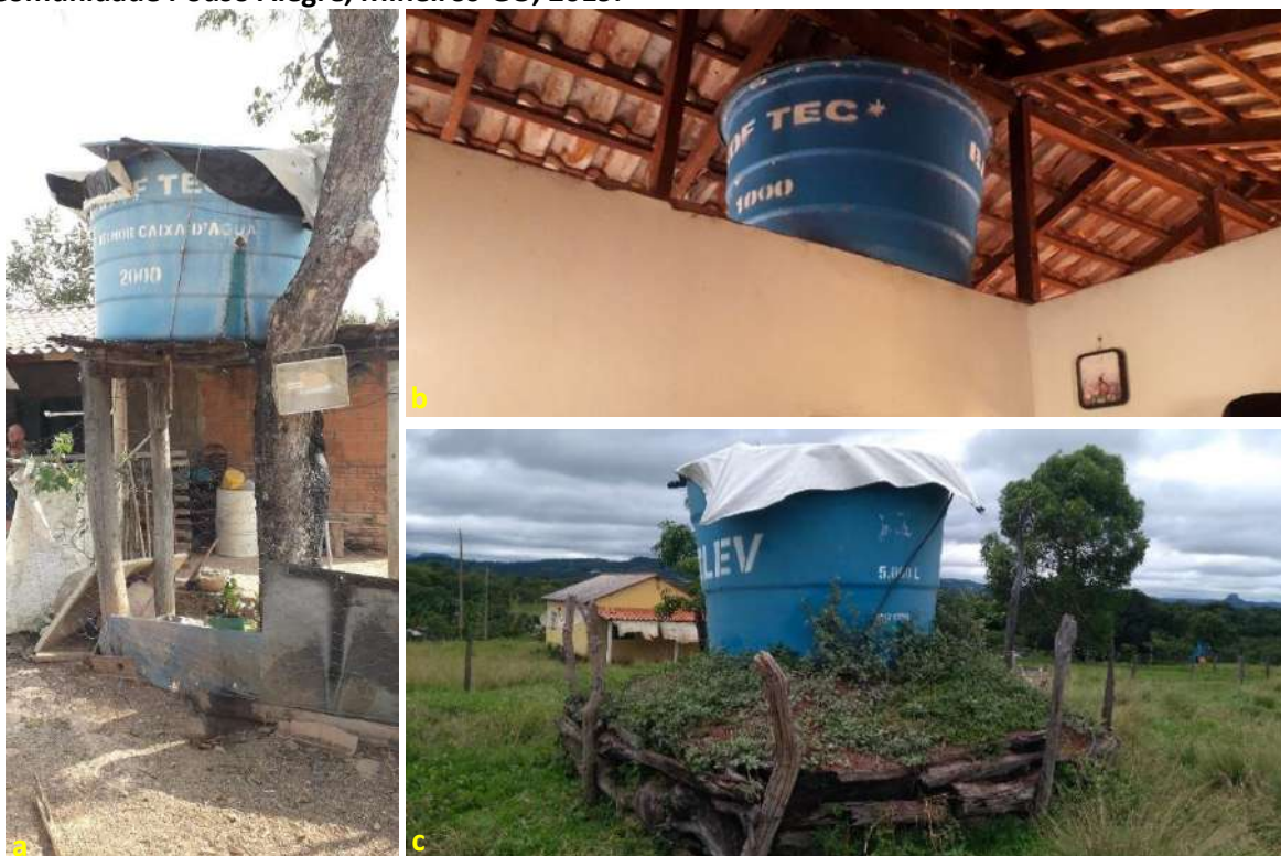
Foto 6.3 – Reservatório em polietileno tampado, com material improvisado e com trinca, instalado sobre estrutura de madeira (a), sobre estrutura de alvenaria (b), e apoiado no solo (c), na Comunidade Pouso Alegre, Mineiros-GO, 2019.
