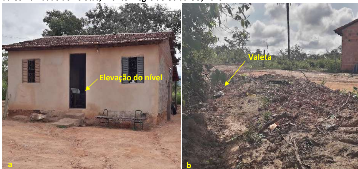
Foto 6.20 – Dispositivos de prevenção dos danos provocados pelas águas em residência (a) e lote (b) da Comunidade de Pelotas, Monte Alegre de Goiás-GO, 2019.
