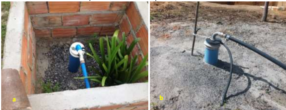
Foto 6.2 – Poço tubular raso em abrigo de alvenaria(a) e outro sem a estrutura de proteção (b), na Comunidade Novo Horizonte II, São Luiz do Norte-GO, 2018.
