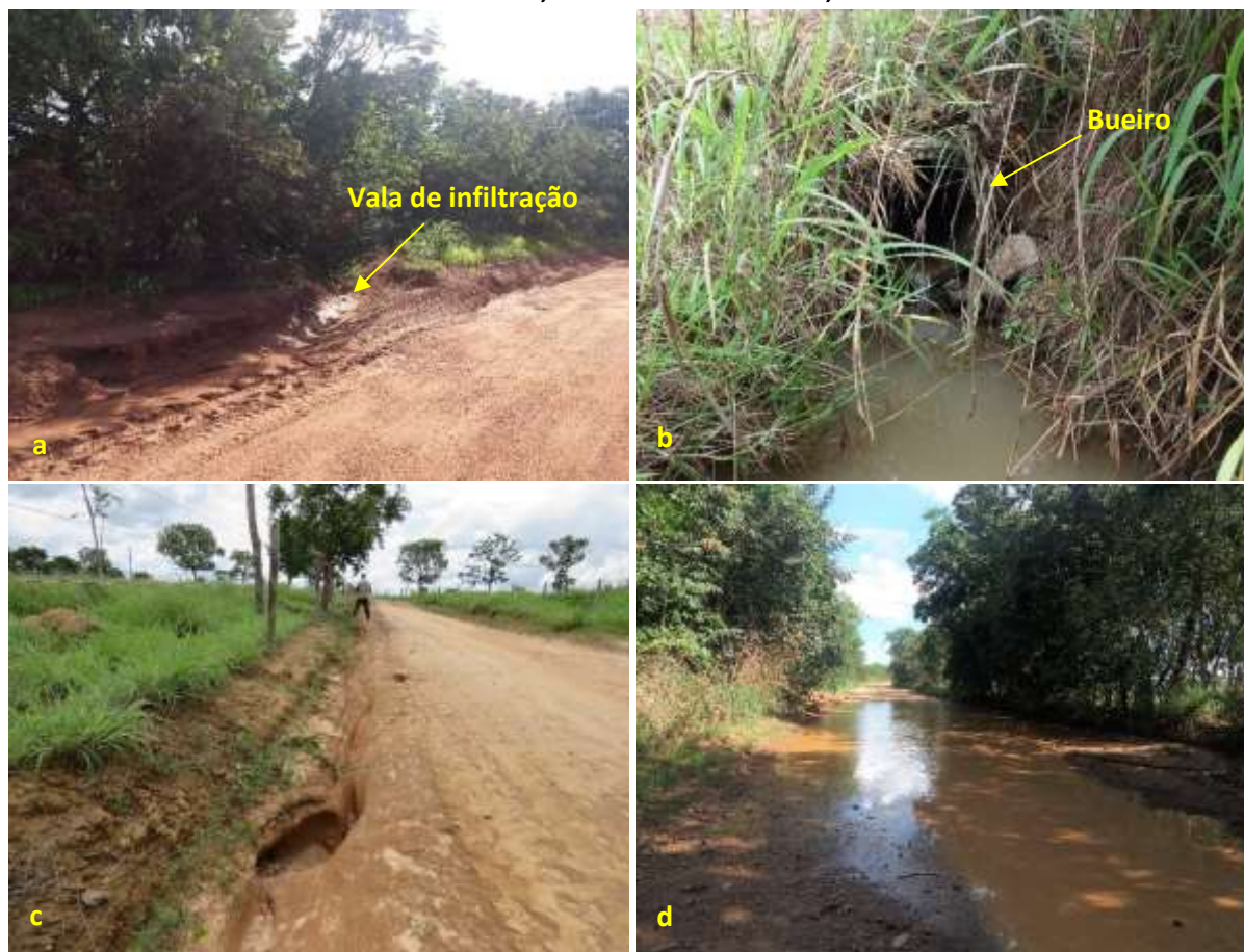
Foto 6.15 – Vala de infiltração (a), bueiro (b), processo erosivo (c) e ponto de alagamento (d) na via de acesso à Comunidade Novo Horizonte II, São Luiz do Norte-GO, 2018.
