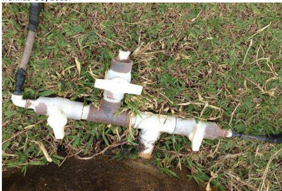
Foto 6.6 – Formação de lodo provocado por vazamento no dispositivo de conexão do reservatório e nas tubulações, sendo estancado com borracha e fita isolante na Comunidade Nascente São Domingos, Piranhas-GO, 2018.
