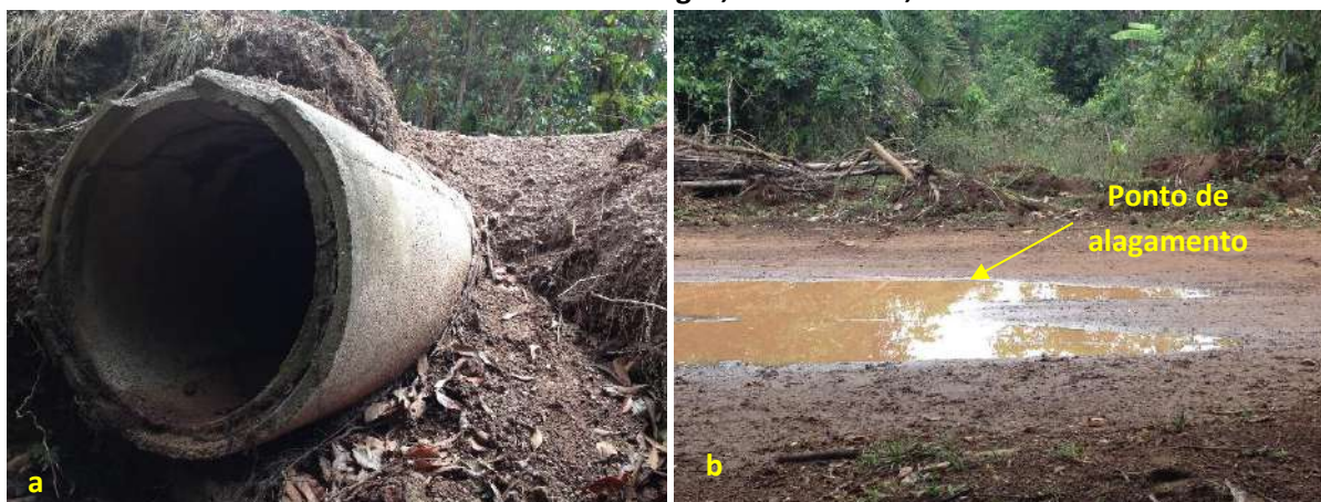
Foto 6.21 – Situação da drenagem pluvial na via de acesso: bueiro (a) e ponto de alagamento (b) nas vias de acesso à Comunidade Nascente São Domingos, Piranhas-GO, 2018.
