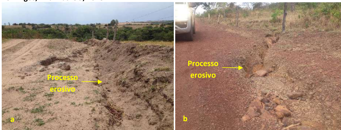
Foto 6.22 – Processos erosivos na margem e cortando a via de acesso à Comunidade Nascente São Domingos, Piranhas-GO, 2018.
