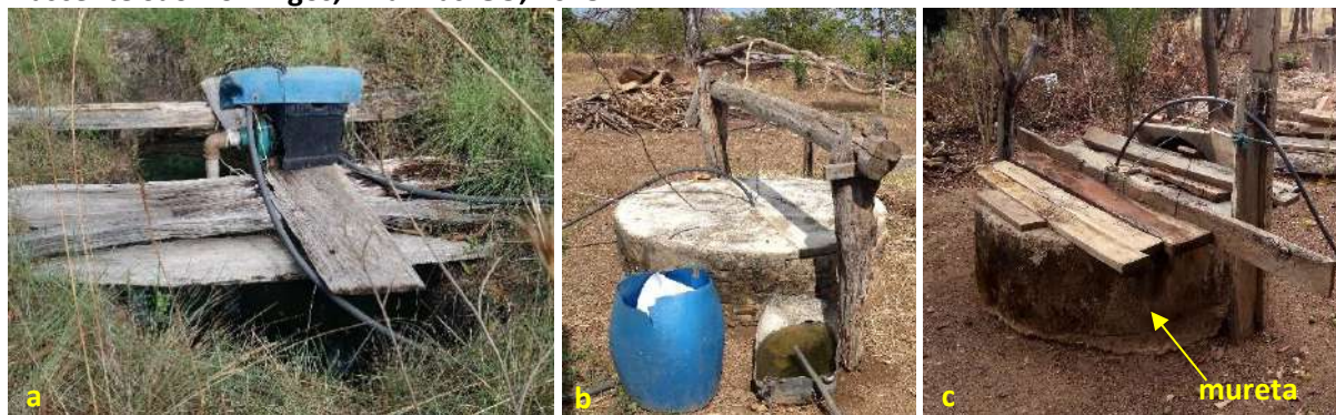
Foto 6.3 – Poço raso escavado sem nenhuma medida de proteção (a) com mureta de proteção e tampa de concreto (b), com mureta de proteção e tampa improvisada de madeira (c), Comunidade Nascente São Domingos, Piranhas-GO, 2018.
