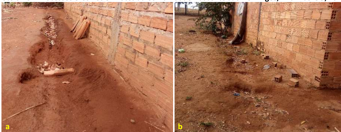
Foto 6.28 – Processos erosivos em lotes da Comunidade Nascente São Domingos, Piranhas-GO, 2018.
