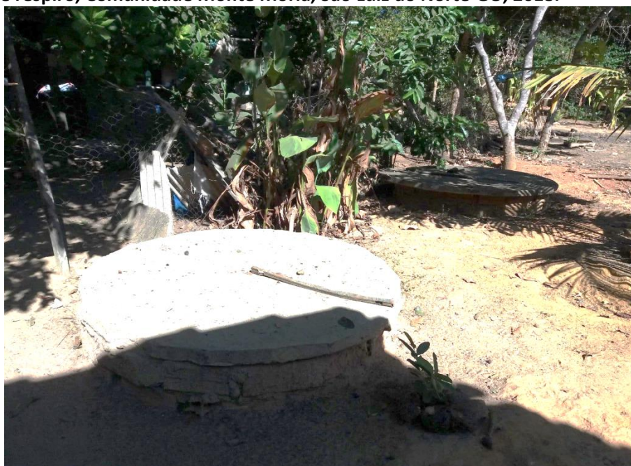
Foto 6.7 – Situação construtiva da fossa negra/rudimentar com tampa de concreto armado e sem tubulação de respiro, Comunidade Monte Moria, São Luiz do Norte-GO, 2018.
