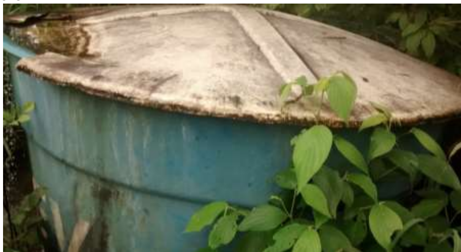
Foto 6.3 – Reservatório do SAA transbordando pela fissura da tampa, Queixo Dantas, Mimoso de Goiás-GO, 2019.
