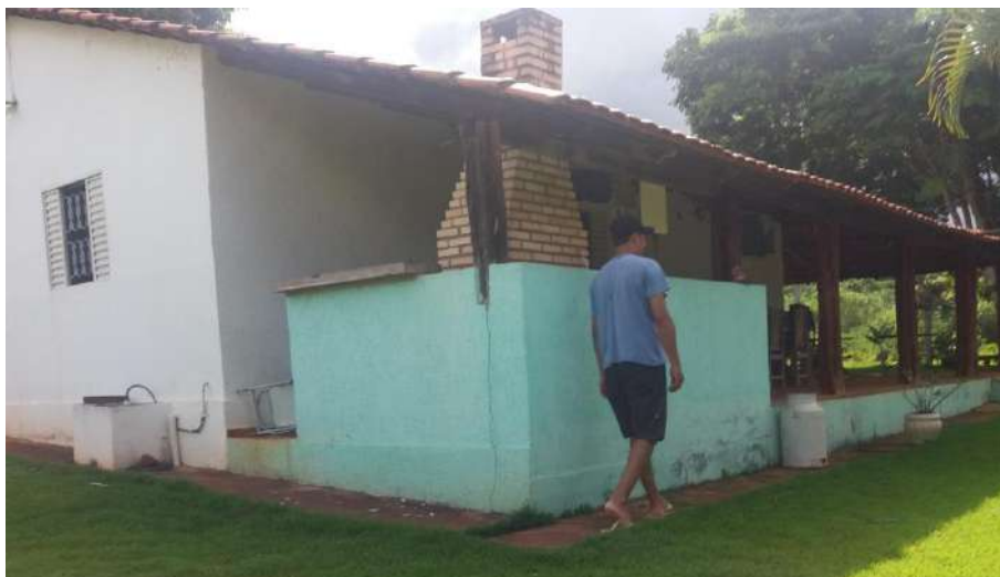
Foto 4.24 – Cobertura de telha de barro, identificada na Comunidade de Mesquita, Cidade Ocidental-GO, 2019.
