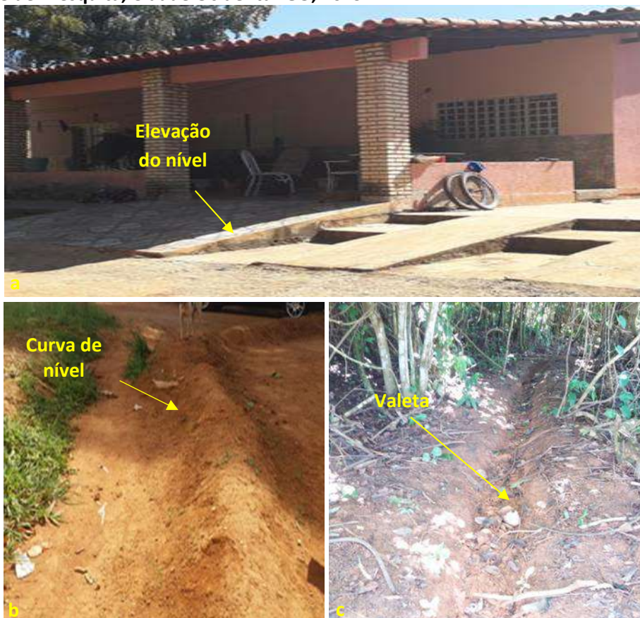
Foto 6.22 – Dispositivos de prevenção dos danos provocados pelas águas (a) e (b) nas residências da Comunidade de Mesquita, Cidade Ocidental-GO, 2019.
