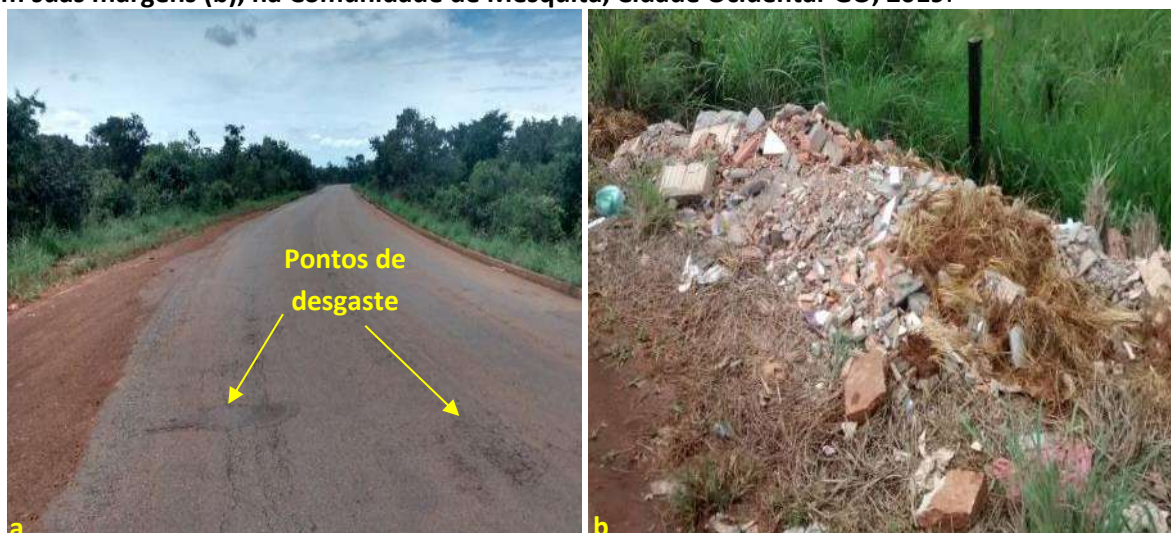
Foto 6.17 – Via de acesso pavimentada com pontos de desgaste (a) e disposição de resíduos sólidos em suas margens (b), na Comunidade de Mesquita, Cidade Ocidental-GO, 2019.
