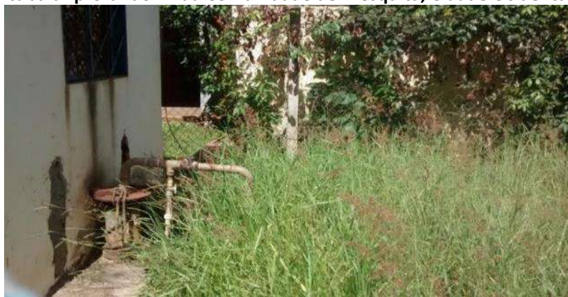
Foto 6.3 – Poço tubular profundo F2 da Comunidade de Mesquita, Cidade Ocidental-GO, 2019.
