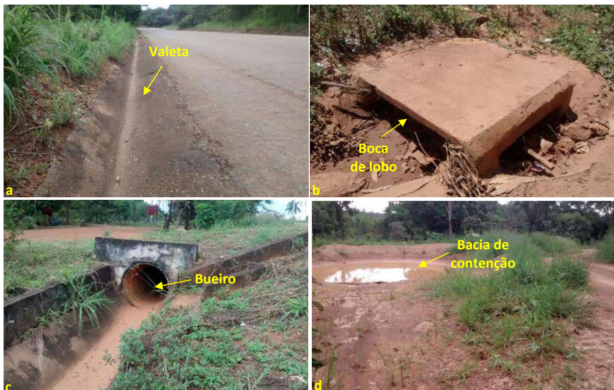
Foto 6.18 – Valeta (a), boca de lobo (b), bueiro (c) e bacia de contenção (d) nas proximidades das vias internas da Comunidade de Mesquita, Cidade Ocidental-GO, 2019.
