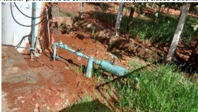
Foto 6.2 – Poço tubular profundo F1 da Comunidade de Mesquita, Cidade Ocidental-GO, 2019.
