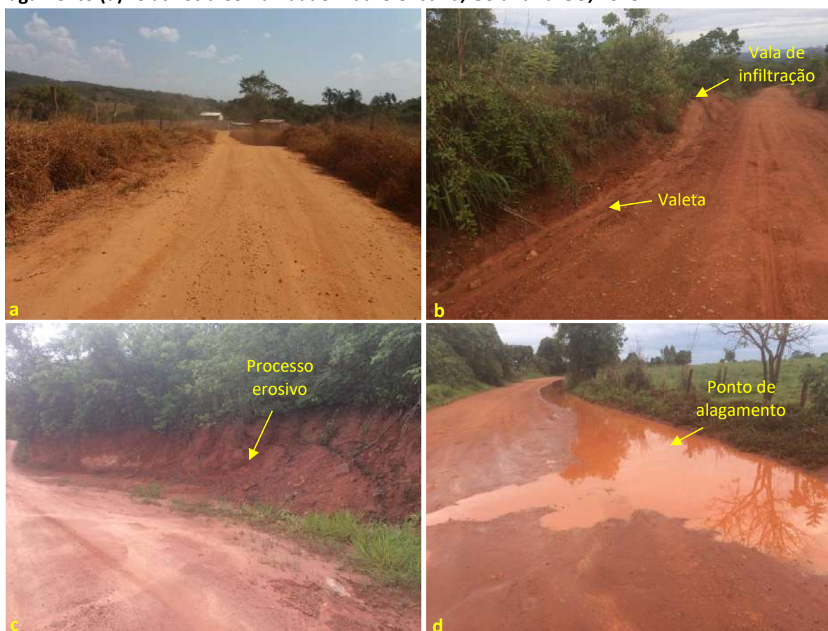
Foto 6.17 – Via de acesso (a), valeta e vala de infiltração (b), processo erosivo (c) e ponto de alagamento (d) relativos à Comunidade Madre Cristina, Goiandira-GO, 2018.
