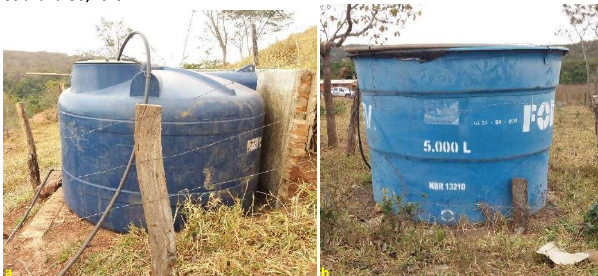
Foto 6.5 – Reservatório de polietileno apoiado ao solo e protegido por uma parede de alvenaria e cercado (a), e outro de fibra de vidro apoiado ao solo e cercado (b), na Comunidade Madre Cristina, Goiândia-GO, 2018.
