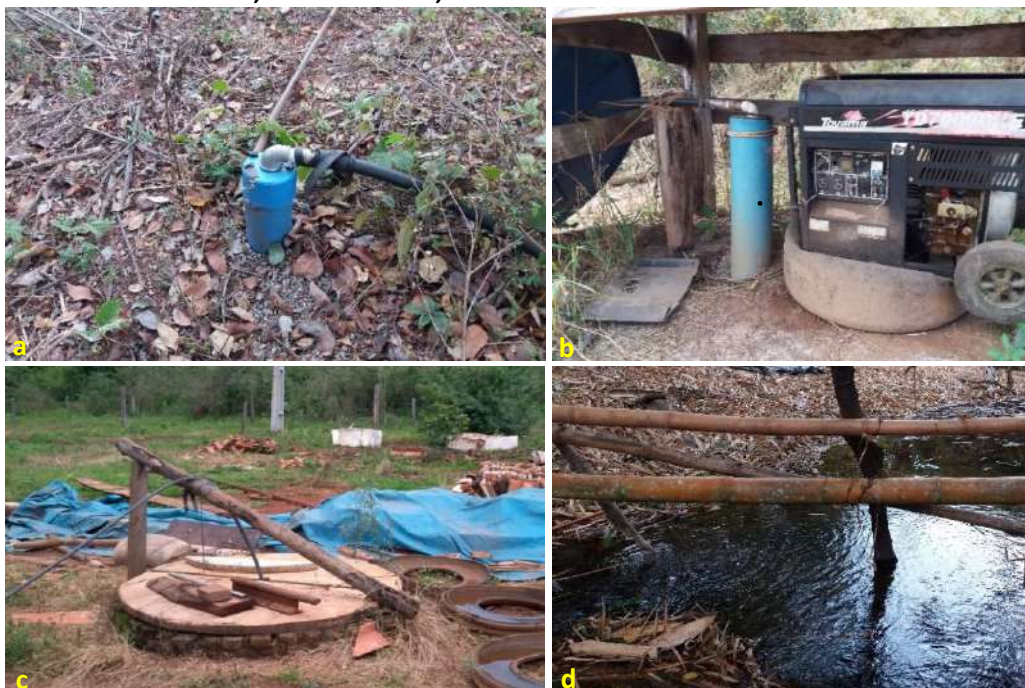
Foto 6.1 – Fontes de abastecimento de água: poço tubular raso (a) e poço tubular profundo acompanhado de um gerador de energia (b), poço raso escavado (c) e manancial superficial (d) na Comunidade Madre Cristina, Goiandira-GO, 2018.
