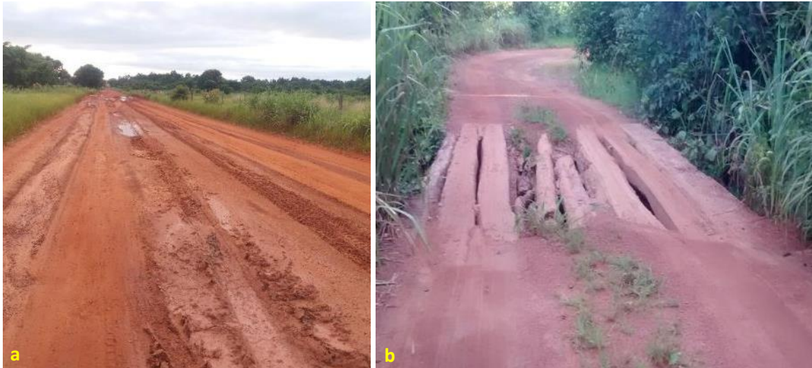
Foto 6.16 – Via de acesso (a) e ponte precária de madeira sobre o fundo de vale (b) na Comunidade Landi, Nova Crixás-GO, 2019.
