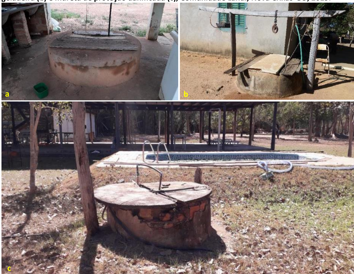
Foto 6.3 – Poço raso escavado com mecanismos de proteção (a), tampado com madeira e porta de geladeira (b) e mureta de proteção danificada (c), Comunidade Landi, Nova Crixás-GO, 2019.
