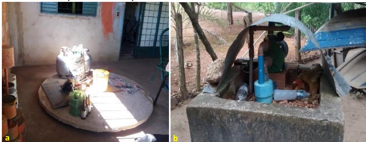
Foto 6.1 – Poço raso escavado (a) e poço tubular raso - minipoço (b) utilizados em domicílios da Comunidade Landi, Nova Crixás-GO, 2019.
