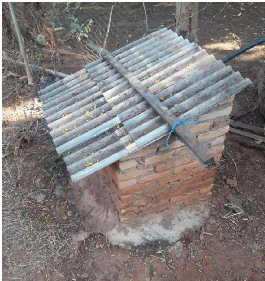
Foto 6.5 – Abrigo em alvenaria do poço tubular raso, Comunidade Lagoa Seca, Santa Rita do Novo Destino-GO, 2018.
