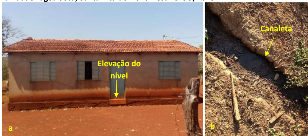
Foto 6.22 – Dispositivos de prevenção dos danos provocados pelas águas em residência (a) e lote (b) da Comunidade Lagoa Seca, Santa Rita do Novo Destino-GO, 2018.
