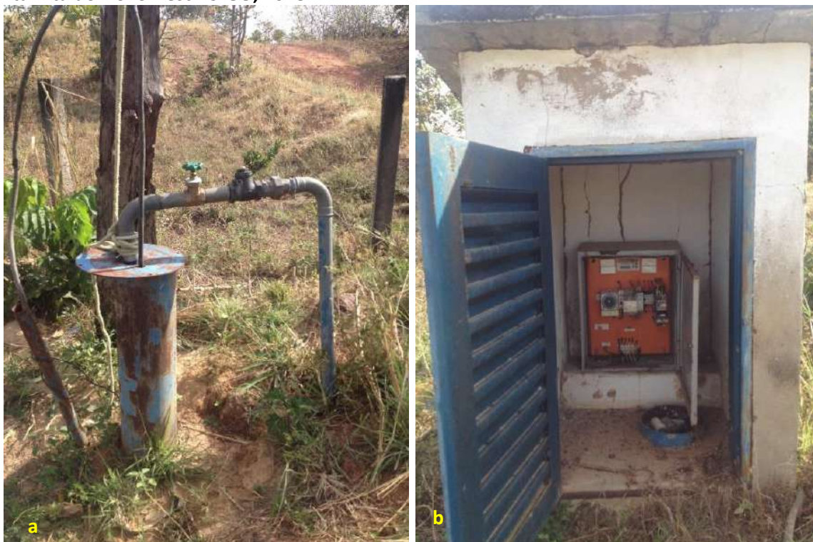
Foto 6.2 – Poço tubular profundo do SAA (a) provido de quadro elétrico (b), Comunidade Lagoa Seca, Santa Rita do Novo Destino-GO, 2018.
