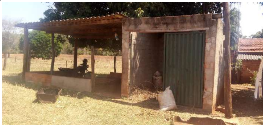
Foto 4.10 – Cobertura de fibrocimento, identificada na Comunidade Lagoa Seca, Santa Rita do Novo Destino-GO, 2018.
