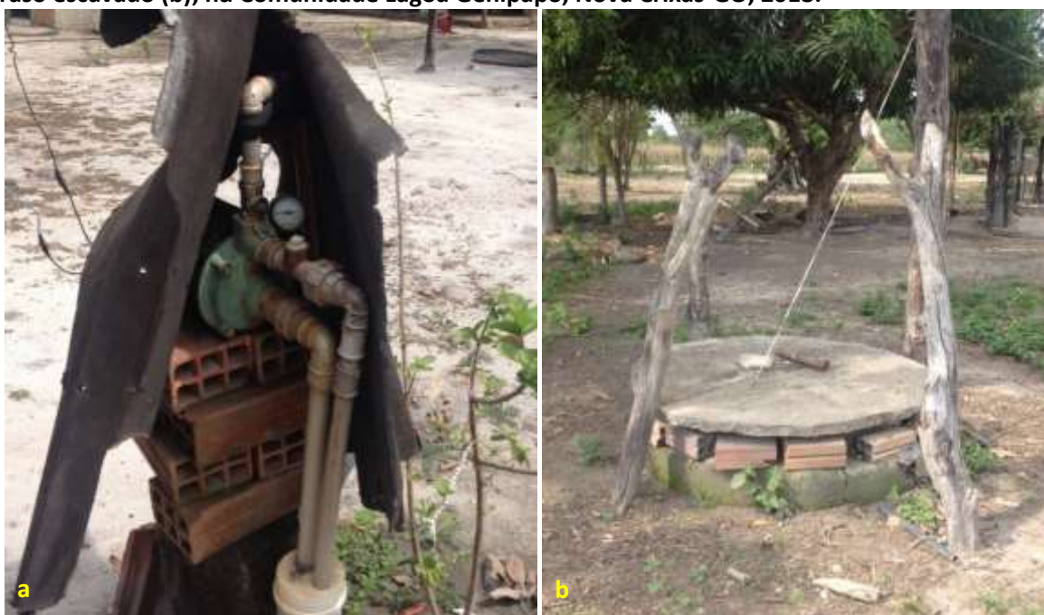
Foto 6.1 – Fontes de abastecimento de água utilizadas para ingestão: poço tubular raso (a) e poço raso escavado (b), na Comunidade Lagoa Genipapo, Nova Crixás-GO, 2018.
