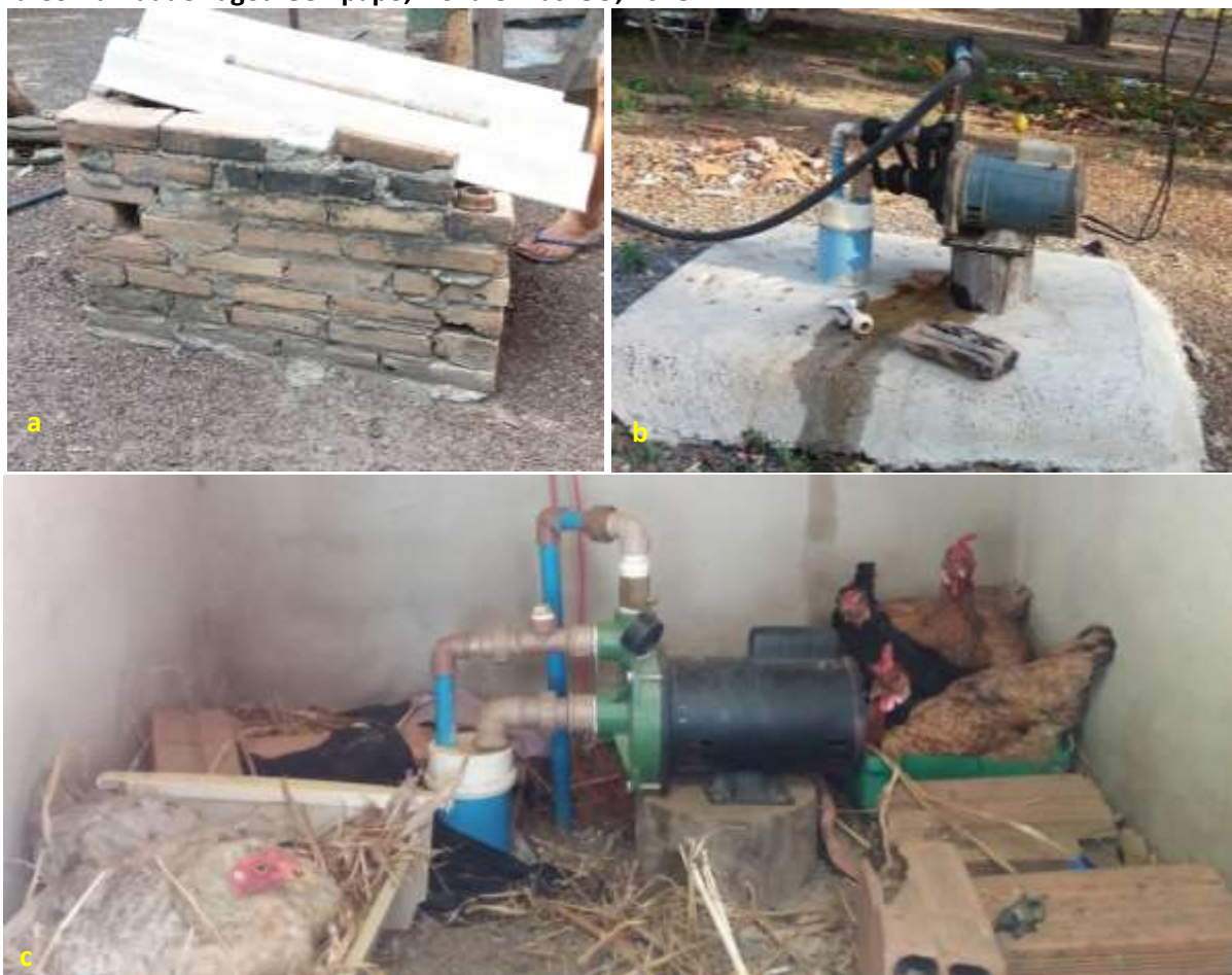
Foto 6.3 – Poço tubular raso: protegido em abrigo de alvenaria e coberto com telhas de fibrocimento (a); com base em concreto mas sem proteção no entorno (b), em abrigo compartilhado com aves (c), na Comunidade Lagoa Genipapo, Nova Crixás-GO, 2018.
