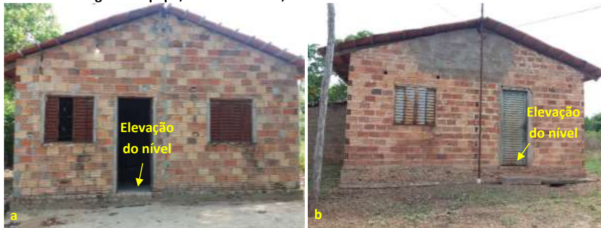
Foto 6.16 – Dispositivos de prevenção dos danos provocados pelas águas em residências da Comunidade Lagoa Genipapo, Nova Crixás-GO, 2018.
