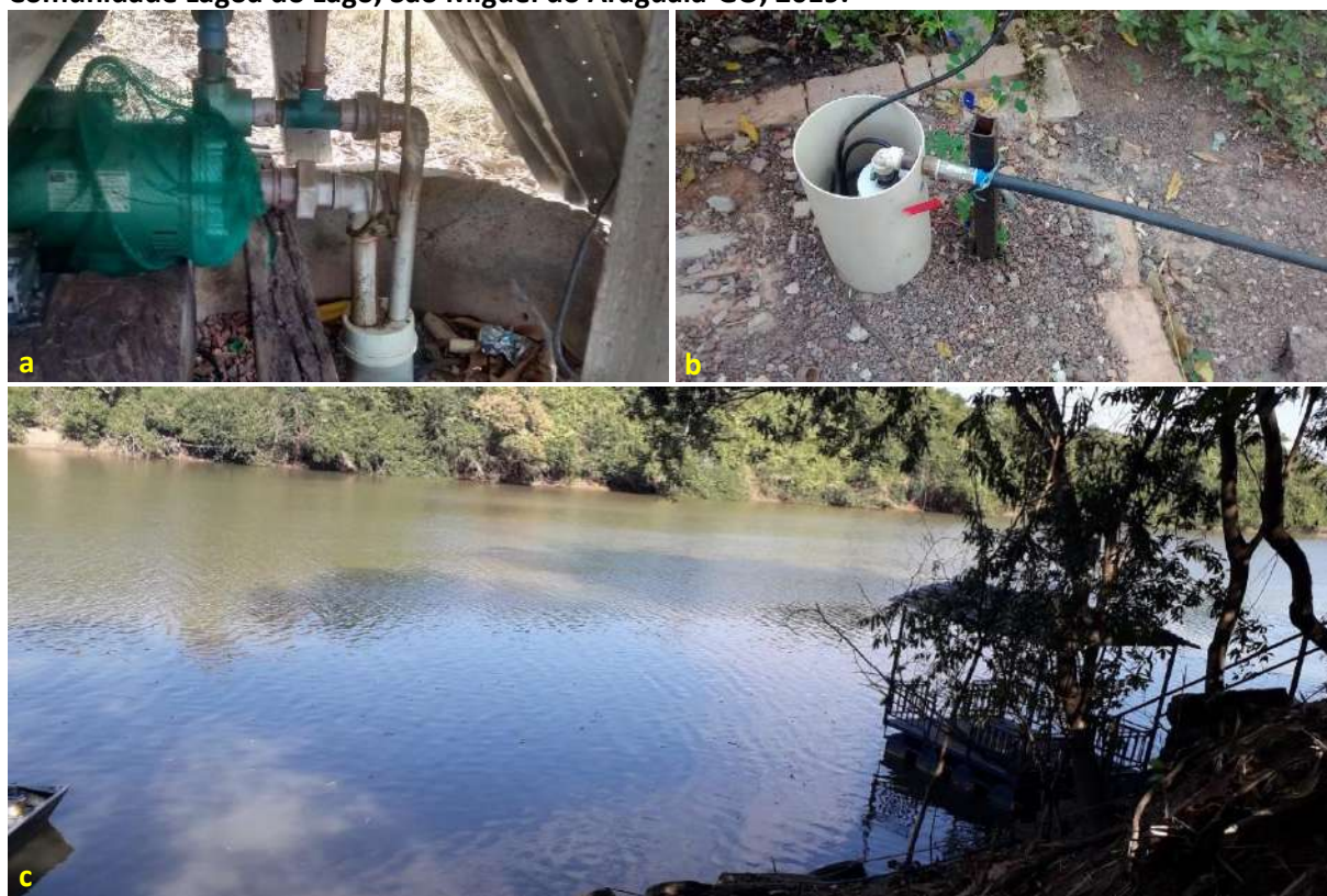
Foto 6.1 – Poço tubular raso (a), poço tubular profundo (b) e manancial superficial (c), na Comunidade Lagoa do Lago, São Miguel do Araguaia-GO, 2019.
