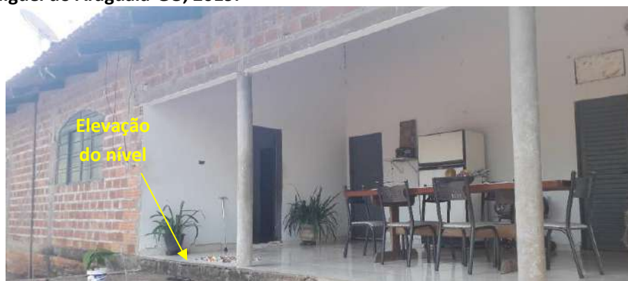
Foto 6.18 – Dispositivos de prevenção dos danos provocados pelas águas, na Comunidade Lagoa do Lago, São Miguel do Araguaia-GO, 2019.
