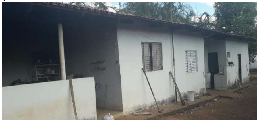
Foto 4.8 – Cobertura de telha de barro, identificada na Comunidade Lagoa do Lago, São Miguel do Araguaia-GO, 2019.
