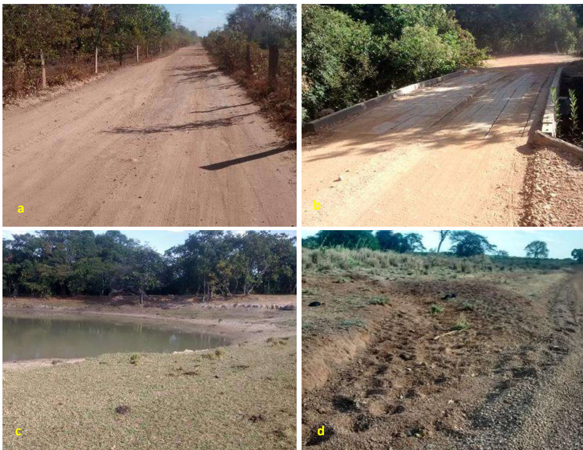
Foto 6.14 – Via de acesso não pavimentada (a), ponte na via de acesso (b), bacia de contenção (c) e processo erosivo (d), na Comunidade Lagoa do Lago, São Miguel do Araguaia-GO, 2019.
