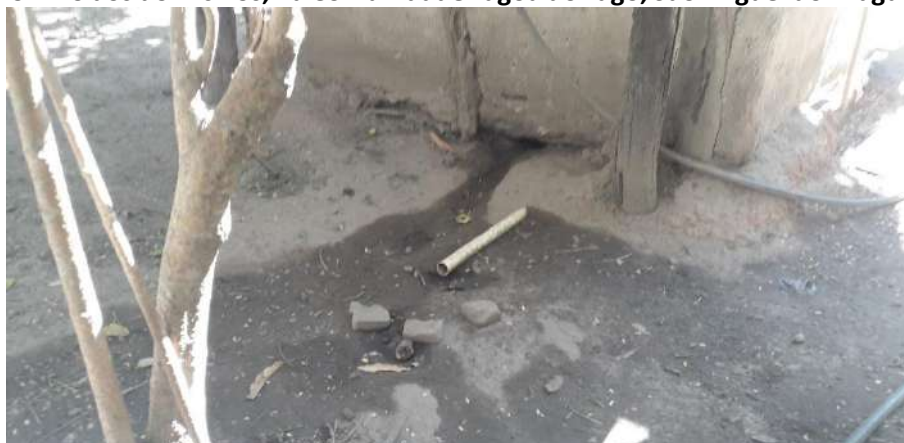
Foto 6.8 – Lançamento e acúmulo de água cinza proveniente da pia da cozinha diretamente no solo do quintal próximo aos domicílios, na Comunidade Lagoa do Lago, São Miguel do Araguaia-GO, 2019.
