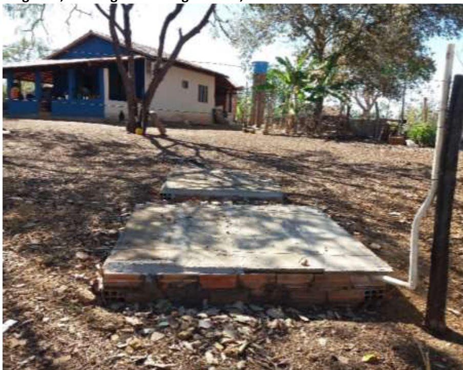
Foto 6.7 – Fossa séptica com tampa de concreto armado e tubulação de respiro sem vedação, na Comunidade Lageado, São Miguel do Araguaia-GO, 2018.
