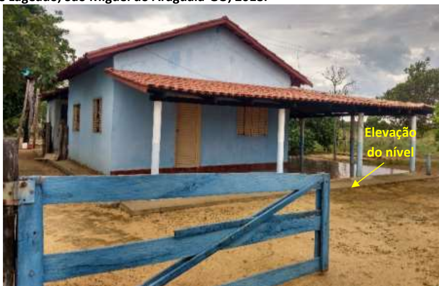
Foto 6.22 – Dispositivo de prevenção dos danos provocados pelas águas em residência da Comunidade Lageado, São Miguel do Araguaia-GO, 2018.
