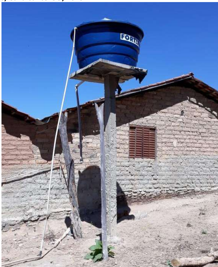
Foto 6.5 – Reservatório domiciliar de polietileno instalado sobre pilar de concreto, na Comunidade Kalunga dos Morros, Cavalcante-GO, 2019.
