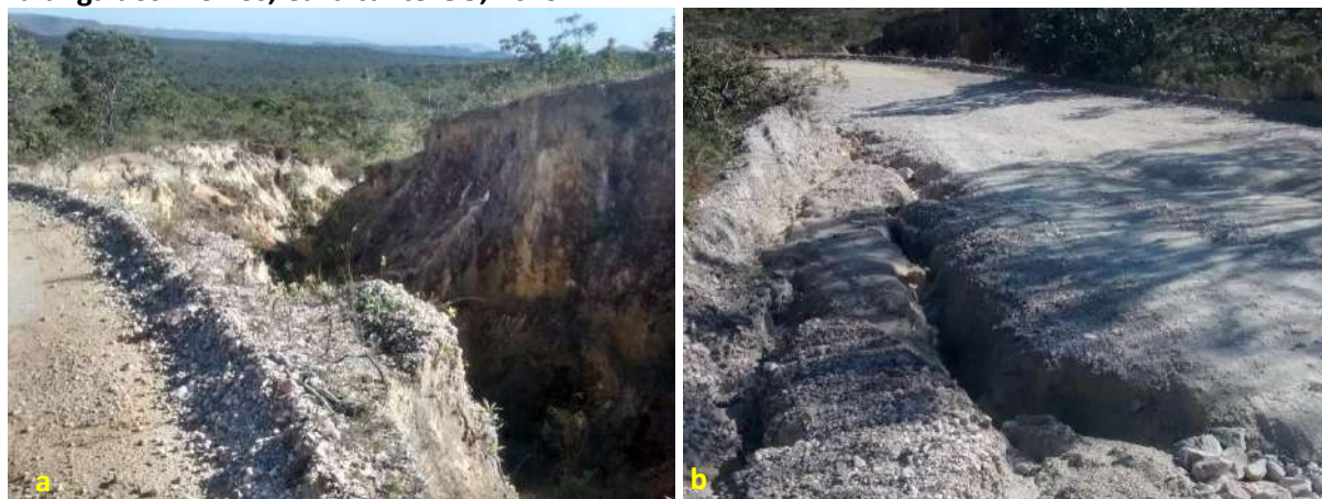
Foto 6.19 – Processos erosivos nas margens da via de acesso (a) e na via de acesso (b) à Comunidade Kalunga dos Morros, Cavalcante-GO, 2019.
