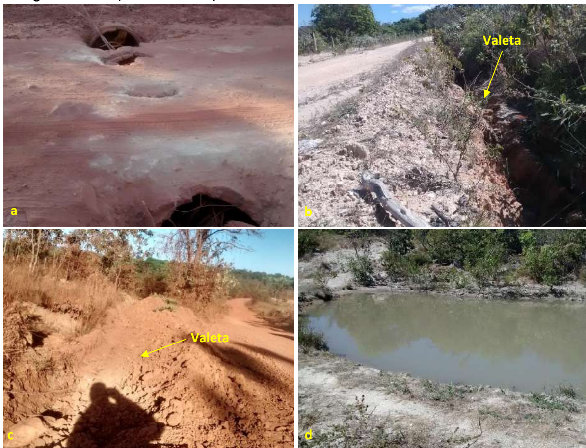
Foto 6.17 – Bueiro (a), valetas (b), (c) e bacia de contenção (d) na via de acesso à Comunidade Kalunga dos Morros, Cavalcante-GO, 2019.
