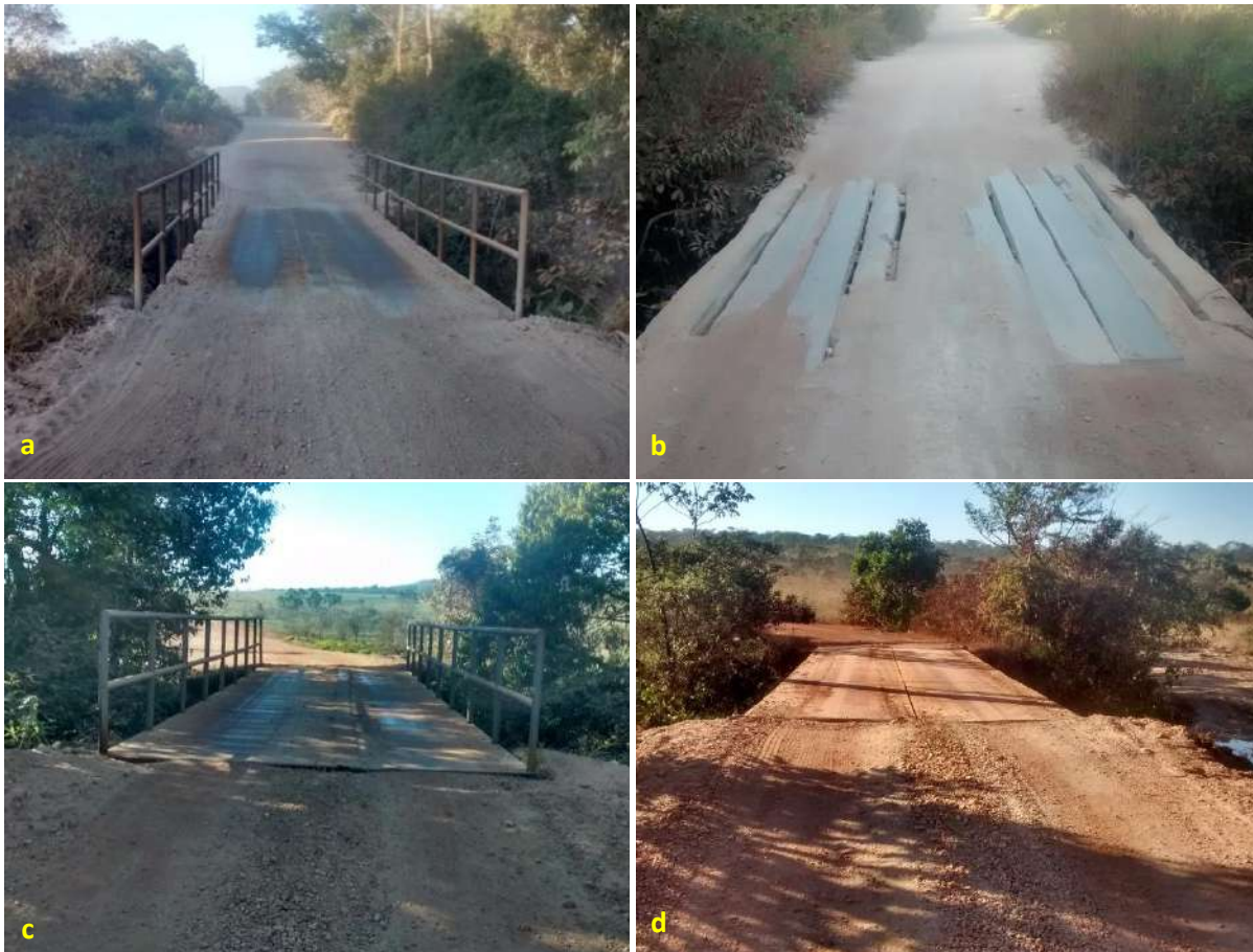
Foto 6.16 – Pontes sobre córregos na via de acesso à Comunidade Kalunga dos Morros, Cavalcante-GO, 2019.
