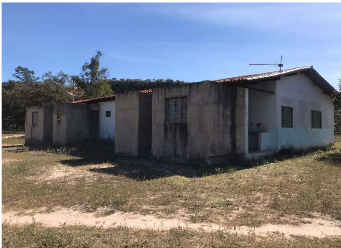
Foto 5.1 – Vista externa da UBSF III, referência para a Comunidade Kalunga dos Morros, Cavalcante-GO, 2020.
