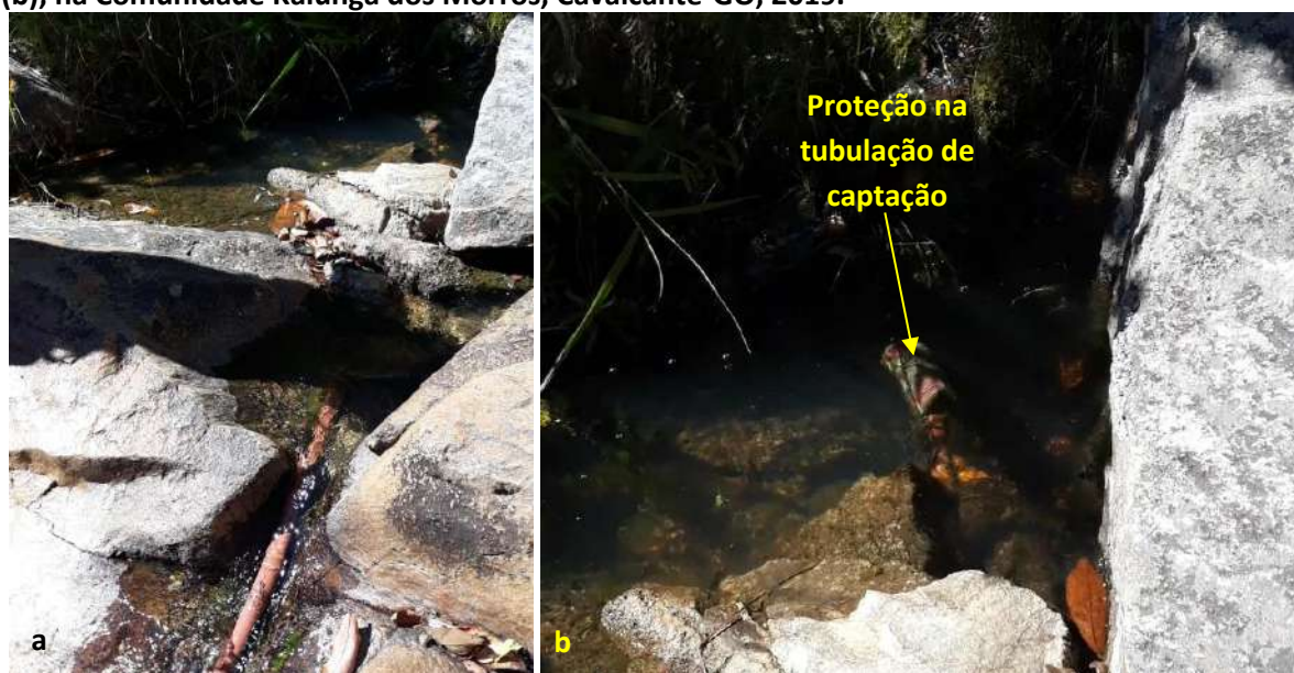
Foto 6.2 – Ponto de captação no manancial de serra 2 (a) e entrada da tubulação protegida por tecido (b), na Comunidade Kalunga dos Morros, Cavalcante-GO, 2019.
