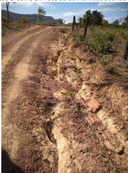
Foto 6.25 – Exemplo de processo erosivo em lote da Comunidade Julião Ribeiro, Niquelândia-GO, 2018.
