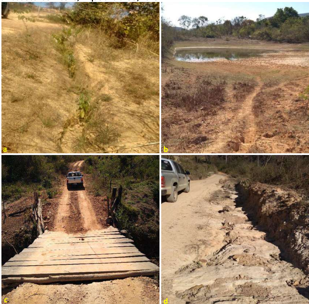
Foto 6.21 – Valeta (a), barraginha (b), ponte sobre fundo de vale (c) e processo erosivo (d) na Comunidade Julião Ribeiro, Niquelândia-GO, 2018.
