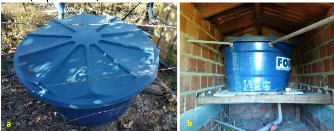
Foto 6.9 – Diferentes condições dos reservatórios domiciliares: reservatório de polietileno apoiado diretamente no solo (a) e outro instalado sobre uma base na laje de um domicílio (b), na Comunidade Julião Ribeiro, Niquelândia-GO, 2018.
