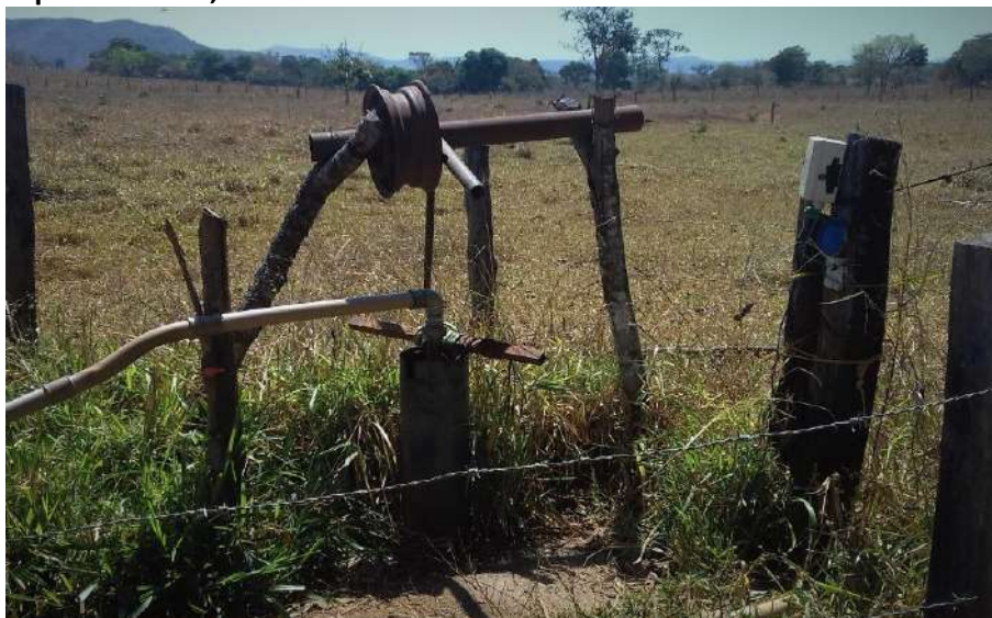
Foto 6.2 – Poço tubular profundo do SAA e interruptor do conjunto motobomba, na Comunidade José Martí, Niquelândia-GO, 2018.
