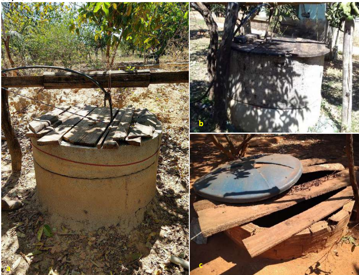
Foto 6.5 – Poço raso escavado tampado com tábuas de madeira (a), com tampa de material concreto (b) e um poço raso escavado desativado pelo morador (c), na Comunidade José Martí, Niquelândia-GO, 2018.
