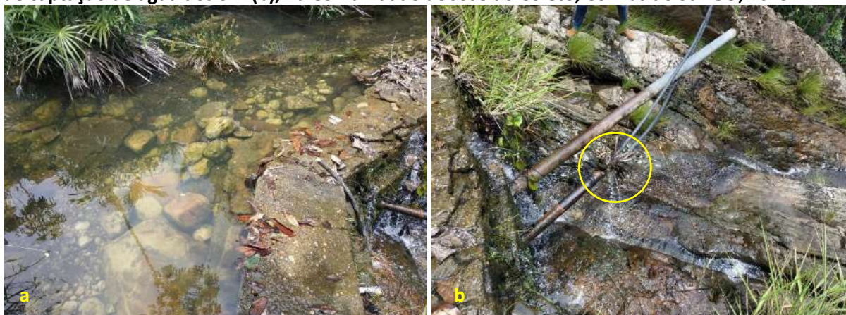
Foto 6.3 – Captação de água (F1) e vazamento identificado na ligação do registro com as tubulações de captação de água dos SAI (b), na Comunidade de José do Coletto, Colinas do Sul-GO, 2019.
