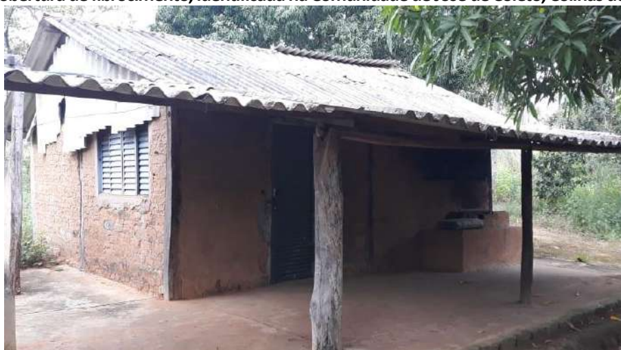
Foto 4.8 – Cobertura de fibrocimento, identificada na Comunidade de José de Coletto, Colinas do Sul-GO, 2019.
