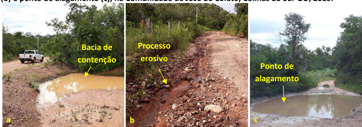
Foto 6.17 – Situação da drenagem pluvial na via de acesso: bacia de contenção (a), processo erosivo (b) e ponto de alagamento (c), na Comunidade de José de Coletto, Colinas do Sul-GO, 2019.
