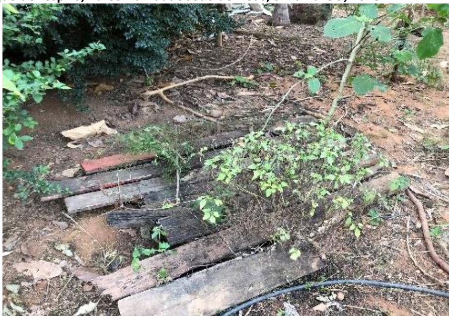
Foto 6.5 – Situação construtiva de fossa negra/rudimentar com cobertura inadequada de madeira e sem tubulação de respiro, na Comunidade João de Deus, Silvânia-GO, 2018.
