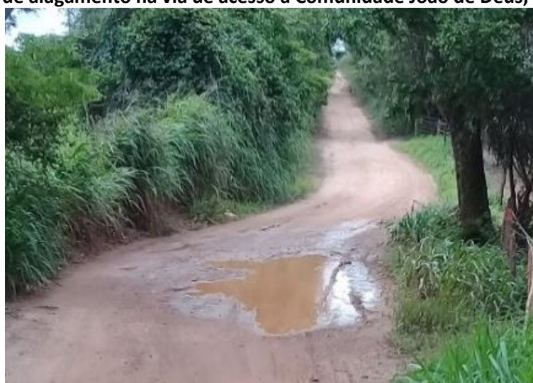
Foto 6.17 – Ponto de alagamento na via de acesso à Comunidade João de Deus, Silvânia-GO, 2018.
