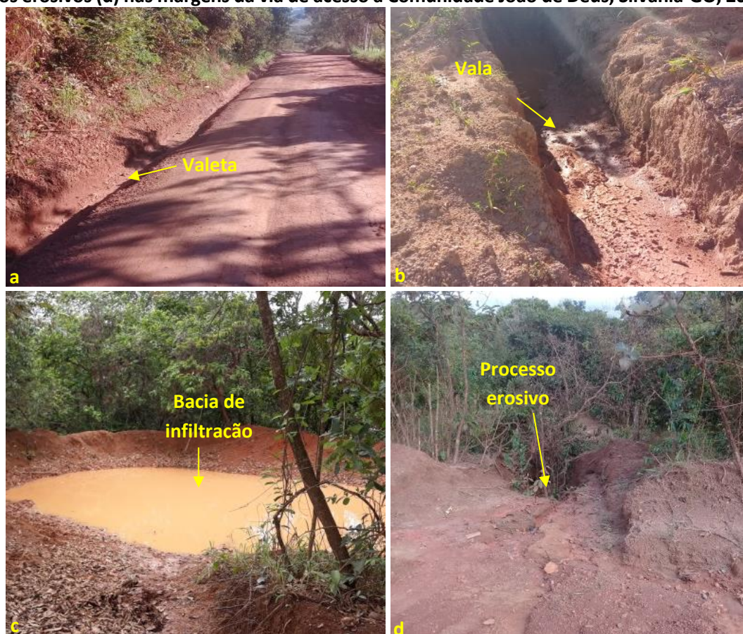
Foto 6.16 – Situação da drenagem pluvial na via de acesso: valeta (a), vala (b), bacia de infiltração (c) e processos erosivos (d) nas margens da via de acesso à Comunidade João de Deus, Silvânia-GO, 2018.
