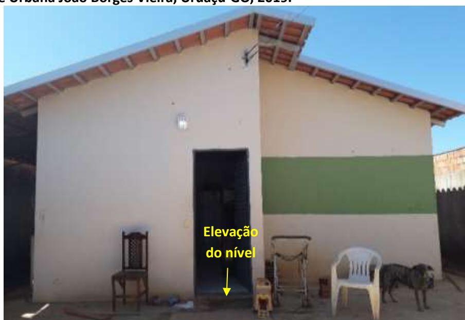
Foto 6.10 – Dispositivo de prevenção dos danos provocados pelas águas em residência da Comunidade Urbana João Borges Vieira, Uruaçu-GO, 2019.
