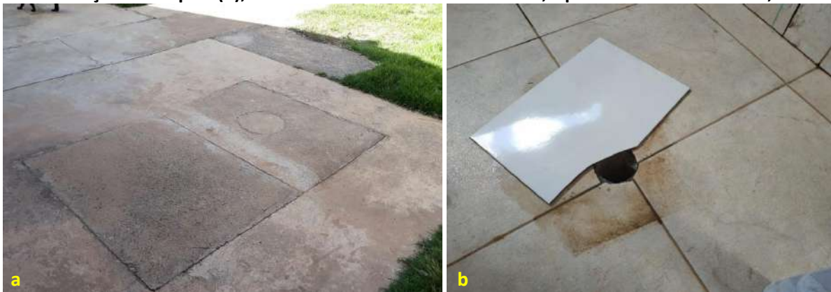
Foto 6.5 – Situações construtivas das fossas séptica com sumidouro sem tubulação (a) e fossa séptica com tubulação de respiro (b), na Comunidade de Jardim Cascata, Aparecida de Goiânia-GO, 2019.
