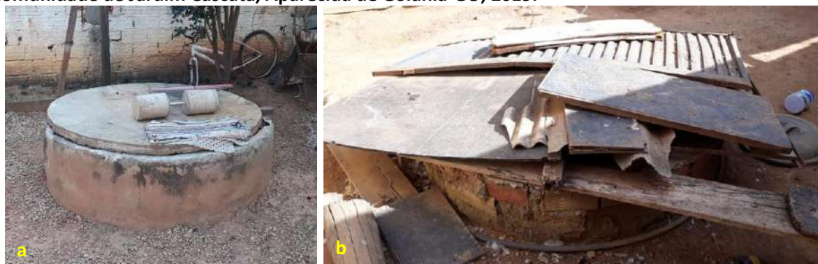
Foto 6.1 – Poço raso escavado com mureta de proteção, tampado com tampa de concreto e sem calçamento ao redor (a), e outro tampado com uma porta metálica, madeira e telha (b), na Comunidade de Jardim Cascata, Aparecida de Goiânia-GO, 2019.
