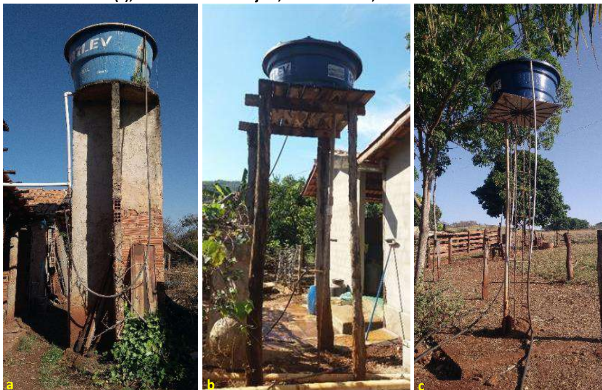
Foto 6.7 – Reservatório domiciliar em fibra de vidro, com sinal de transbordamento e instalado sobre estrutura de alvenaria (a), de polietileno instalado sobre estrutura de madeira (b) e outro sobre estrutura metálica (c), na Comunidade Itajá II, Goianésia-GO, 2018.
