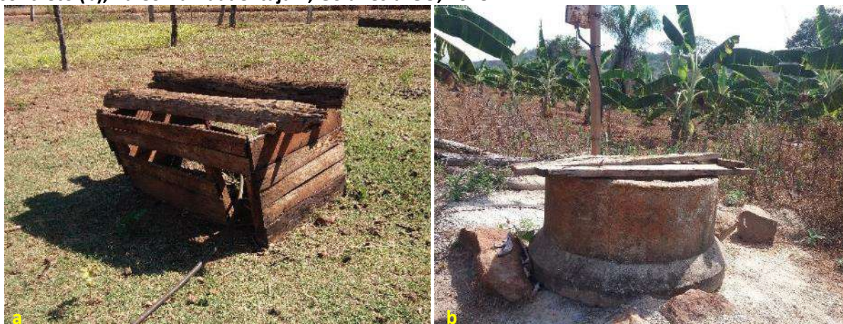
Foto 6.3 – Estrutura para abrigo do poço tubular profundo, feita em madeira (a) e com tubulação de concreto (b), na Comunidade Itajá II, Goianésia-GO, 2018.
