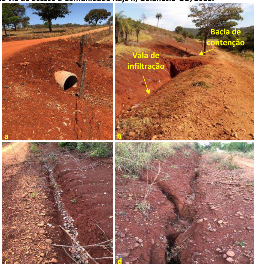
Foto 6.17 – Bueiro (a), vala de infiltração e bacia de contenção (b), valeta (c) e processo erosivo (d) nas margens da via de acesso à Comunidade Itajá II, Goianésia-GO, 2018.
