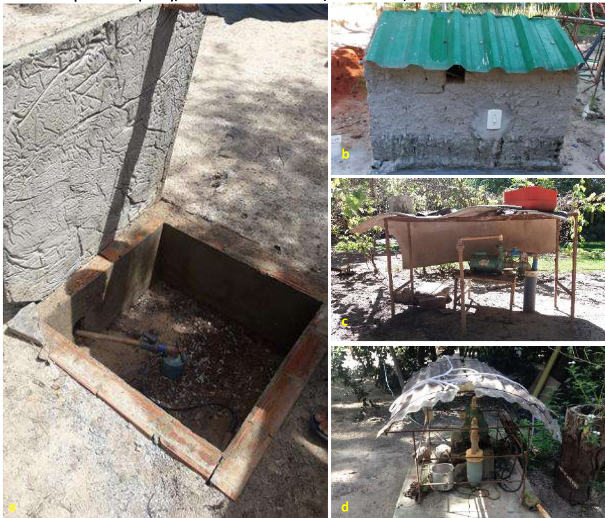
Foto 6.2 – Poço tubular raso abrigado em estrutura de alvenaria (a e b) e protegido por materiais de forma improvisada (c e d), na Comunidade Itacaiú, Britânia-GO, 2018.
