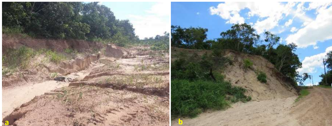
Foto 6.14 – Processos erosivos nas margens da via de acesso à Comunidade Itacaiú, Britânia-GO, 2018.
