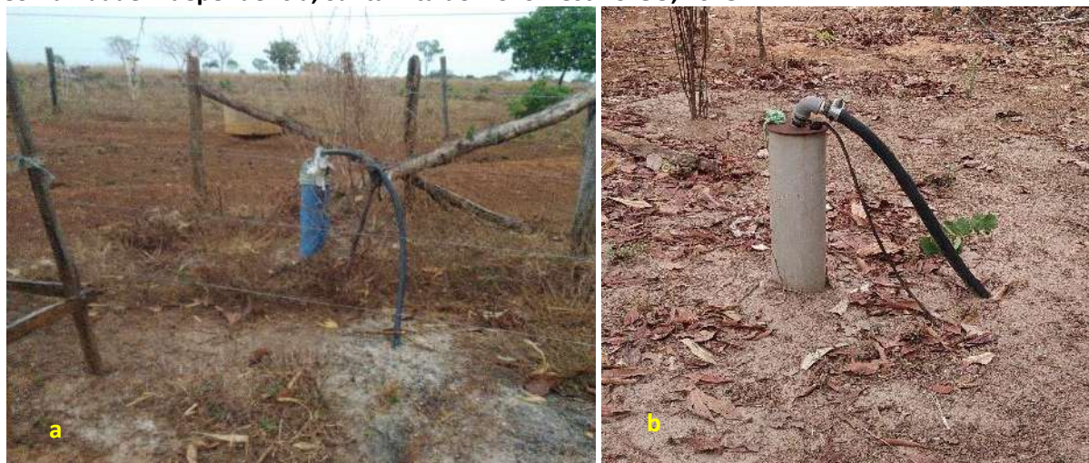
Foto 6.2 – Poço tubular profundo com cerca de proteção (a) e sem dispositivos de proteção (b), na Comunidade Independência, Santa Rita do Novo Destino-GO, 2018.
