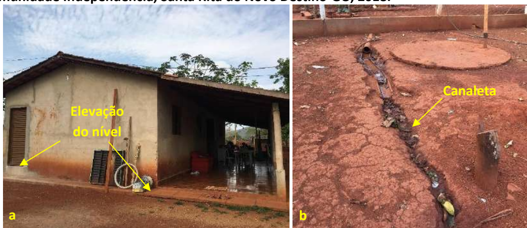
Foto 6.21 – Dispositivos de prevenção dos danos provocados pelas águas em residência (a) e lote (b) da Comunidade Independência, Santa Rita do Novo Destino-GO, 2018.
