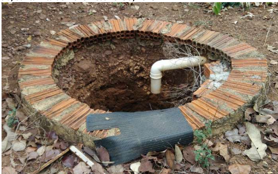
Foto 6.9 – Situação construtiva da fossa negra/rudimentar sem cobertura, na Comunidade Independência, Santa Rita do Novo Destino-GO, 2018.
