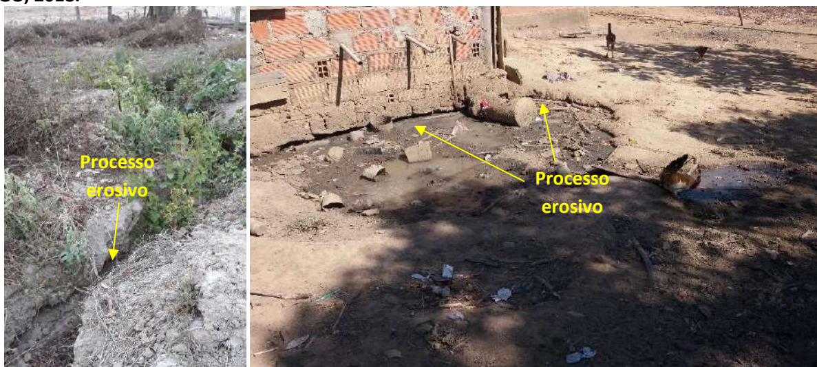
Foto 6.21 – Processos erosivos em lotes da Comunidade Gustavo Martins, São Miguel do Araguaia-GO, 2018.
