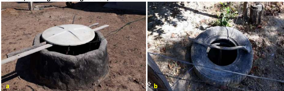
Foto 6.3 – Poço com tampa de plástico (a) e poço com estrutura de pneu (b), Comunidade Gustavo Martins, São Miguel do Araguaia-GO, 2018.
