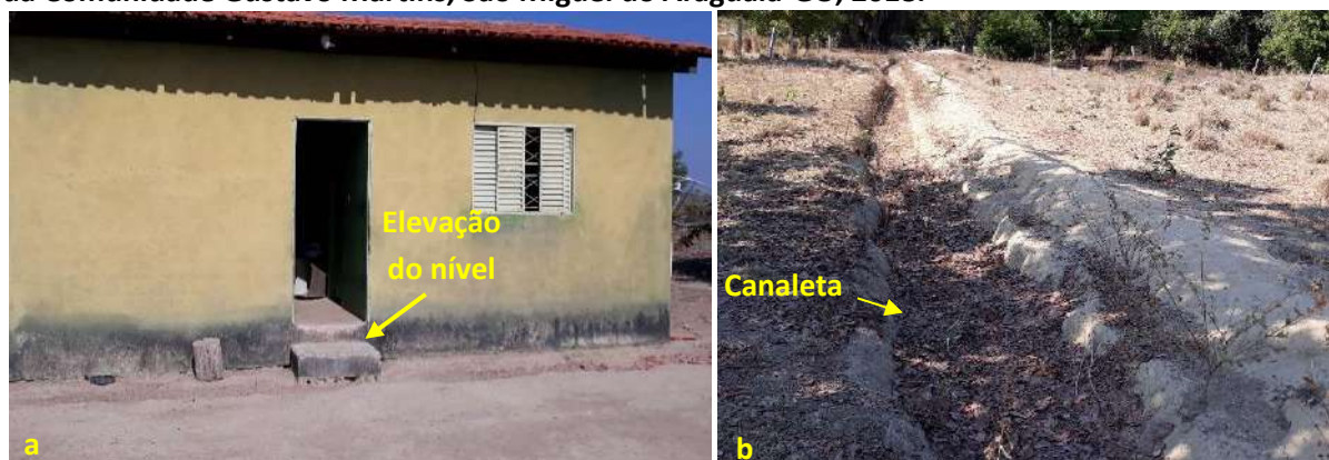
Foto 6.20 – Dispositivos de prevenção dos danos provocados pelas águas em residência (a) e lote (b) da Comunidade Gustavo Martins, São Miguel do Araguaia-GO, 2018.
