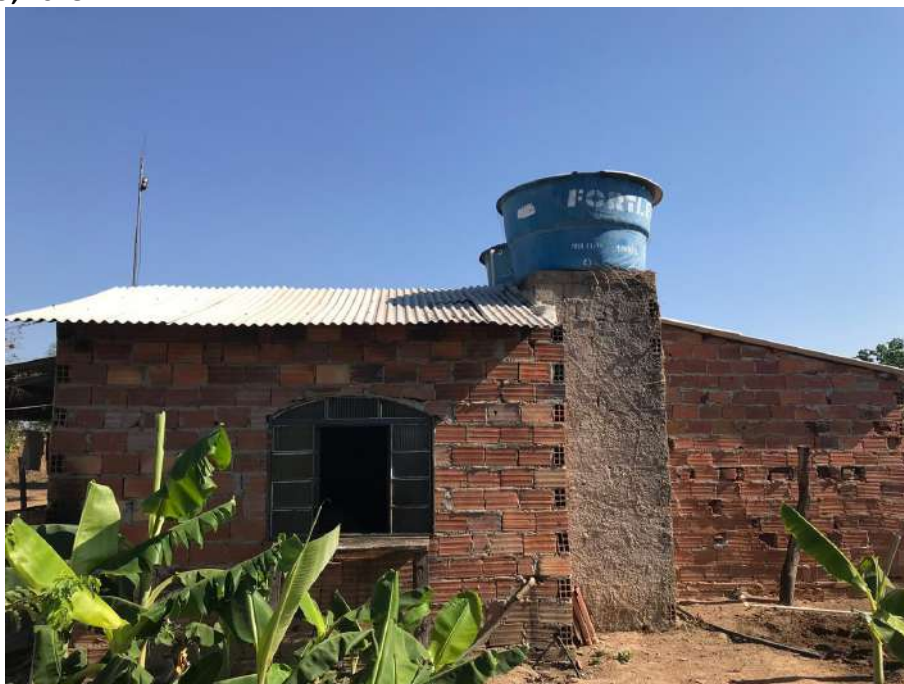
Foto 4.11 – Cobertura de fibrocimento, identificada na Comunidade Gustavo Martins, São Miguel do Araguaia-GO, 2018.
