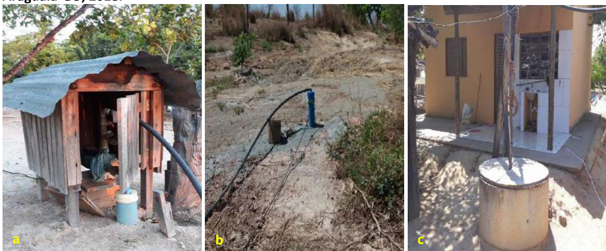
Foto 6.1 – Tipos de poços utilizados para a captação de água destinada à ingestão: poço tubular raso (a), poço tubular profundo (b), poço raso escavado (c), Comunidade Gustavo Martins, São Miguel do Araguaia-GO, 2018.
