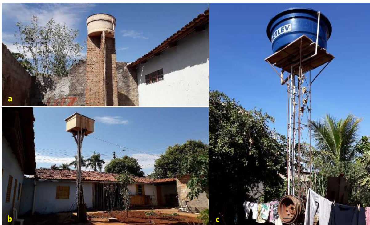
Foto 6.5 – Reservatório domiciliar instalado sobre estrutura em alvenaria (a), sobre estrutura de madeira (b) e outro sobre estrutura metálica (c), na Comunidade Goianinha, Palmeiras de Goiás-GO, 2019.
