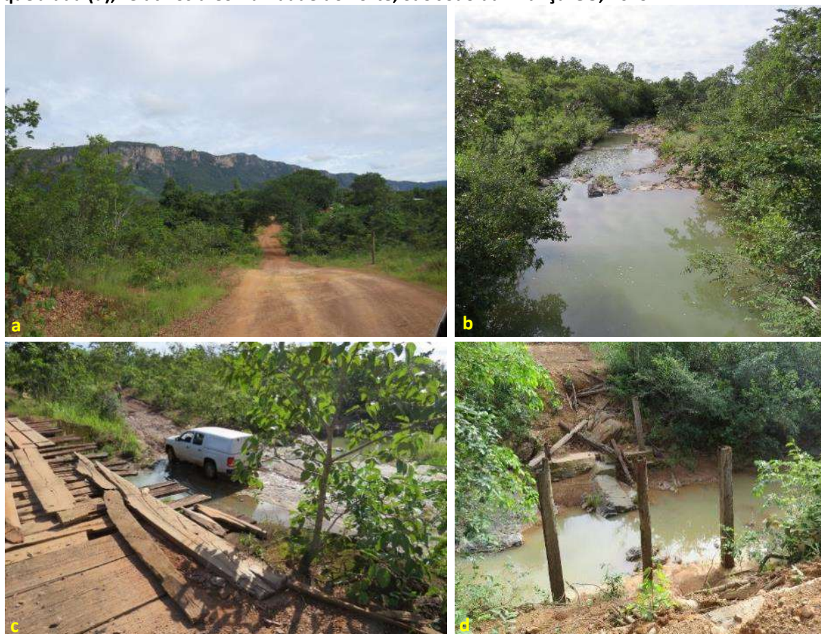
Foto 6.17 – Via de acesso (a); curso d'água (b); ponte de madeiras sem manutenção (c), e ponte quebrada (d), relativos à Comunidade do Forte, São João da Aliança-GO, 2019.
