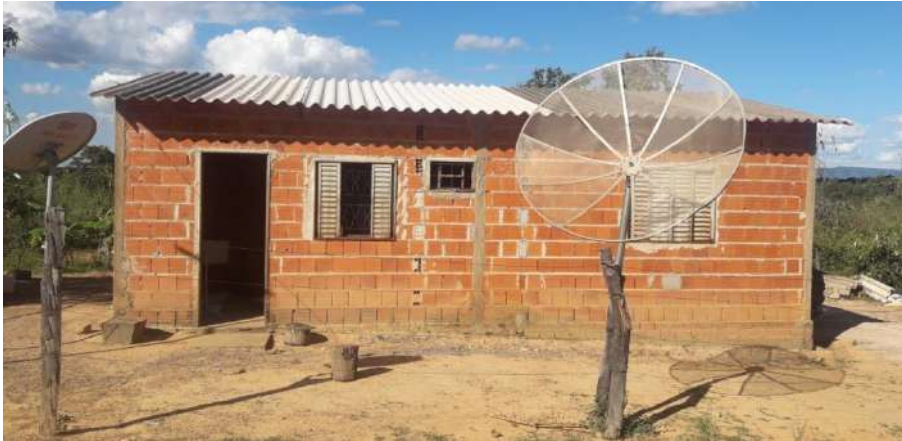
Foto 4.9 – Habitação construída de alvenaria sem reboco, identificada na Comunidade do Forte, São João da Aliança-GO, 2019.
