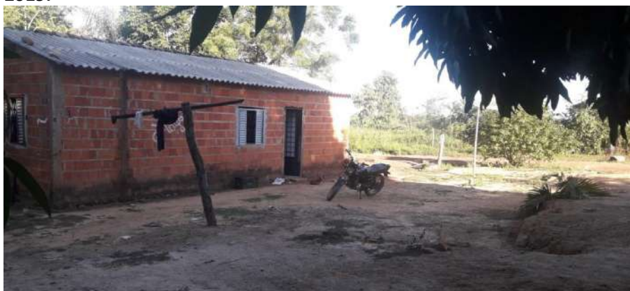
Foto 4.16 – Cobertura do tipo fibrocimento, identificada na Comunidade do Forte, São João da Aliança-GO, 2019.
