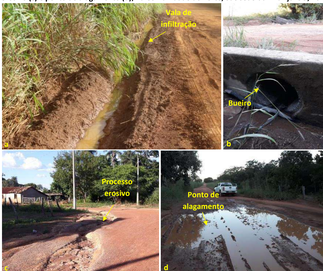
Foto 6.18 – Situação da drenagem pluvial na via de acesso: vala de infiltração (a); bueiro (b); processo erosivo (c) e ponto de alagamento (d), na Comunidade do Forte, São João da Aliança-GO, 2019.
