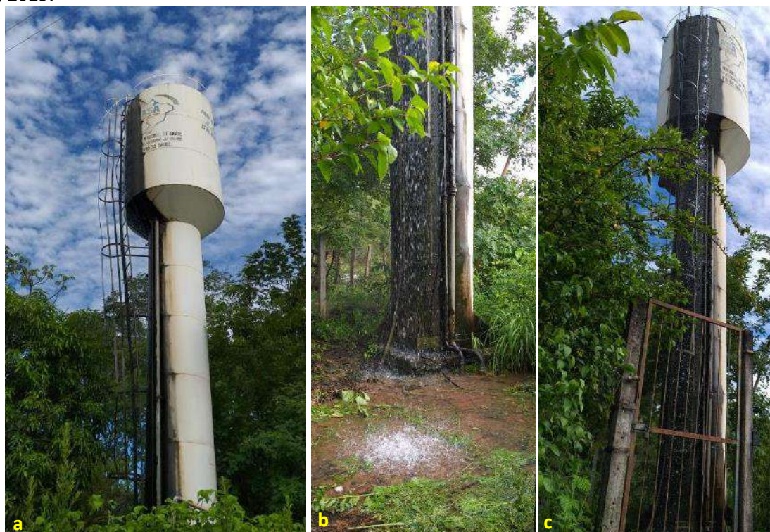
Foto 6.3 – Reservatório tipo Taça, de material metálico em situação de extravasamento (a), com presença de lodo em sua base (b) e na sua lateral (c), na Comunidade do Forte, São João da Aliança-GO, 2019.
