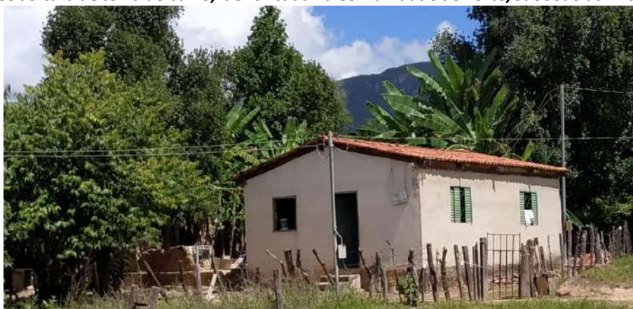
Foto 4.15 – Cobertura de telha de barro, identificada na Comunidade do Forte, São João da Aliança-GO, 2019.
