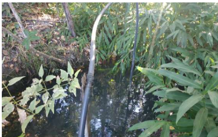
Foto 6.2 – Fontes de abastecimento de água nascente, mina ou bica na Comunidade Fortaleza, Piranhas-GO, 2018.
