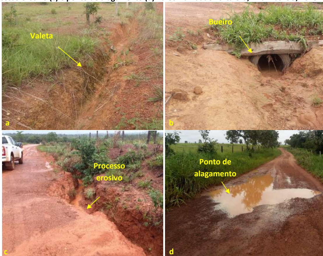
Foto 6.19 – Situação da drenagem pluvial na via de acesso: valeta de infiltração (a), bueiro (b), processo erosivo (c) e ponto de alagamento (d) na Comunidade Fortaleza, Piranhas-GO, 2018.
