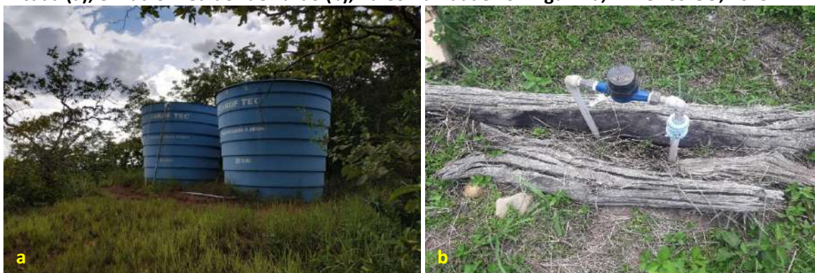
Foto 6.3 – Componentes do SAA, sistema de reservação R1 constituído por dois reservatórios de 20 m 3 cada (a), e macro medidor de vazão (b), na Comunidade Formiguinha, Mineiros-GO, 2019.
