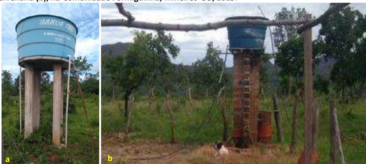
Foto 6.5 – Reservatório instalado sobre estrutura de concreto (a) e outro sobre estrutura de alvenaria (b), na Comunidade Formiguinha, Mineiros-GO, 2019.
