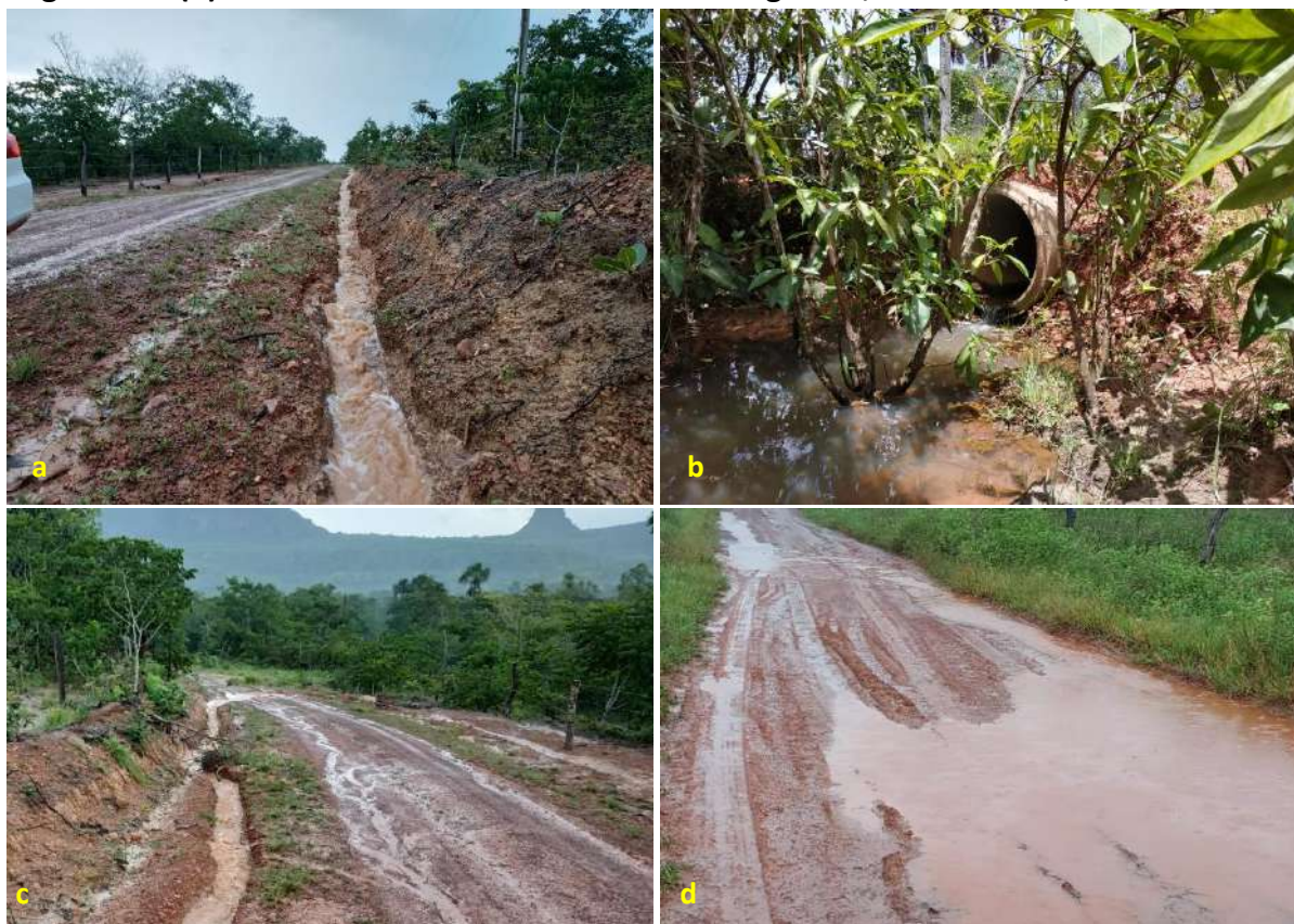
Foto 6.16 – Valeta (a), bueiro (b), processos erosivos na via e nas margens (c) e ponto de alagamento (d) na via de acesso à Comunidade Formiguinha, Mineiros-GO, 2019.
