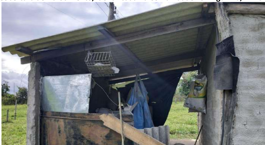
Foto 4.10 – Cobertura de fibrocimento, identificada na Comunidade Formiguinha, Mineiros-GO, 2019.
