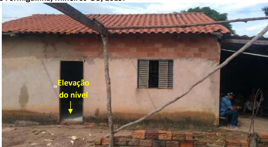
Foto 6.19 – Dispositivo de prevenção dos danos provocados pelas águas em residência da Comunidade Formiguinha, Mineiros-GO, 2019.
