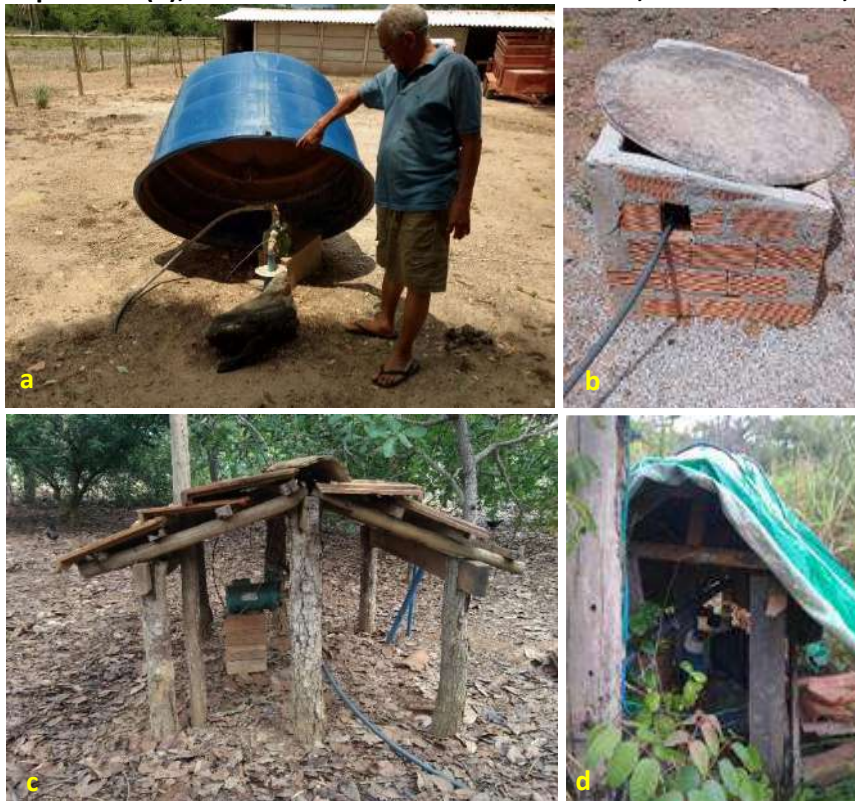
Foto 6.2 – Poço tubular raso protegido por reservatório (a), estrutura em alvenaria (b), ou coberto por telhas (c) ou por lona (d), na Comunidade Florestan Fernandes, Nova Crixás-GO, 2018.
