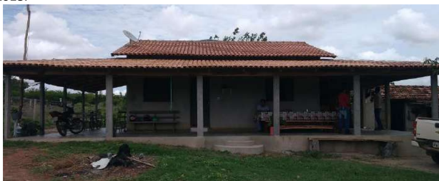
Foto 4.13 – Cobertura de telha de barro, identificada na Comunidade Florestan Fernandes, Nova Crixás-GO, 2018.
