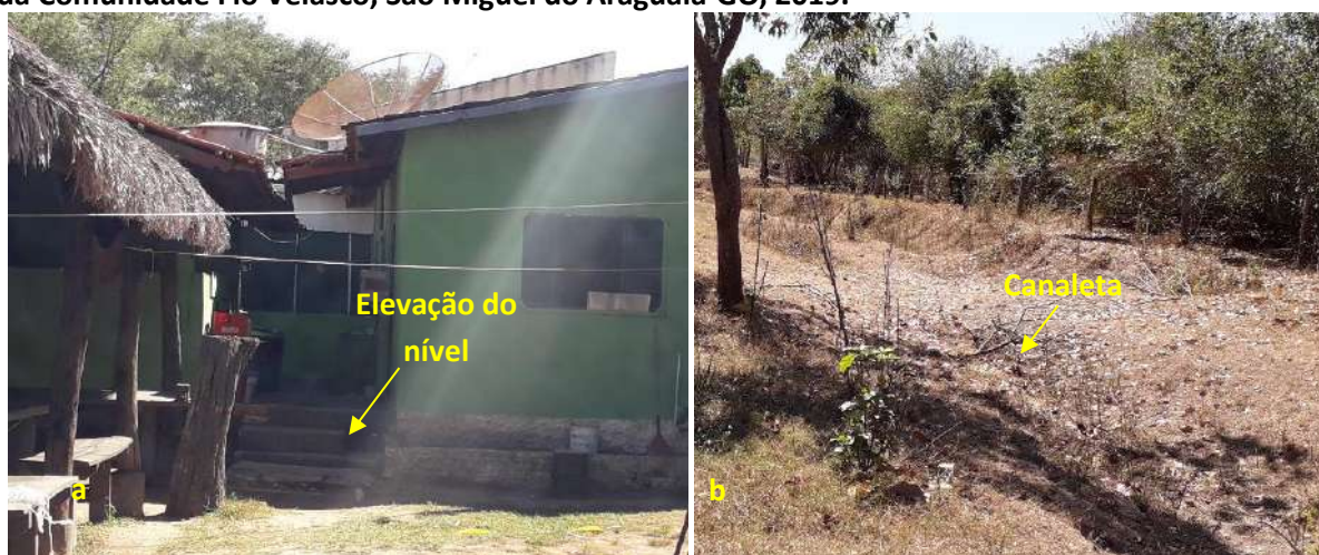
Foto 6.19 – Dispositivos de prevenção dos danos provocados pelas águas em residência (a) e lote (b) da Comunidade Fio Velasco, São Miguel do Araguaia-GO, 2019.
