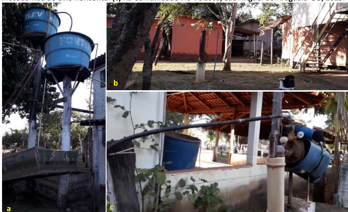
Foto 6.3 – Reservatórios de distribuição R3 e R4 (a), Poço tubular profundo (b) e conjunto motobomba de eixo horizontal (c) na Comunidade Fio Velasco, São Miguel do Araguaia-GO, 2019.
