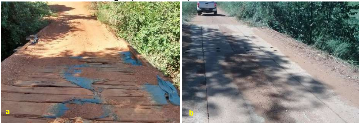
Foto 6.19 – Pontes sobre o ribeirão Maranhão (a) e sobre o córrego Forquilha (b), na Comunidade da Fazenda Santo Antônio da Laguna, Barro Alto-GO, 2019.
