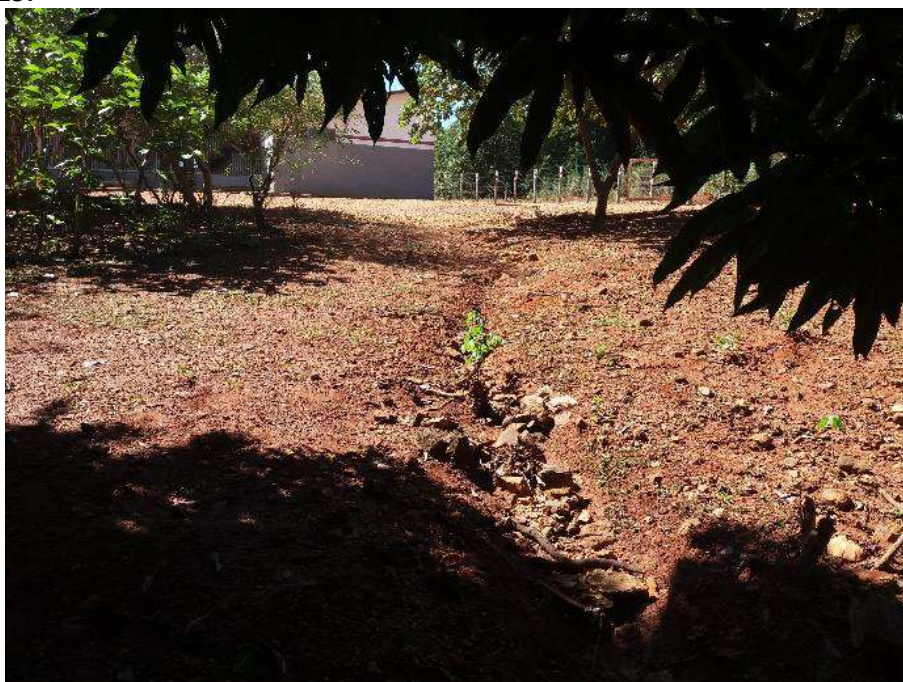
Foto 6.26 – Processo erosivo em lote da Comunidade da Fazenda Santo Antônio da Laguna, Barro Alto-GO, 2019.
