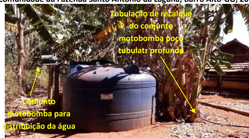
Foto 6.9 – Reservatório em polietileno de 10m 3 , utilizado para armazenar água do poço tubular profundo, na Comunidade da Fazenda Santo Antônio da Laguna, Barro Alto-GO, 2019.
