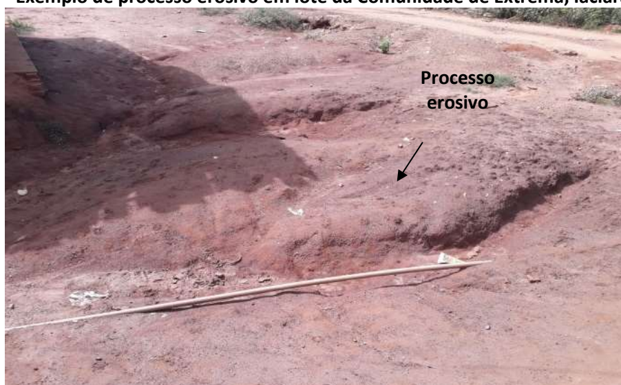
Foto 6.17 – Exemplo de processo erosivo em lote da Comunidade de Extrema, Iaciara-GO, 2019.
