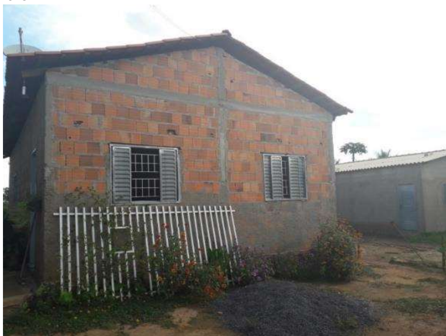
Foto 4.9 – Habitação construída de alvenaria sem reboco, identificada na Comunidade de Extrema, Iaciara-GO, 2019.
