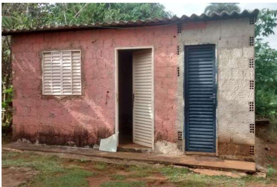
Foto 4.16 – Cobertura do tipo fibrocimento, identificada na Comunidade de Extrema, Iaciara-GO, 2019.
