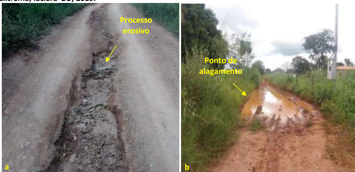
Foto 6.14 – Processo erosivo(a) e ponto de alagamento (b) na via de acesso à Comunidade de Extrema, Iaciara-GO, 2019.
