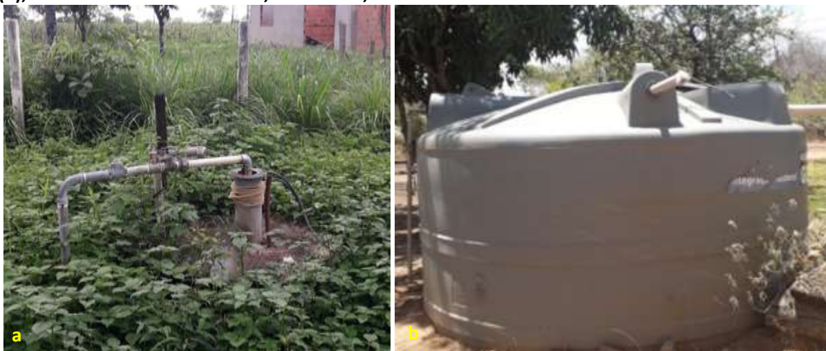
Foto 6.1 – Fontes de abastecimento de água, sendo o poço tubular profundo do SAA (a) e Cisterna (b), na Comunidade de Extrema, Iaciara-GO, 2019.
