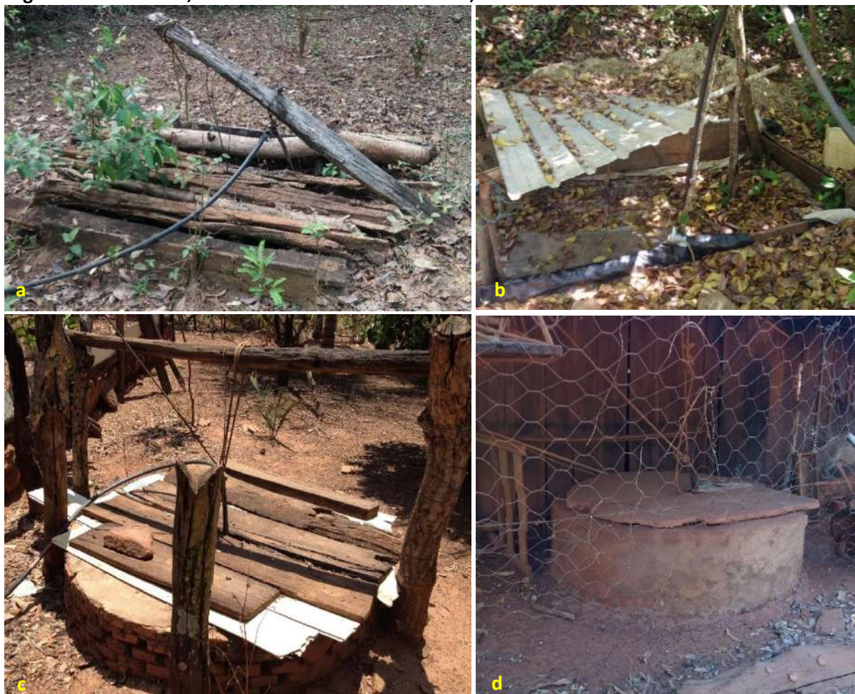
Foto 6.4 – Poço escavado com tampa e mureta de proteção feita com madeira (a), coberto com telha de zinco(b), forro PVC e madeira (c), e outro localizado dentro do galinheiro (d), na Comunidade Engenho da Pontinha, Santa Rita do Novo Destino-GO, 2018.
