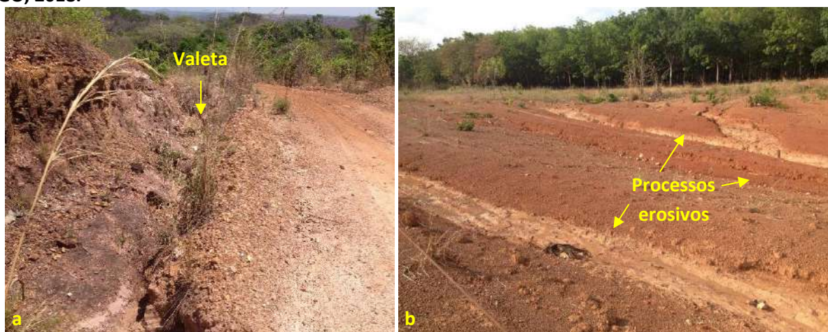
Foto 6.17 – Situação da drenagem pluvial na via de acesso: valeta de infiltração (a) e processos erosivos (b) nas vias de acesso da Comunidade Engenho da Pontinha, Santa Rita do Novo Destino-GO, 2018.
