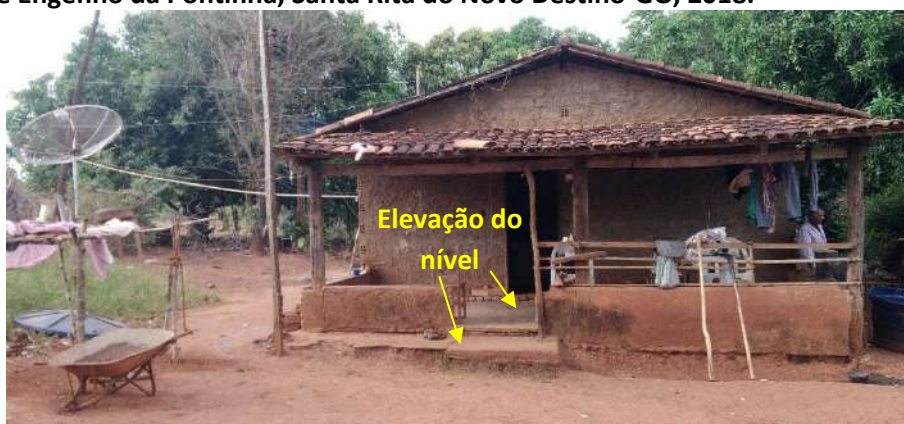
Foto 6.21 – Dispositivo de prevenção dos danos provocados pelas águas, em residência da Comunidade Engenho da Pontinha, Santa Rita do Novo Destino-GO, 2018.
