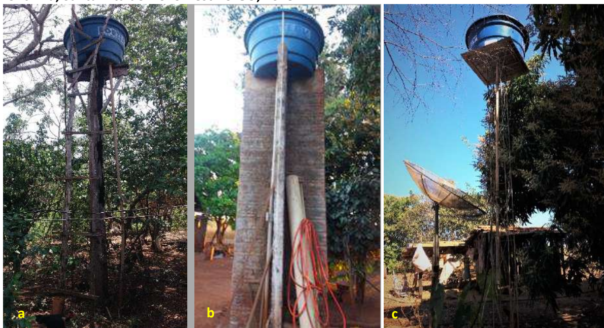
Foto 6.7 – Reservatório domiciliar instalado sobre estrutura feita em madeira (a), em alvenaria (b), e outro instalado sobre estrutura feita em material metálico (c), na Comunidade Engenho da Pontinha, Santa Rita do Novo Destino-GO, 2018.
