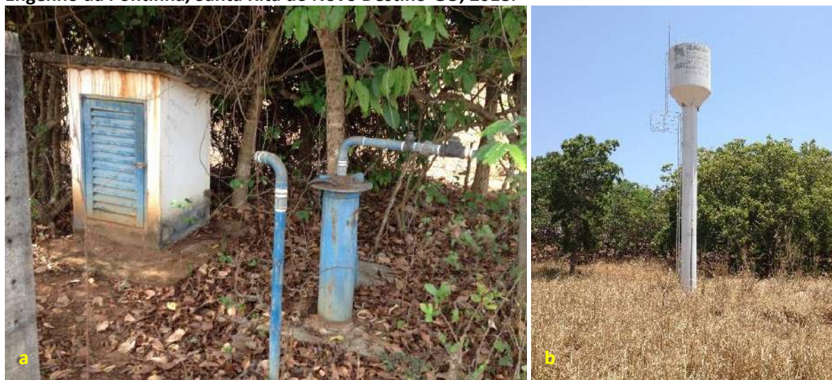
Foto 6.2 – Poço tubular profundo (a) e reservatório de distribuição (b) desativados, na Comunidade Engenho da Pontinha, Santa Rita do Novo Destino-GO, 2018.
