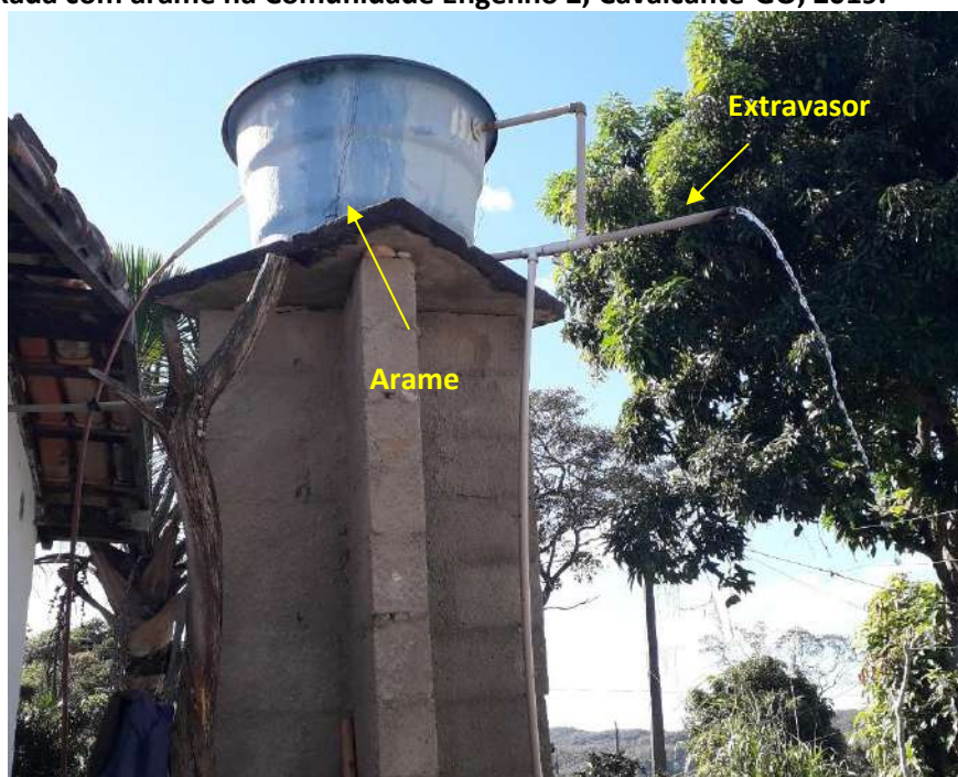
Foto 6.5 – Reservatório de polietileno com presença de extravasor, instalado sobre estrutura de alvenaria e fixada com arame na Comunidade Engenho 2, Cavalcante-GO, 2019.
