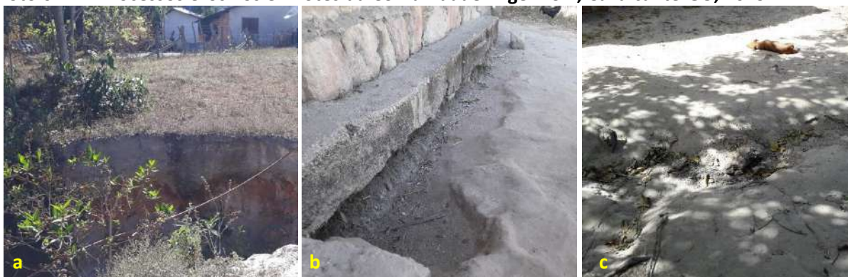
Foto 6.22 – Processos erosivos em lotes da Comunidade Engenho 2, Cavalcante-GO, 2019.
