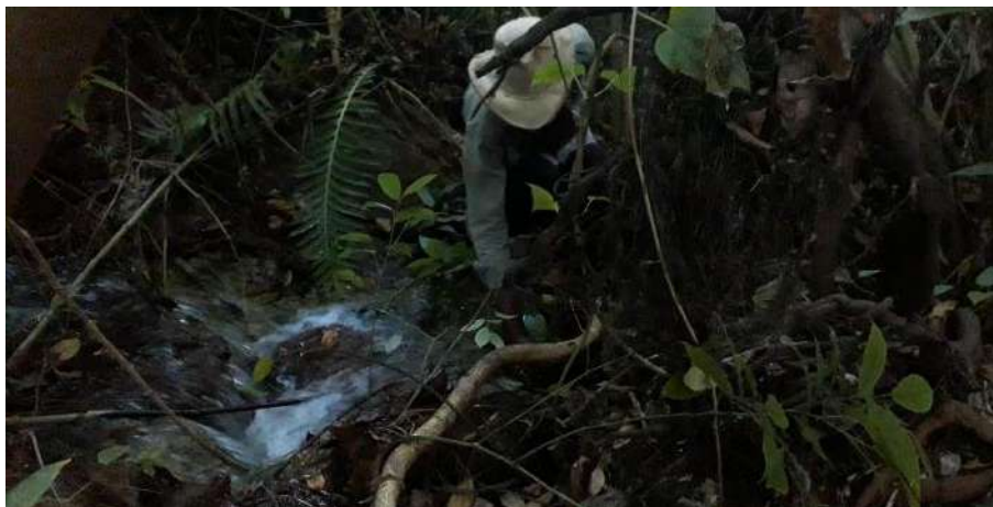
Foto 6.4 – Captação na nascente do rio Comundango, na Comunidade Engenho 2, Cavalcante-GO, 2019.
