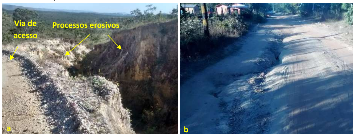
Foto 6.18 – Processos erosivos na margem (a) e na via de acesso (b) à Comunidade Engenho 2, Cavalcante-GO, 2019.
