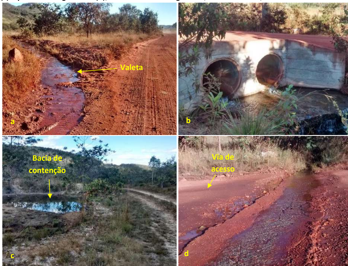
Foto 6.17 – Situação da drenagem pluvial na via de acesso: valeta (a), bueiro (b), bacia de contenção (c) e ponto de alagamento (d), na Comunidade Engenho 2, Cavalcante-GO, 2019.
