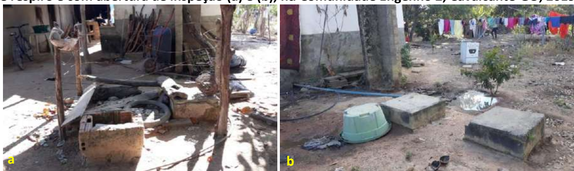
Foto 6.7 – Situações construtivas das fossas sépticas com tampa de concreto armado, sem tubulação de respiro e com abertura de inspeção (a) e (b), na Comunidade Engenho 2, Cavalcante-GO, 2019.
