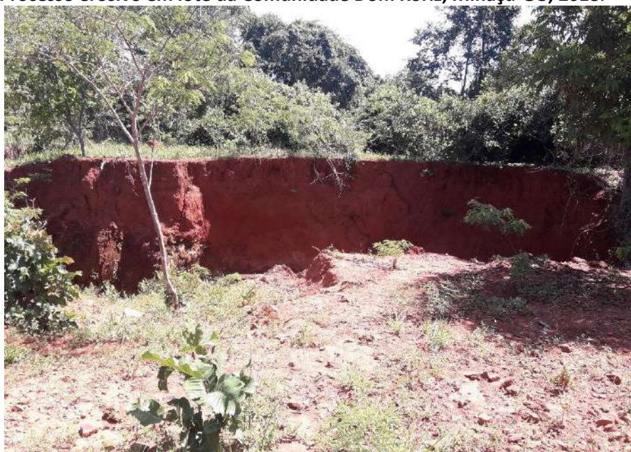
Foto 6.23 – Processo erosivo em lote da Comunidade Dom Roriz, Minaçu-GO, 2018.
