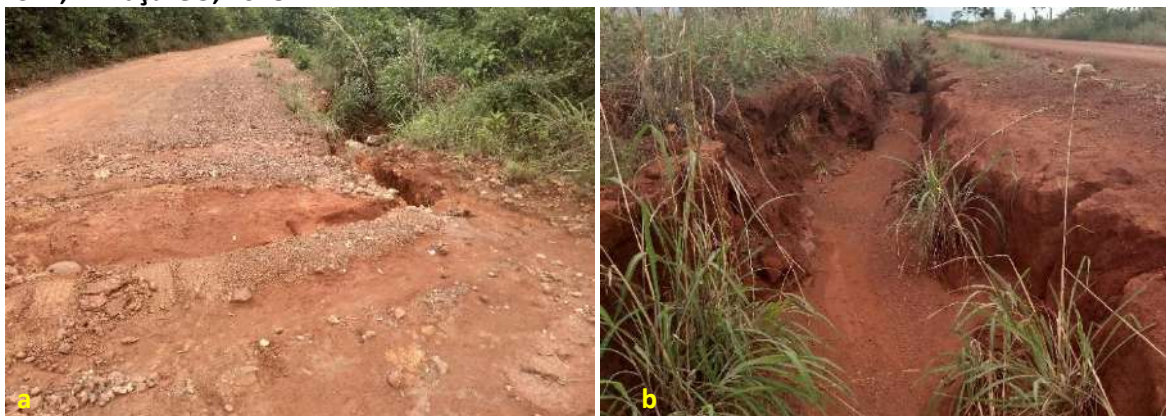
Foto 6.16 – Processos erosivos na via (a) e nas margens da via de acesso (b) à Comunidade Dom Roriz, Minaçu-GO, 2018.
