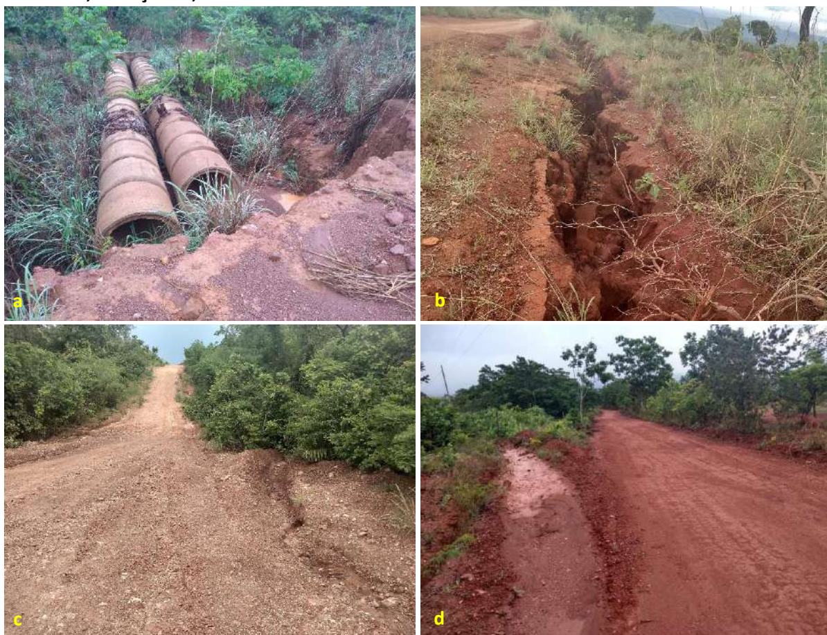
Foto 6.15 – Bueiro (a), valeta erodida (b) e valas de infiltração (c) e (d) na via de acesso à Comunidade Dom Roriz, Minaçu-GO, 2018.
