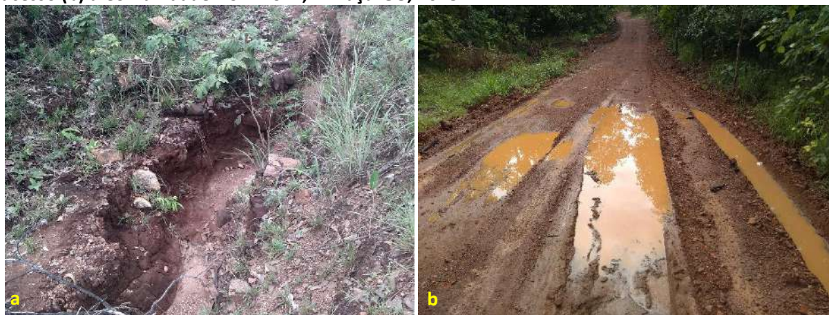
Foto 6.17 – Processos erosivos nas margens da via de acesso (a) e ponto de alagamento na via de acesso (b) à Comunidade Dom Roriz, Minaçu-GO, 2018.
