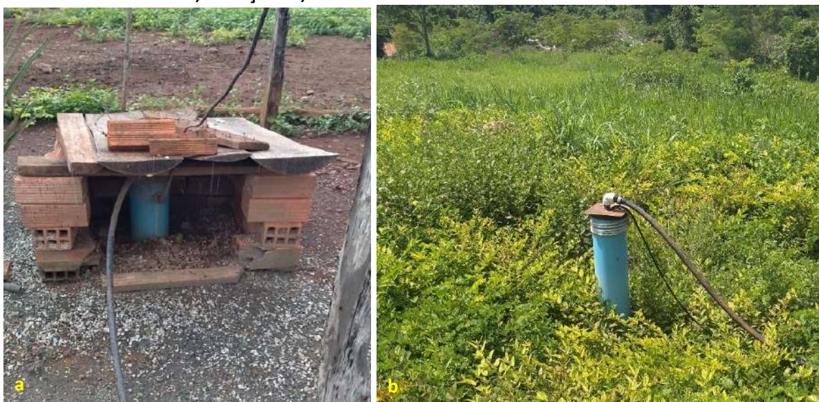
Foto 6.3 – Poço tubular profundo: em abrigo de tijolos (a); sem dispositivos de proteção (b), na Comunidade Dom Roriz, Minaçu-GO, 2018.
