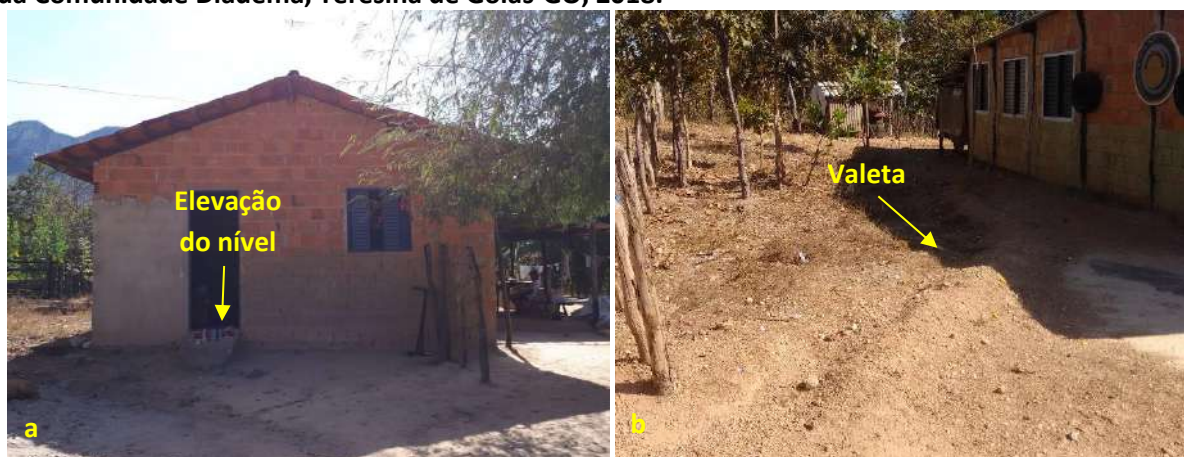
Foto 6.21 – Dispositivos de prevenção dos danos provocados pelas águas em residência (a) e lote (b) da Comunidade Diadema, Teresina de Goiás-GO, 2018.
