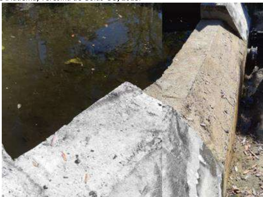
Foto 6.2 – Captação de água do SAA, composta por barragem de regularização de nível, na Comunidade Diadema, Teresina de Goiás-GO, 2018.
