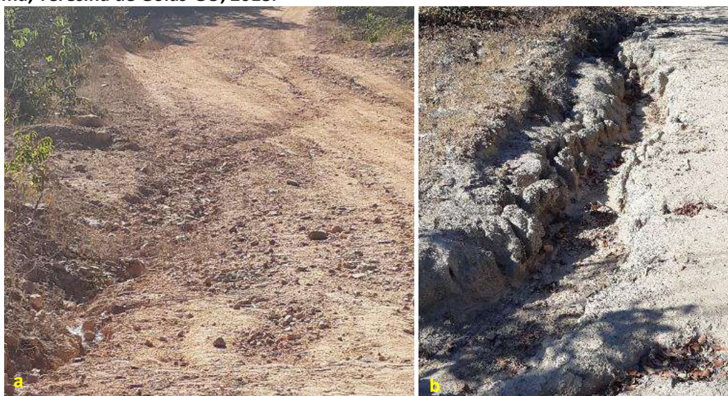
Foto 6.18 – Processos erosivos na via de acesso (a) e na margem da via de acesso (b), na Comunidade Diadema, Teresina de Goiás-GO, 2018.
