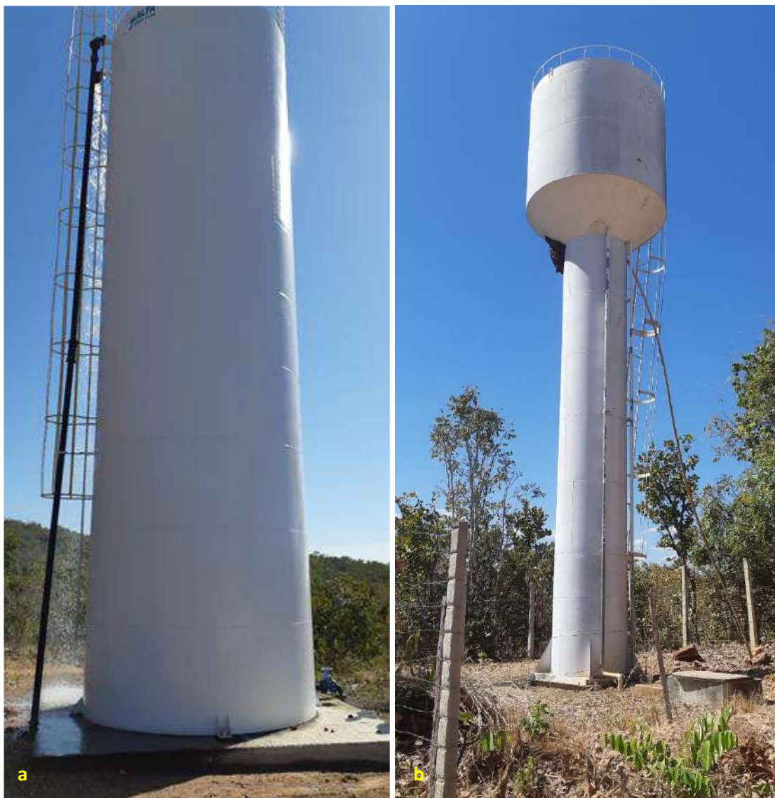
Foto 6.4 – Reservatório de distribuição do tipo charuto, atualmente utilizado pelo SAA (a), e reservatório de distribuição do tipo taça desativado (b), na Comunidade Diadema, Teresina de Goiás-GO, 2018.
