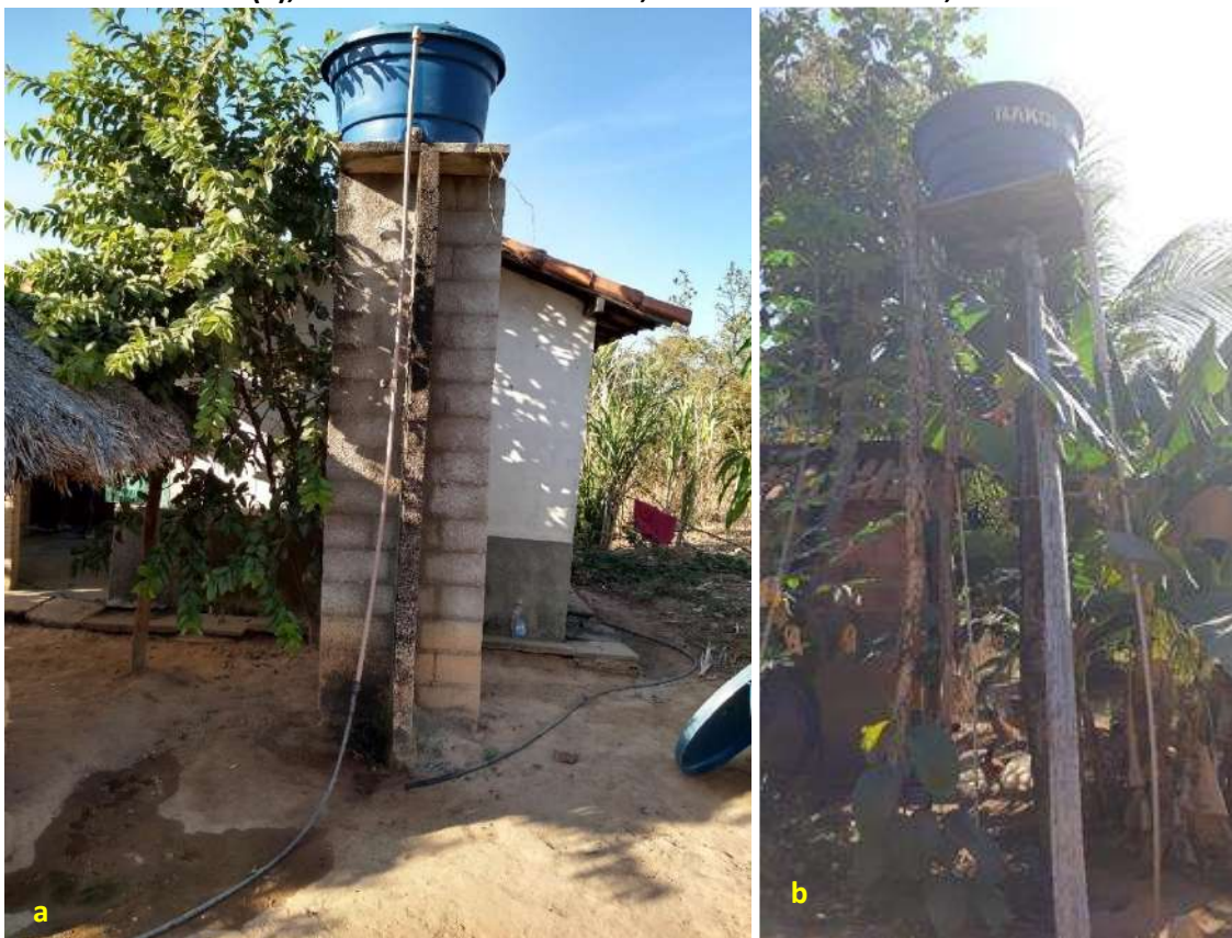
Foto 6.6 – Reservatório de polietileno instalado sobre estrutura de alvenaria (a) e outro sobre estrutura de madeira (b), na Comunidade Diadema, Teresina de Goiás-GO, 2018.
