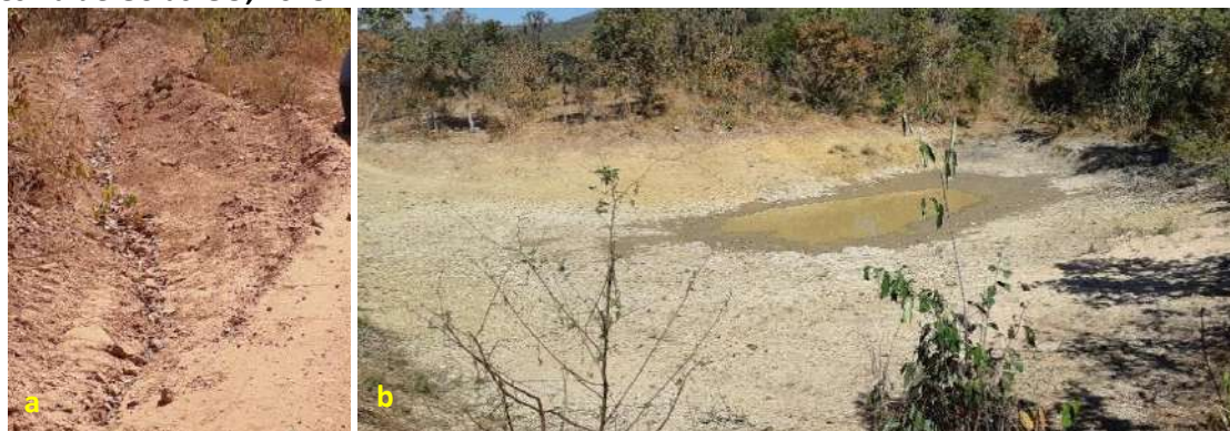
Foto 6.17 – Vala de infiltração (a) e bacia de contenção (b) na via de acesso à Comunidade Diadema, Teresina de Goiás-GO, 2018.
