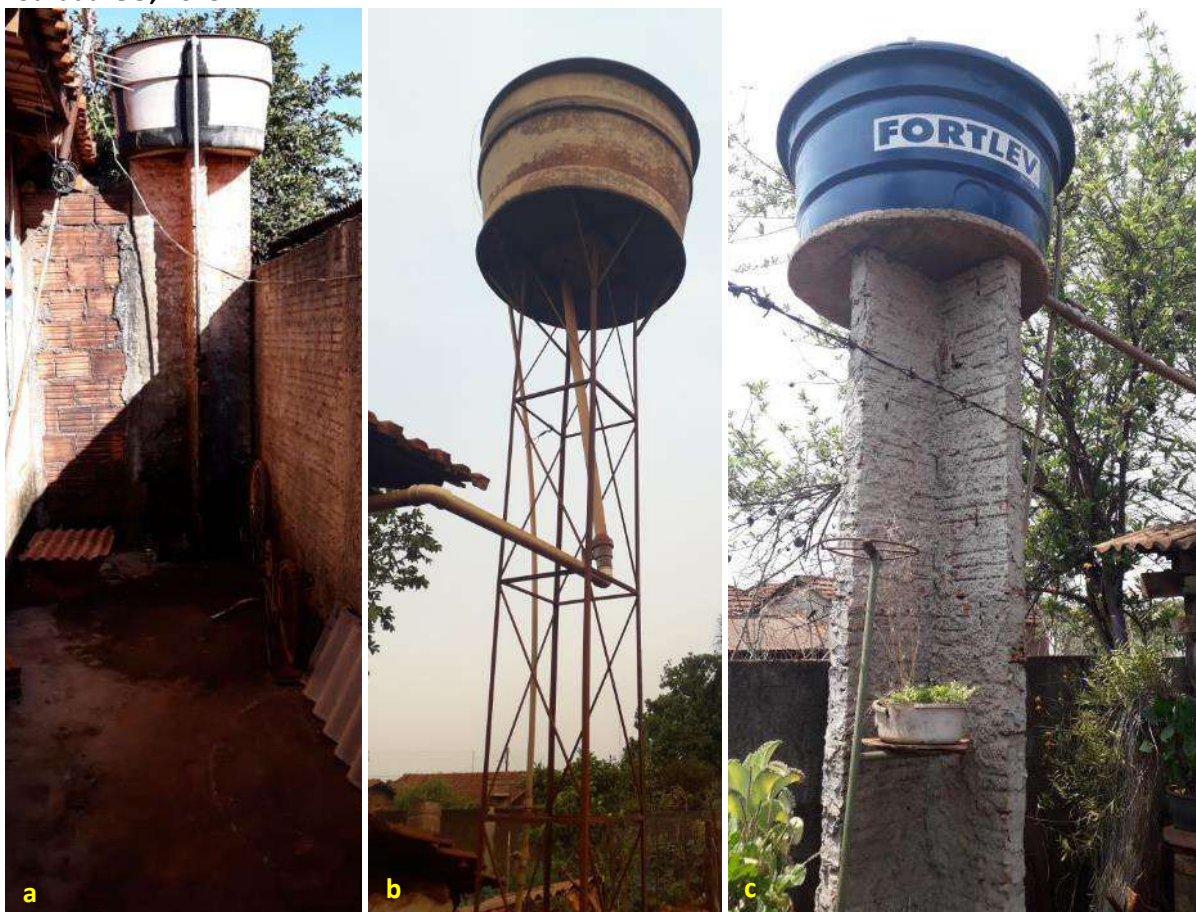
Foto 6.13 – Reservatório de fibrocimento instalado sobre estrutura de alvenaria (a) e metálica (b) e de polietileno sobre estrutura de alvenaria (c), Comunidade Córrego do Inhambú, Cachoeira Dourada-GO, 2019.
