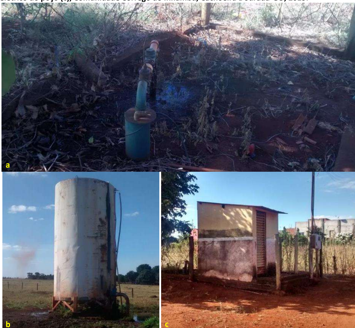
Foto 6.7 – Sistema de Abastecimento do distrito de Almerindonópolis, composto por poço tubular profundo F2 (a), reservatório apoiado R4 (b) e estrutura de alvenaria para proteção do sistema elétrico do poço (c), Comunidade Córrego do Inhambú, Cachoeira Dourada-GO, 2019.
