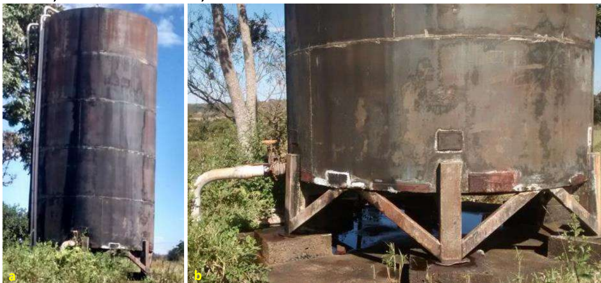
Foto 6.3 – Reservatório elevado localizado no aglomerado rural de Nilópolis (a), com vazamento no registro de saída e acumulação de água na base do reservatório (b), na Comunidade Córrego do Inhabú, Cachoeira Dourada-GO, 2019.
