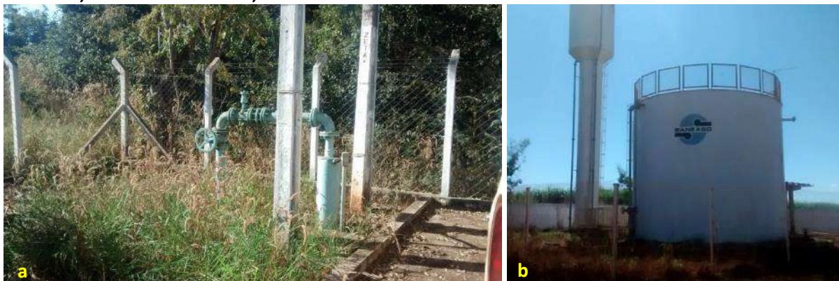
Foto 6.6 – Novo sistema de abastecimento do distrito de Almerindonópolis composto por poço tubular profundo F4 (a) e reservatórios apoiados e elevados R5 (b), Comunidade Córrego do Inhambú, Cachoeira Dourada, 2019.
