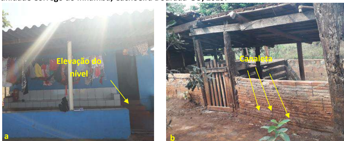
Foto 6.31 – Dispositivos de prevenção dos danos provocados pelas águas (a) e (b) nas residências da Comunidade Córrego do Inhambú, Cachoeira Dourada-GO, 2019.
