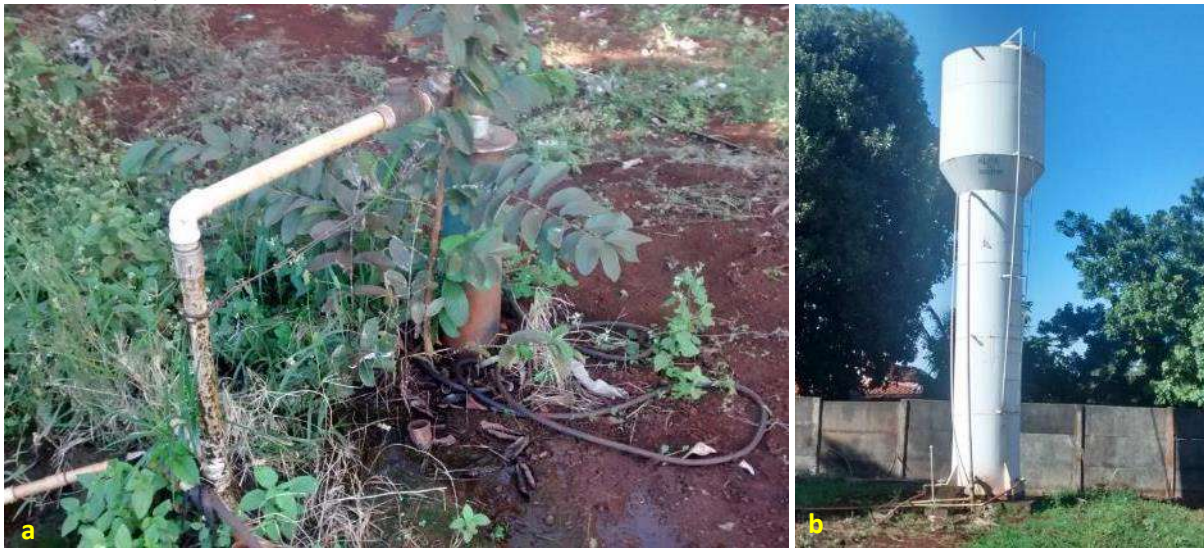
Foto 6.8 – Sistema de abastecimento do distrito Almerindonópolis, composto por poço tubular profundo F3(a) e reservatório apoiado R3 (b) na Comunidade Córrego do Inhambú, Cachoeira Dourada-GO, 2019.
