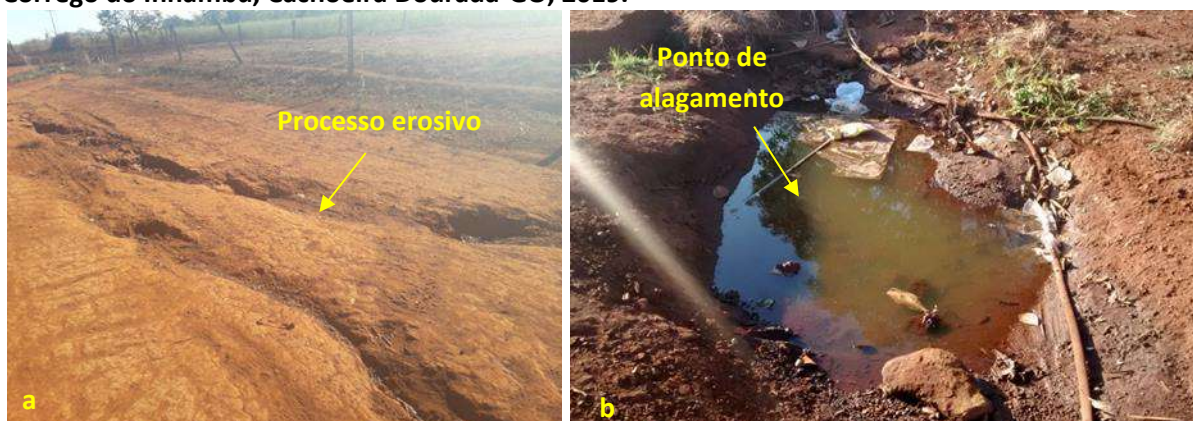
Foto 6.28 – Exemplo de processo erosivo (a) e ponto de alagamento (b) nas vias da Comunidade Córrego do Inhambú, Cachoeira Dourada-GO, 2019.
