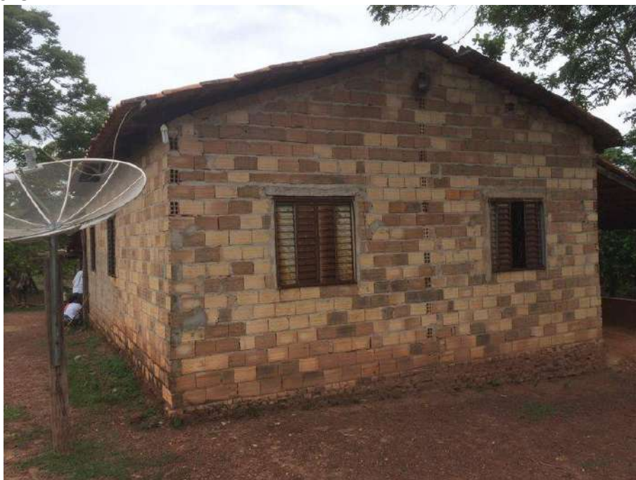
Foto 4.3 – Habitação construída de alvenaria sem reboco, identificada na Comunidade Cora Coralina, Faina-GO, 2018.
