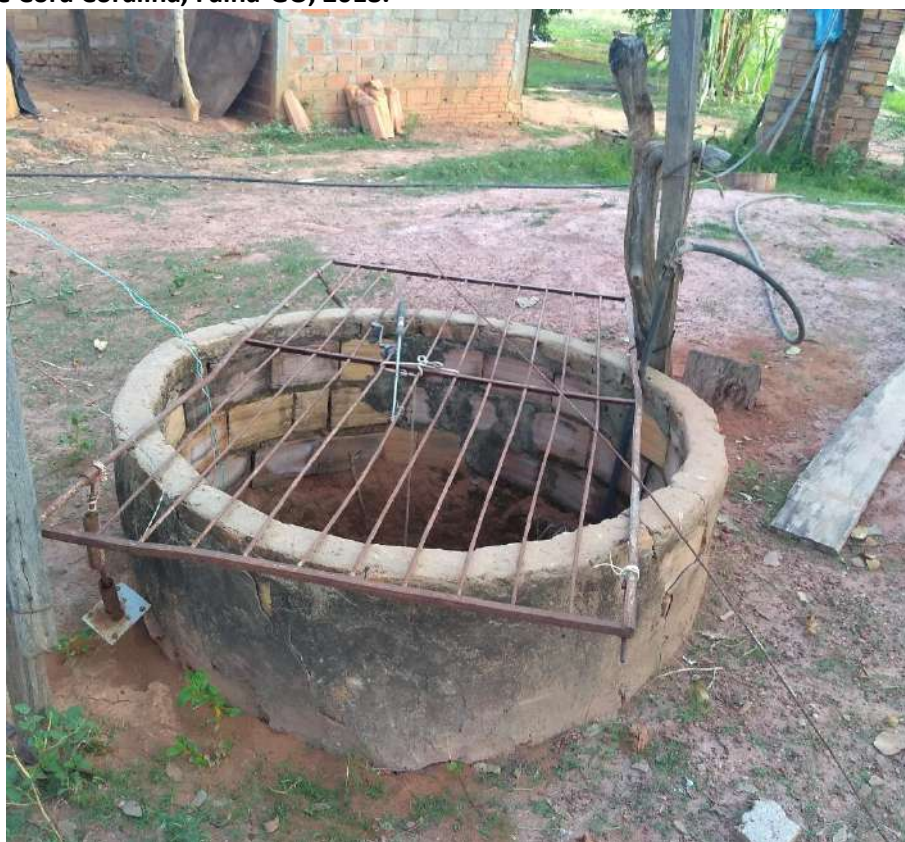
Foto 6.3 – Poço raso escavado tampado com material improvisado (parte de um portão metálico), Comunidade Cora Coralina, Faina-GO, 2018.
