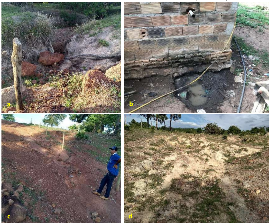
Foto 6.17 – Processos erosivos em lotes da Comunidade Cora Coralina, Faina-GO, 2018.
