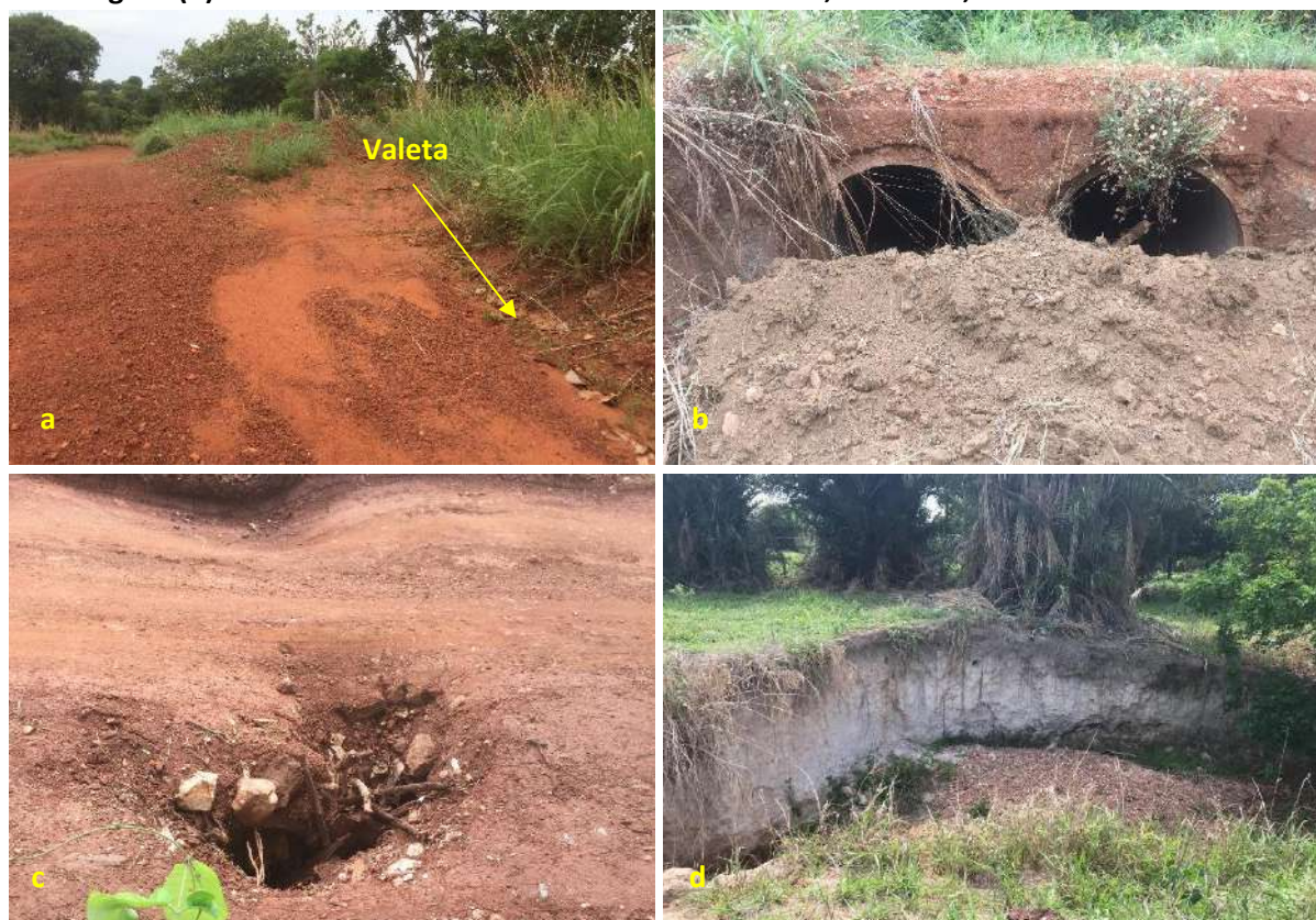
Foto 6.14 – Situação da drenagem pluvial: valeta (a), bueiro (b) e processos erosivos na pista (c) e nas margens (d) da via de acesso à Comunidade Cora Coralina, Faina-GO, 2018.
