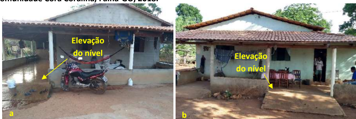
Foto 6.16 – Dispositivo de prevenção dos danos provocados pelas águas em residências da Comunidade Cora Coralina, Faina-GO, 2018.
