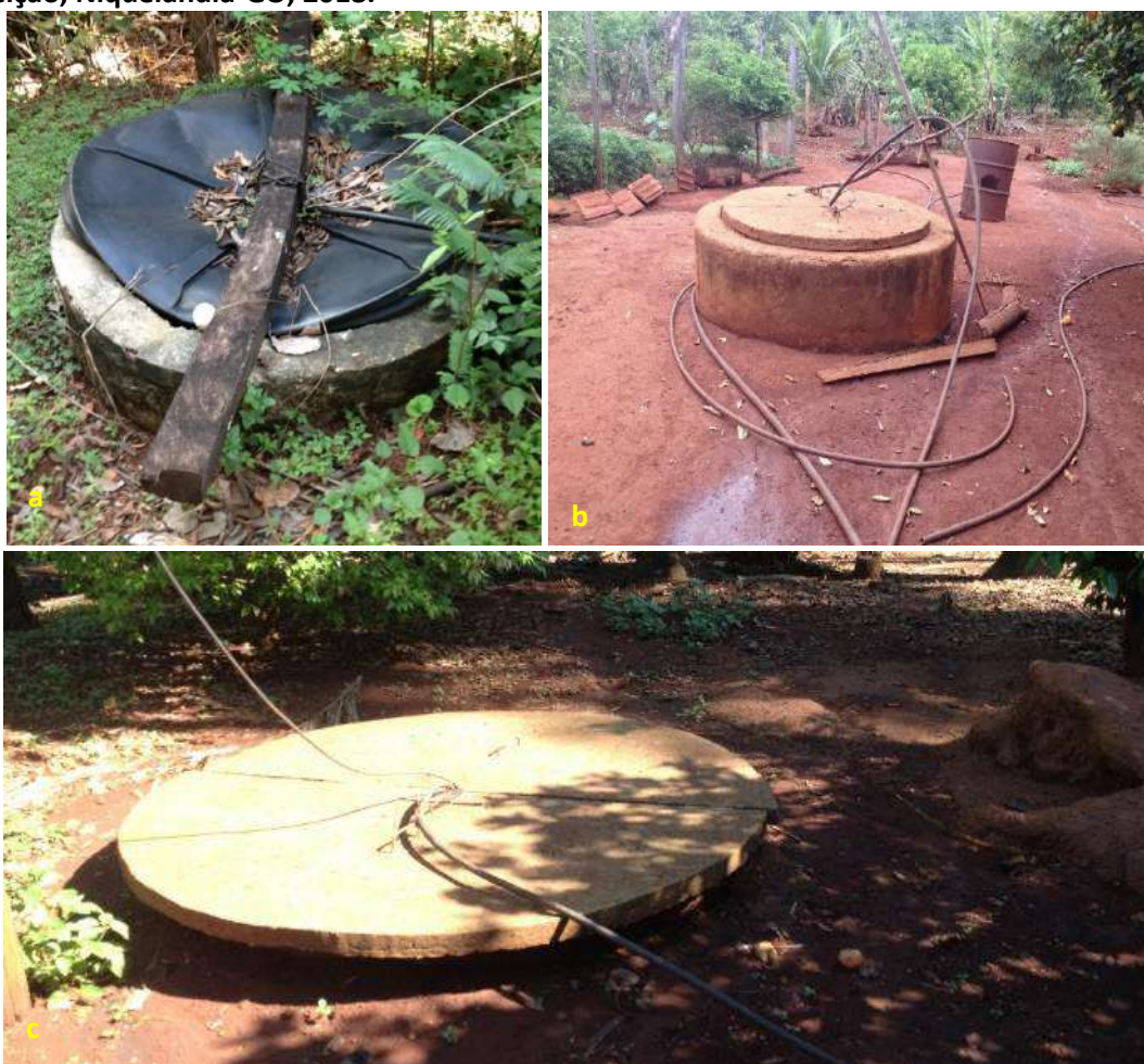
Foto 6.3 – Poço raso escavado: tampado de forma improvisada com tampa de plástico (a), com tampa de concreto (b) e sem calçamento no entorno, mureta e cerca de proteção (c) na Comunidade Conceição, Niquelândia-GO, 2018.
