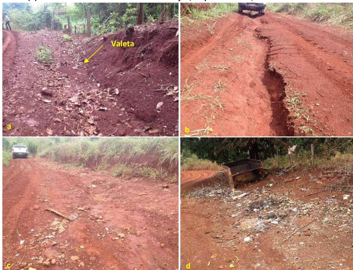
Foto 6.15 – Valeta (a), processos erosivos na via (b) e na margem (c) e ponto de descarte de resíduos sólidos (d) na via de acesso à Comunidade Conceição, Niquelândia-GO, 2018.
