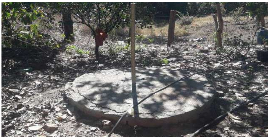
Foto 6.9 – Situações construtivas das fossas negras/rudimentares, com tampa de concreto armado e acima do nível do solo e com tubulação de respiro e sem vedação, na Comunidade Céu Azul, Minaçu-GO, 2018.
