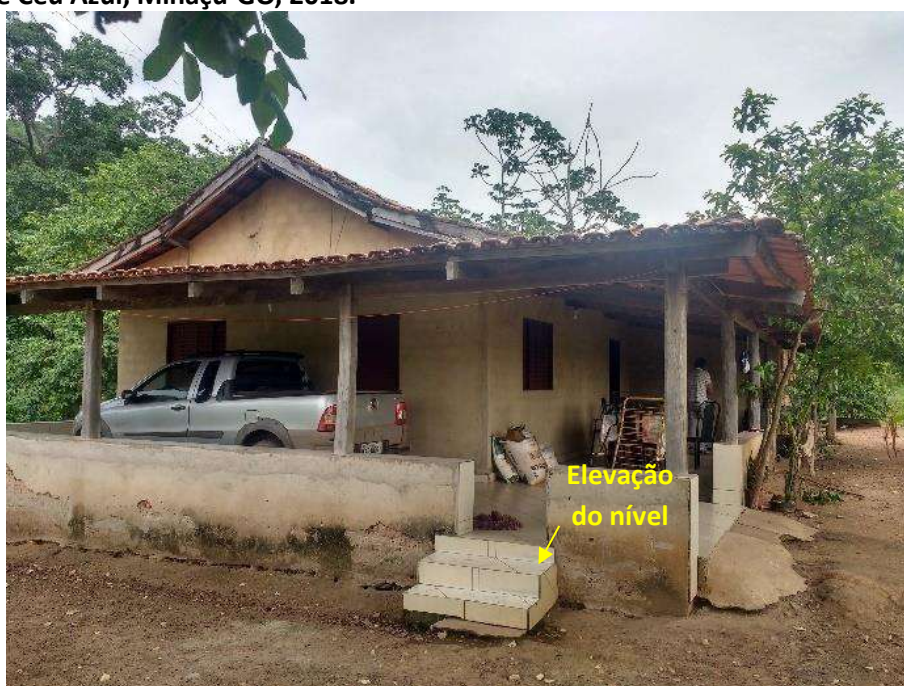
Foto 6.25 – Dispositivo de prevenção dos danos provocados pelas águas em residência da Comunidade Céu Azul, Minaçu-GO, 2018.
