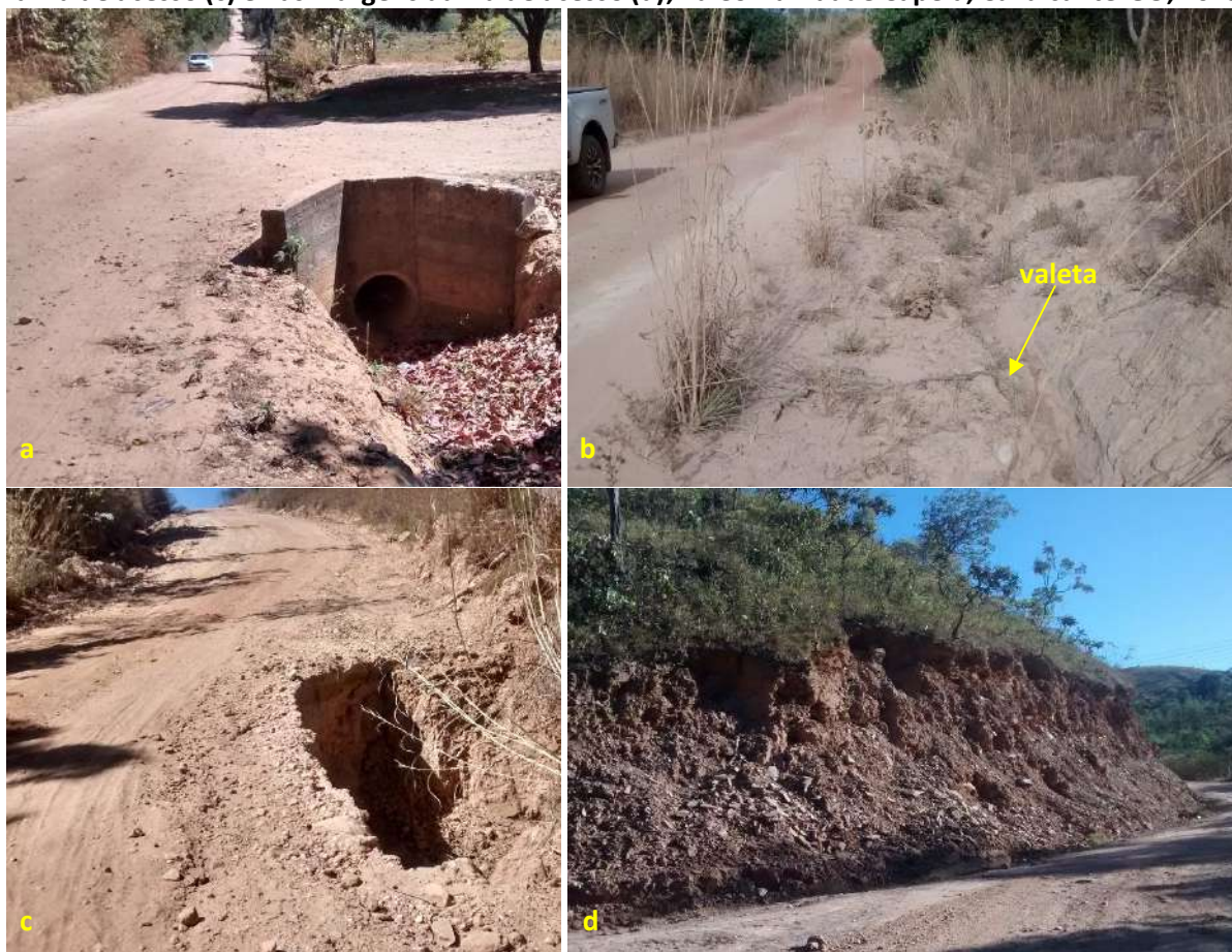
Foto 6.21 – Situação da drenagem pluvial na via de acesso: bueiro (a), valeta (b), processo erosivo na via de acesso (c) e nas margens da via de acesso (d), na Comunidade Capela, Cavalcante-GO, 2019.
