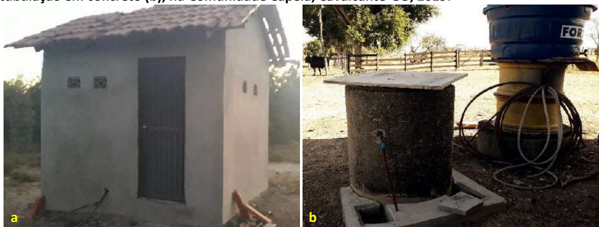
Foto 6.4 – Poço tubular raso protegido por estrutura em alvenaria (a) e outro protegido por tubulação em concreto (b), na Comunidade Capela, Cavalcante-GO, 2019.
