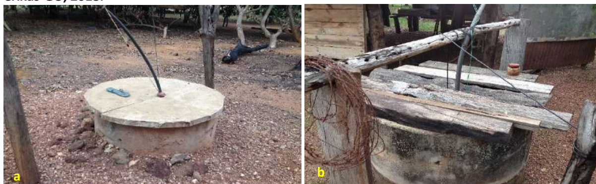
Foto 6.2 – Poço raso escavado com mureta de proteção e tampa de concreto (a) e poço raso escavado com mureta de proteção e tampado com pedaços de madeira (b), na Comunidade Cantoneiras, Nova Crixás-GO, 2018.
