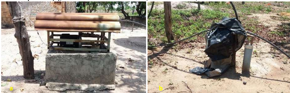
Foto 6.3 – Poço tubular raso com estrutura de proteção (a) e poço tubular raso protegido por material plástico (b), na Comunidade Cantoneiras, Nova Crixás-GO, 2018.
