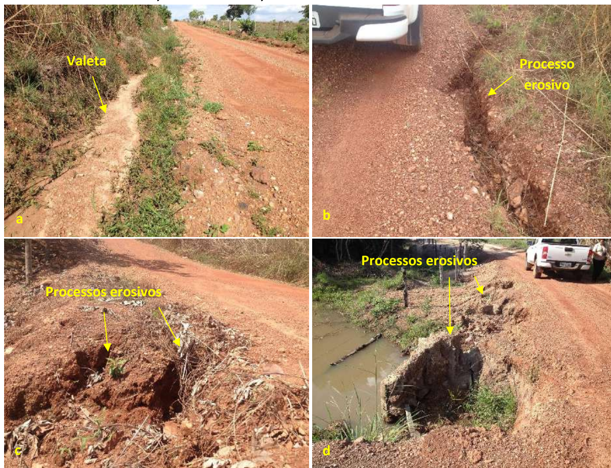
Foto 6.16 – Valeta (a) e processos erosivos na via (b) e nas margens da via de acesso (c) e (d) à Comunidade Cantoneiras, Nova Crixás-GO, 2018.
