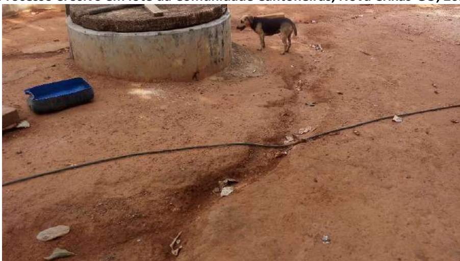
Foto 6.21 – Processo erosivo em lote da Comunidade Cantoneiras, Nova Crixás-GO, 2018.
