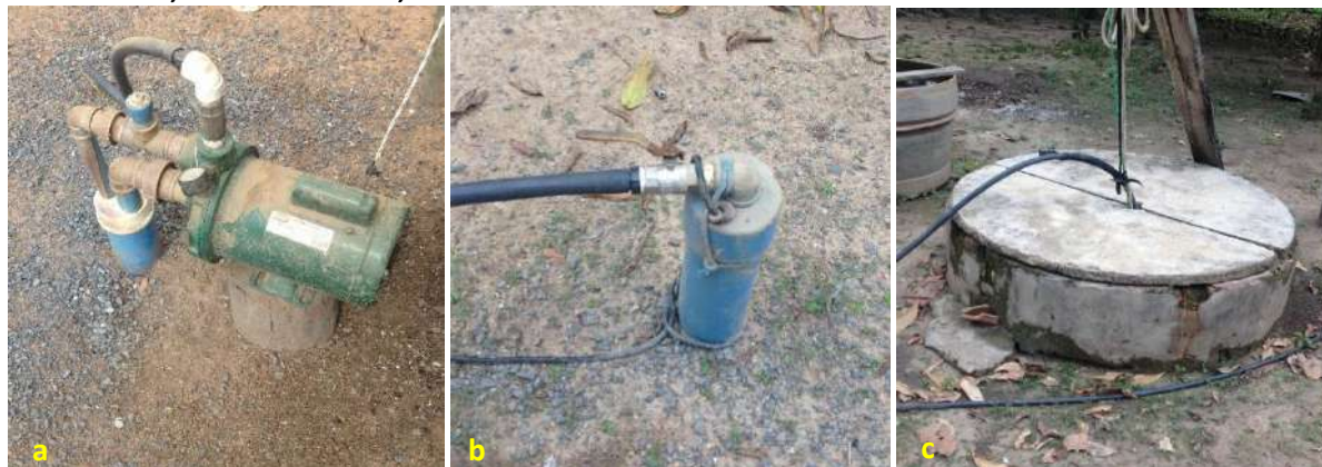
Foto 6.1 – Poço tubular raso (a), poço tubular profundo (b) e poço raso escavado (c), na Comunidade Cantoneiras, Nova Crixás-GO, 2018.
