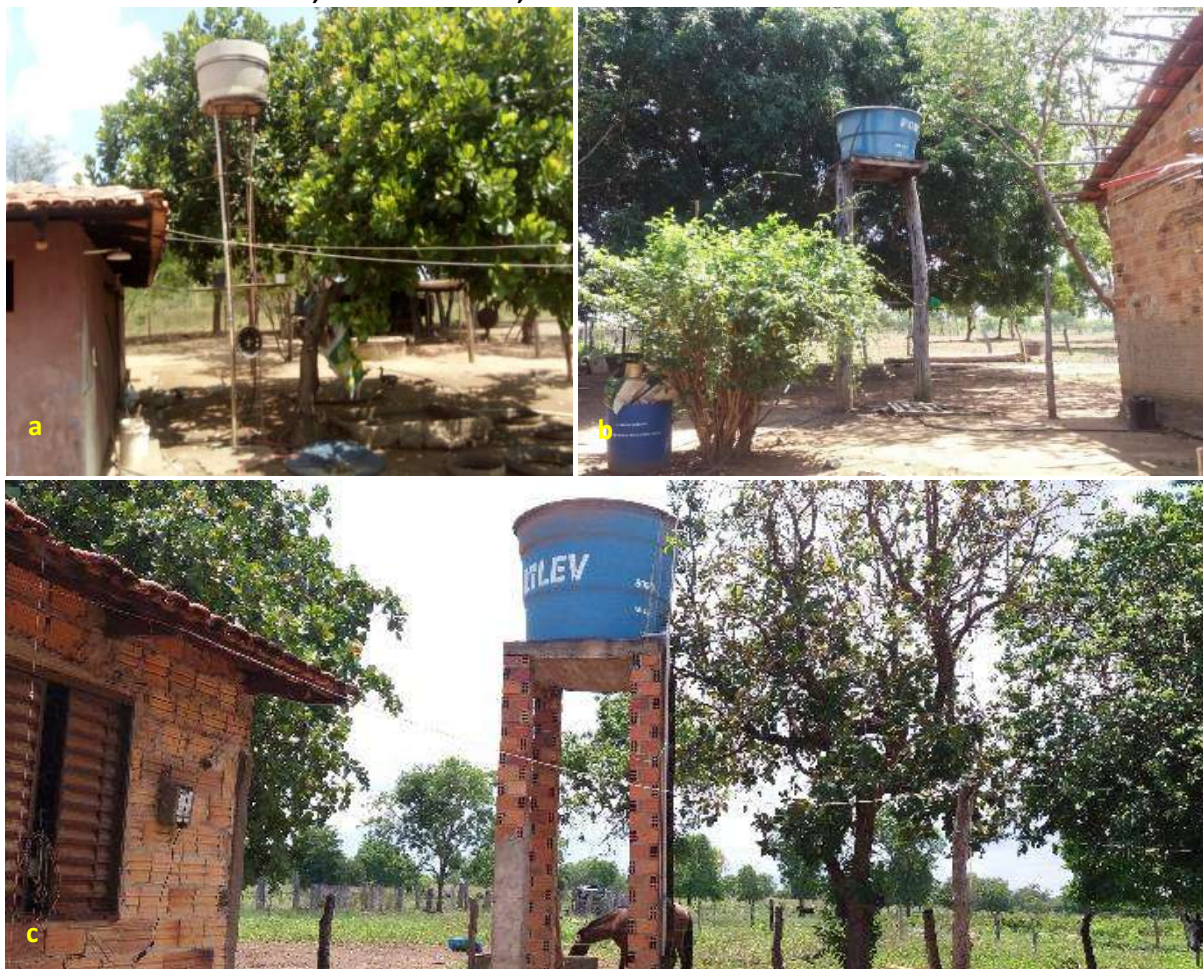
Foto 6.6 – Reservatório em fibrocimento, instalado sobre uma estrutura metálica (a), e reservatórios em fibra de vidro, sobre uma estrutura de madeira (b) e sobre uma estrutura em alvenaria (c), na Comunidade Cantoneiras, Nova Crixás-GO, 2018.
