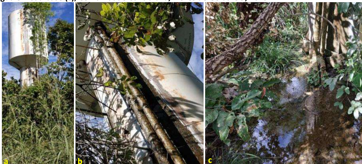
Foto 6.3 – Reservatório tipo taça (R1) (a) com formação de lodo em seu exterior (b) e acúmulo de água em sua base (c), Comunidade Canabrava, Flores de Goiás-GO, 2019.
