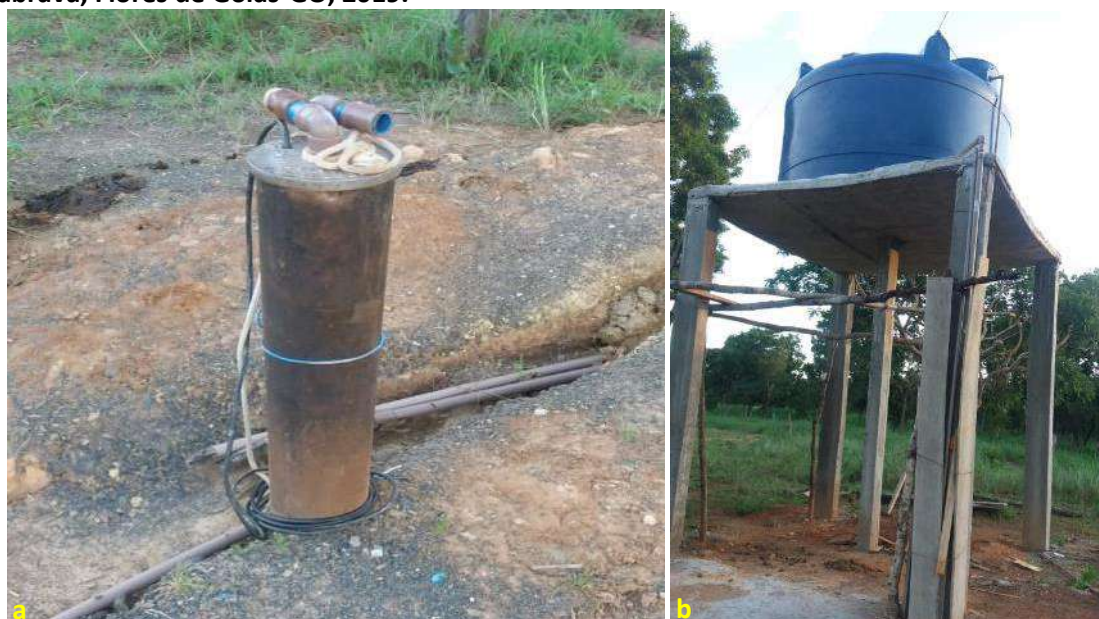
Foto 6.7 – Poço tubular profundo (a) e reservatório elevado (b) que abastece 11,90% da Comunidade Canabrava, Flores de Goiás-GO, 2019.
