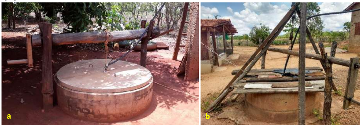
Foto 6.2 – Diferentes formas de tampar um poço raso escavado: com tampa de concreto (a) e com madeira e materiais improvisados (b), na Comunidade Campo Alegre, São Miguel do Araguaia-GO, 2018.
