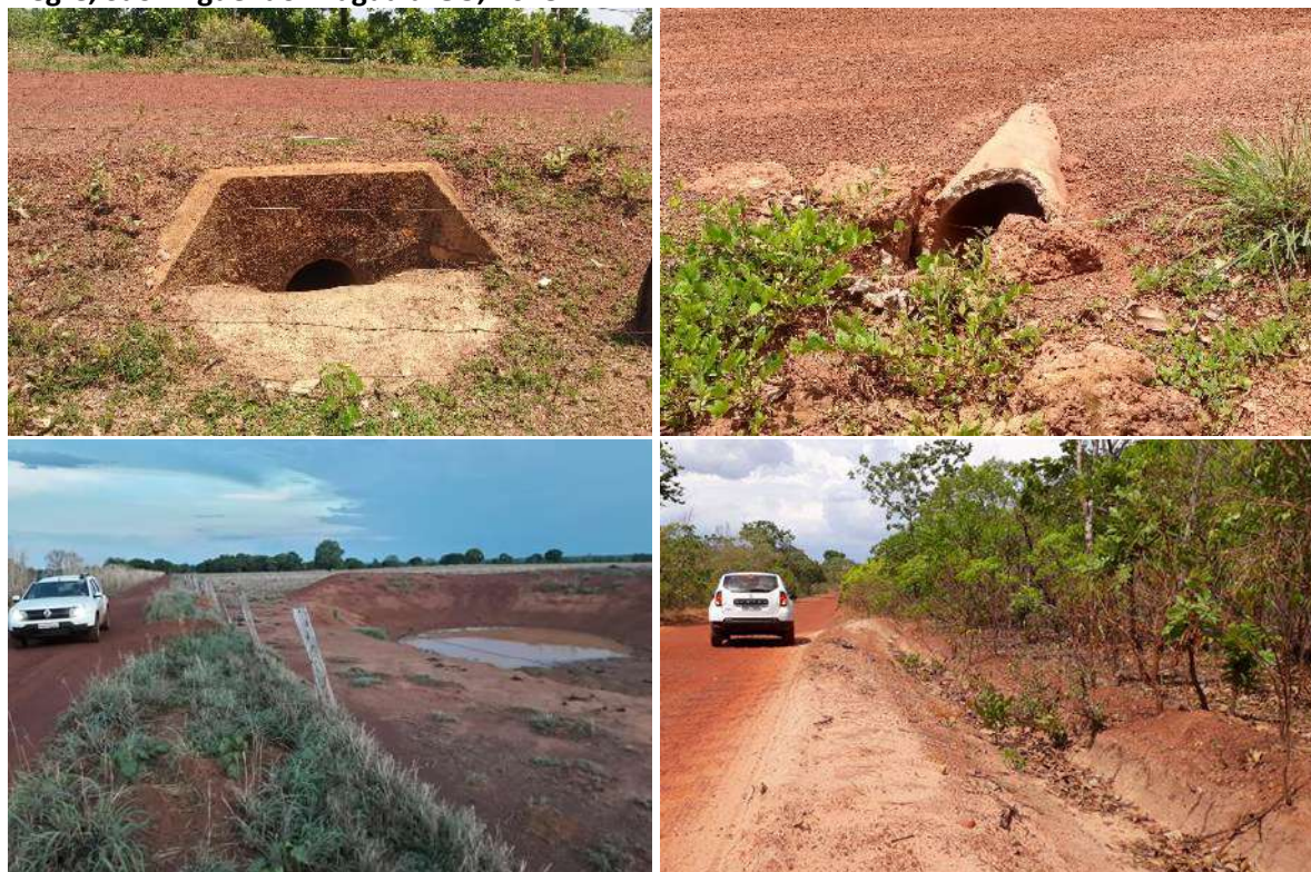
Foto 6.17 – Bueiro (a), (b), bacia de contenção (c) e valeta (d) na via de acesso à Comunidade Campo Alegre, São Miguel do Araguaia-GO, 2018.
