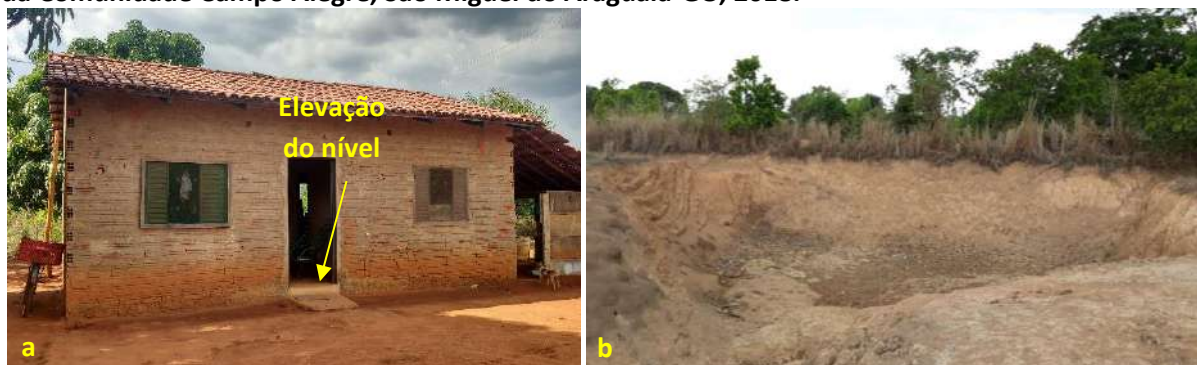
Foto 6.22 – Dispositivos de prevenção dos danos provocados pelas águas em residência (a) e lote (b) da Comunidade Campo Alegre, São Miguel do Araguaia-GO, 2018.
