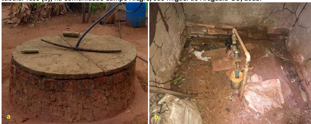
Foto 6.1 – Fontes de abastecimento de água utilizadas para ingestão: poço raso escavado(a) e poço tubular raso (b), na Comunidade Campo Alegre, São Miguel do Araguaia-GO, 2018.
