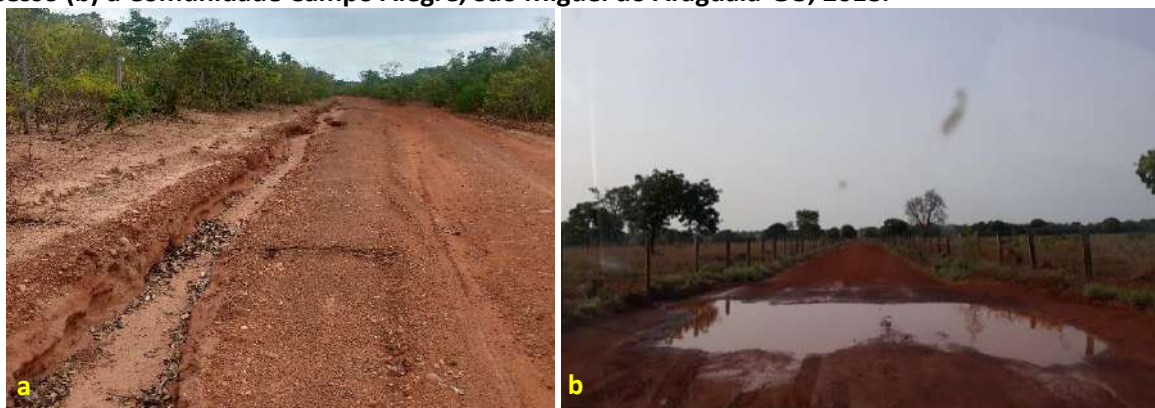
Foto 6.18 – Processos erosivos na margem da via de acesso (a) e ponto de alagamento na via de acesso (b) à Comunidade Campo Alegre, São Miguel do Araguaia-GO, 2018.
