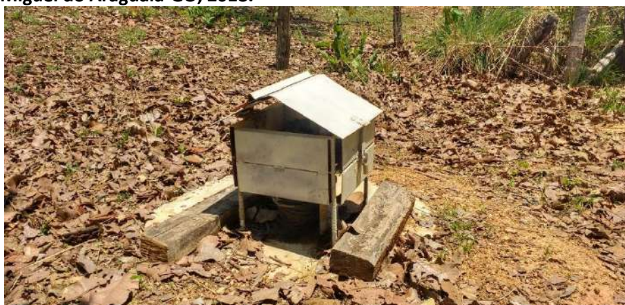
Foto 6.3 – Poço tubular profundo protegido e coberto em estrutura metálica, na Comunidade Campo Alegre, São Miguel do Araguaia-GO, 2018.
