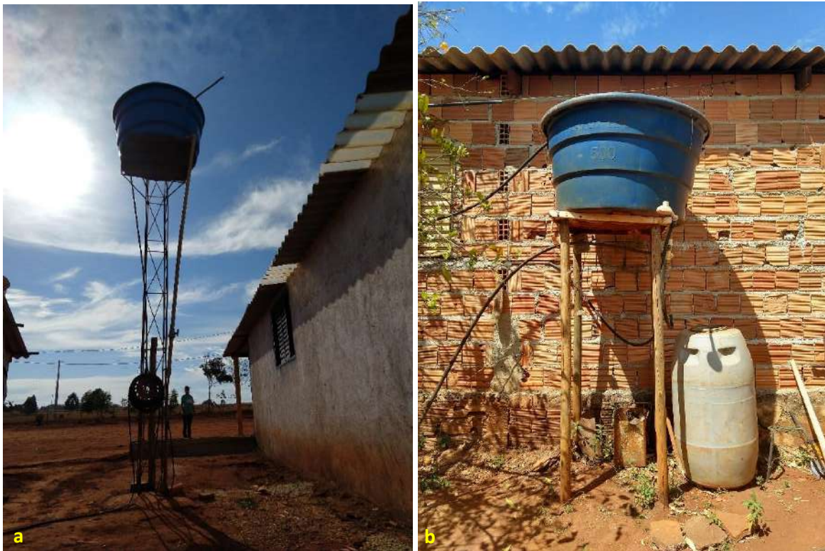
Foto 6.3 – Reservatórios domiciliares instalados sobre diferentes estruturas, sendo reservatórios de polietileno com extravasor e instalados sobre estrutura metálica (a) e de madeira (b), na Comunidade Buriti, Silvânia-GO, 2018.
